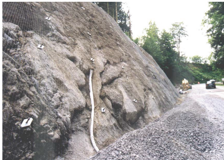
Tubería de drenaje para la recogida de la escorrentía de aguas
