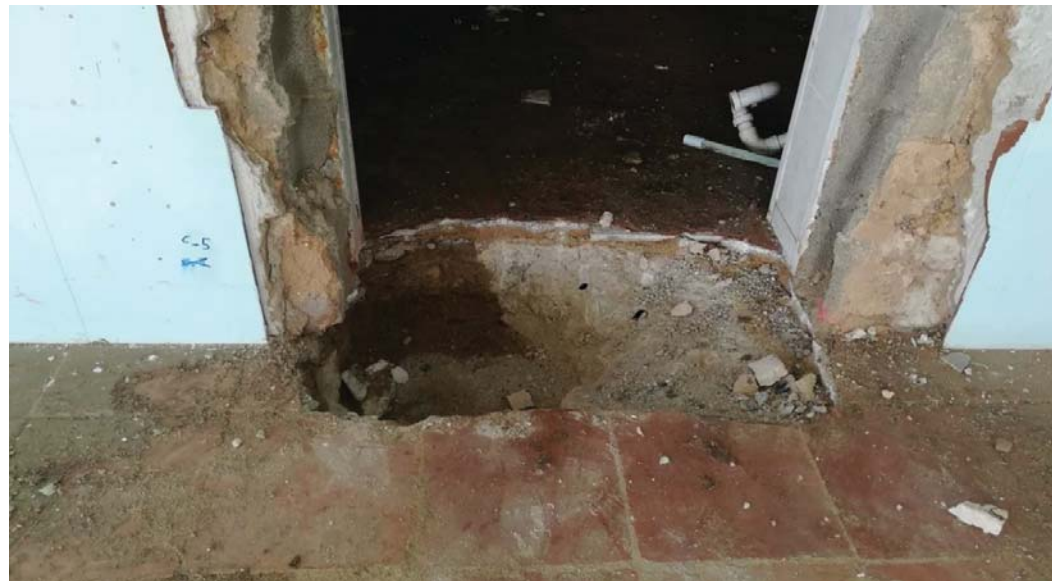
Fotografía 10. Restos de bloque de hormigón en hueco de pared (cata_C_5)
