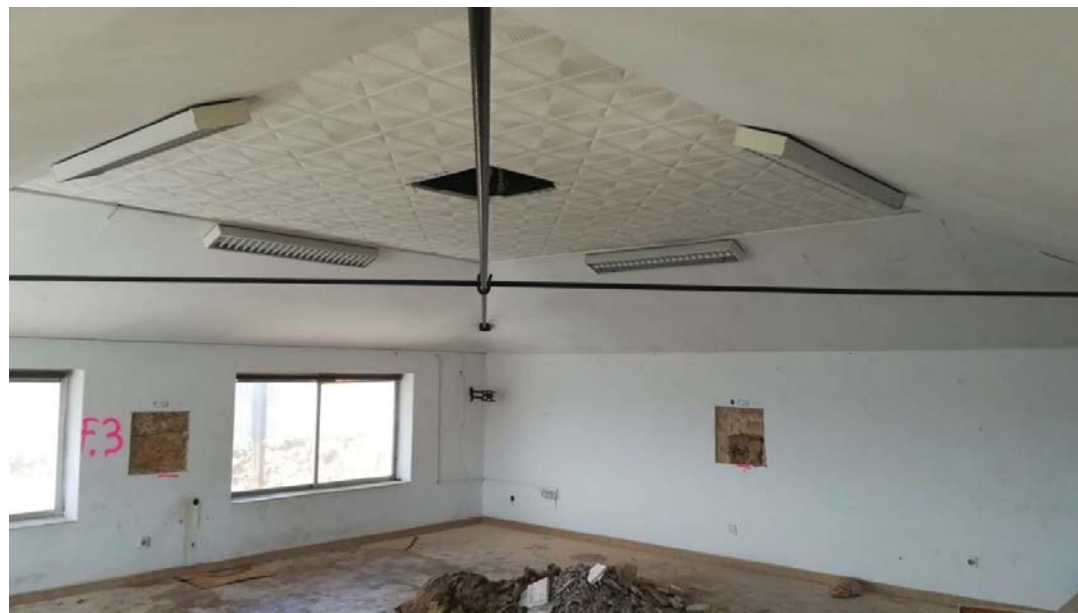
Tirantes sujeción cubierta
