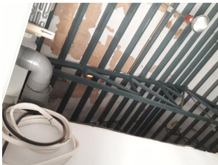
Imagen 14. Estado de la cubierta del almacén de la APB
