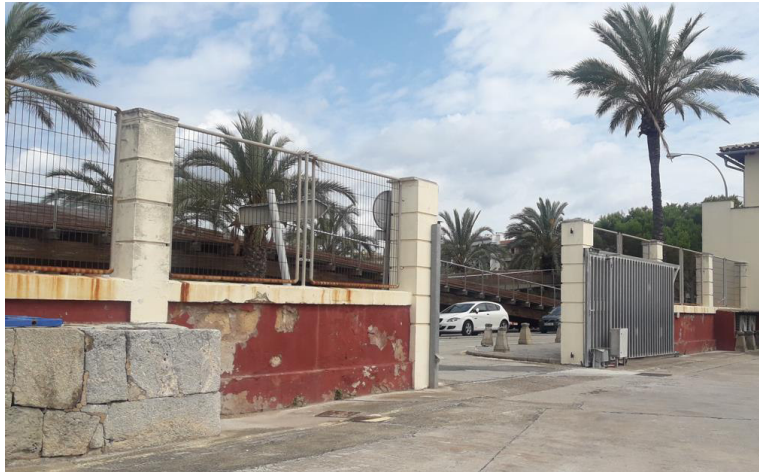
Imagen 2. Estado actual del cerramiento en el acceso a Cofradía
