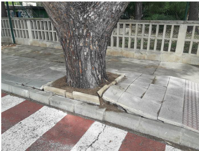
Imagen 6. Estado actual acera M. Ribera
