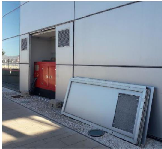
Imagen 16. Sala del grupo electrógeno de la E. Marítima de Alcúdia.
