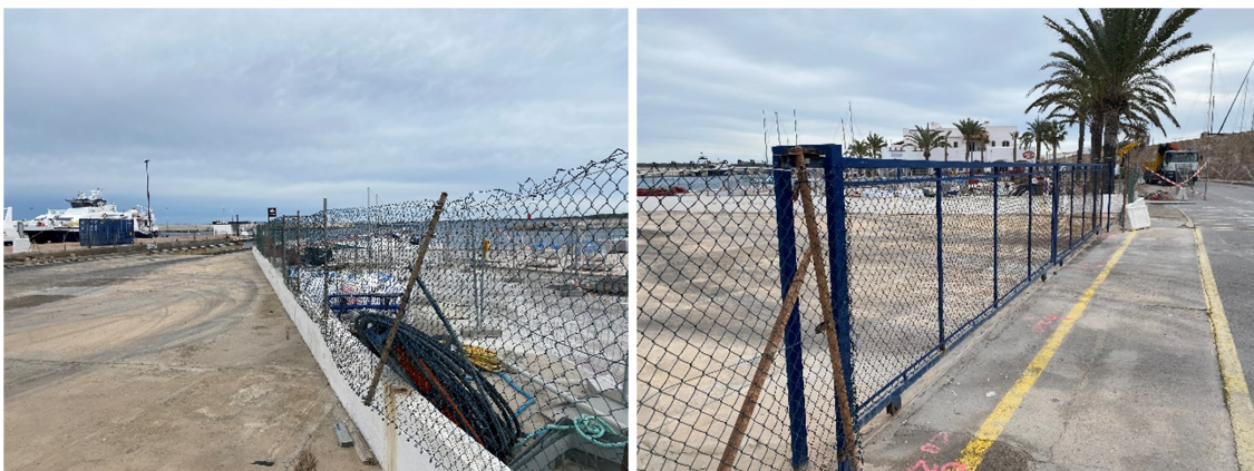
Ilustración 2 Estado actual del cerramiento de la zona de izado de embarcaciones.
