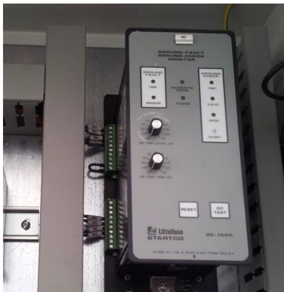
Figura 37. Ejemplo de relé de verificación de puesta a tierra
