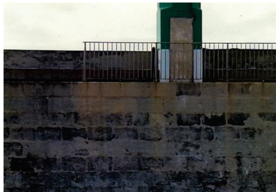
Estado actual barandillas Muelle Adosado
