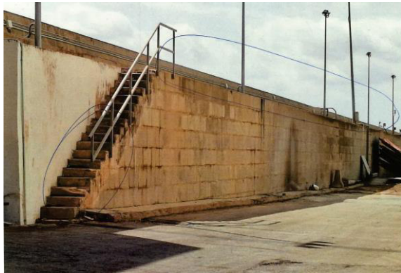
Estado actual escaleras de acceso Muelle Adosado
