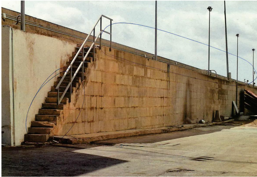
Figura 3. Estado actual arranque del dique de abrigo del Muelle Adosado
