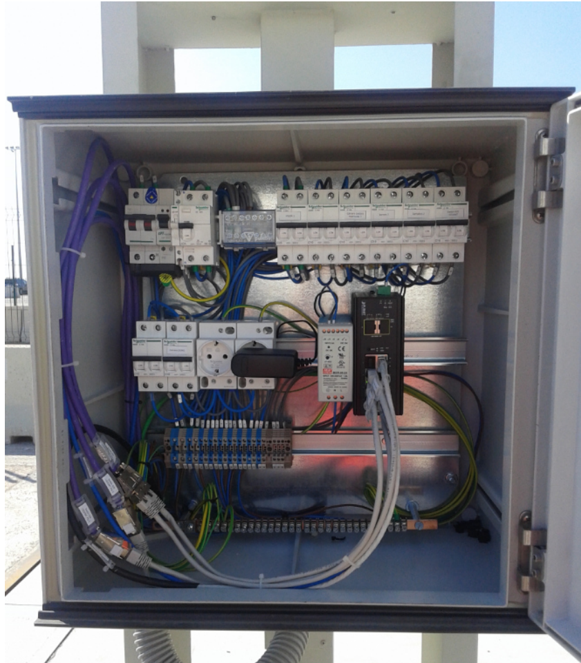
Cuadro eléctrico de una de las peanas de M. Comerciales
