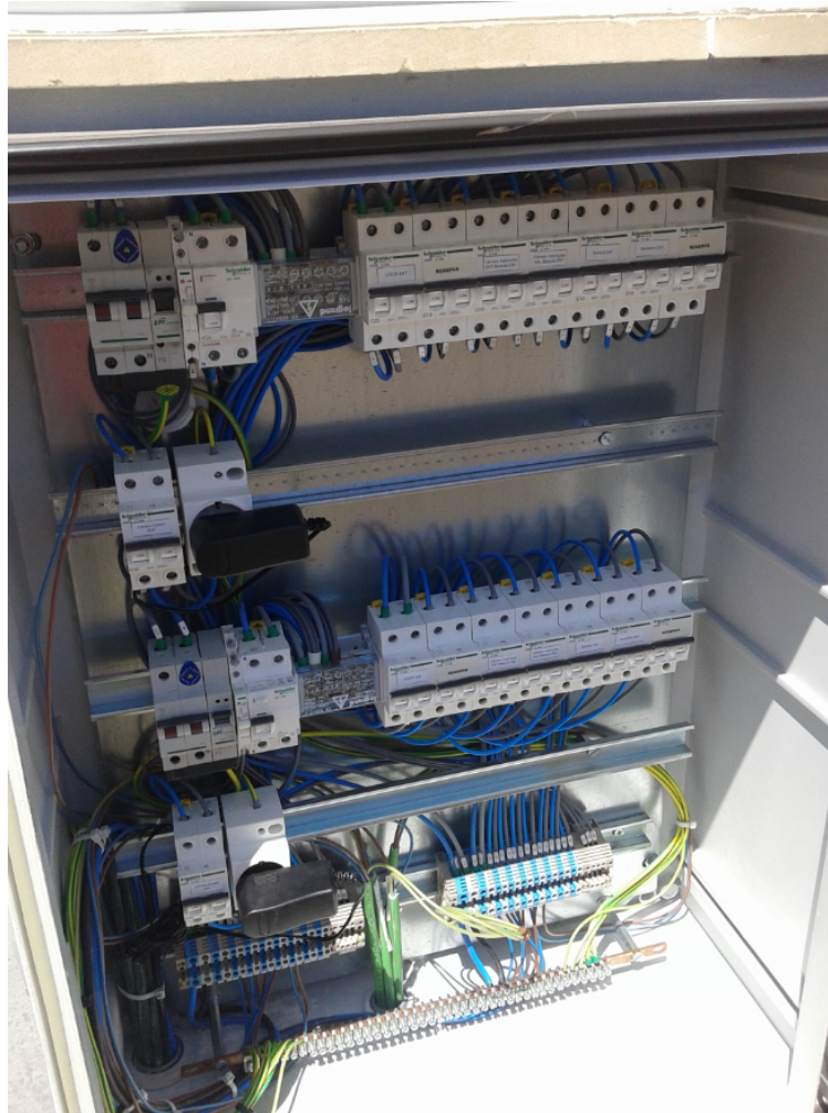
Cuadro de alimentación eléctrica de ambas básculas de Poniente
