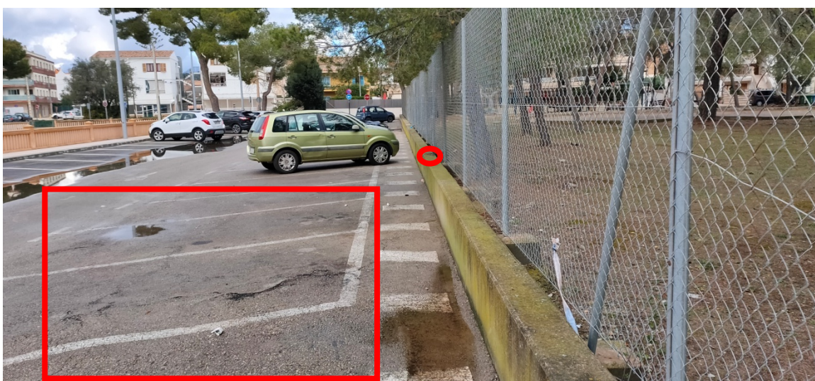
Figura 6.- Mal estado del asfalto en zona resaltada (fuera del ámbito del proyecto) y reparación puntual de murete corrido en buen estado en términos generales; los postes del vallado están anclados mediante mazacotas independientes y vistas detrás del muro. Acumulación de agua en línea de pintura de la banda en semibatería (fuera del ámbito del proyecto), antigua línea de bordillo; ausencia de ríola de recogida hacia aguas abajo (mar)
