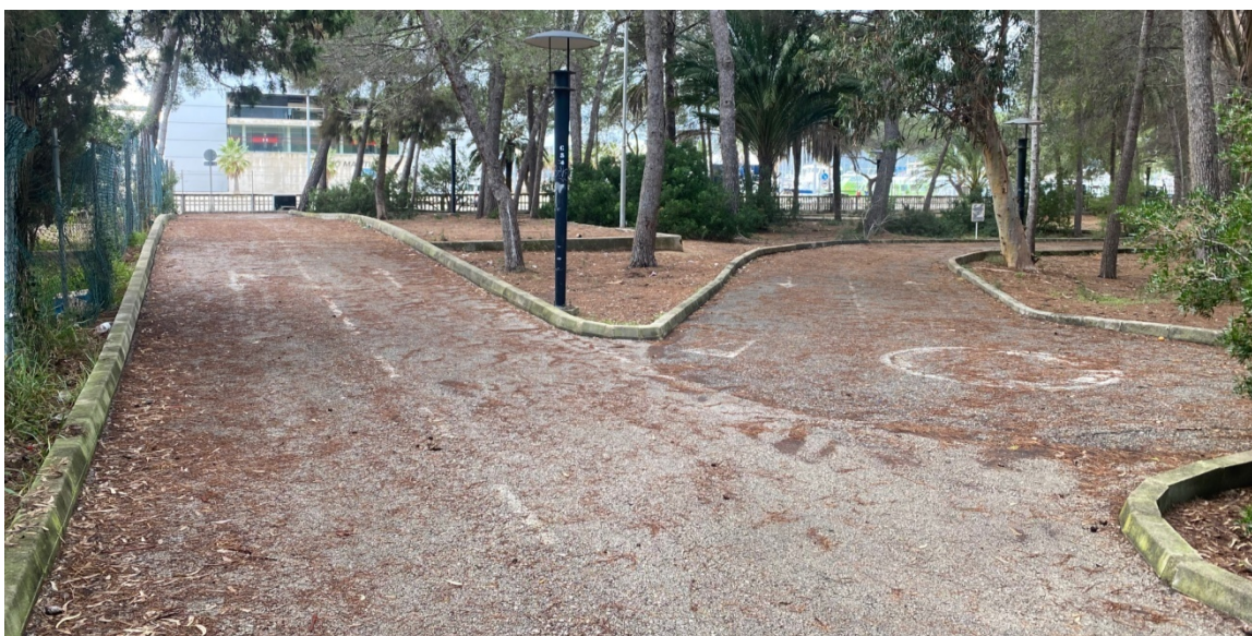
Figura 15.- Viales interiores des asfalto encintados con bordillo y señalización horizontal. Mucha hoja suelta. Vallado intermedio a la zona de la piscina (izquierda).
