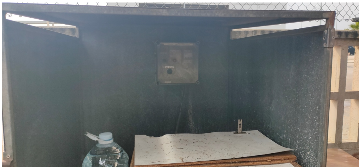
Figura 20.- Zoom del interior del cuadro de alumbrado donde se distinguen 3 elementos, uno de ellos tripolar y un contactor que permite el funcionamiento automático o manual de la instalación existente.
