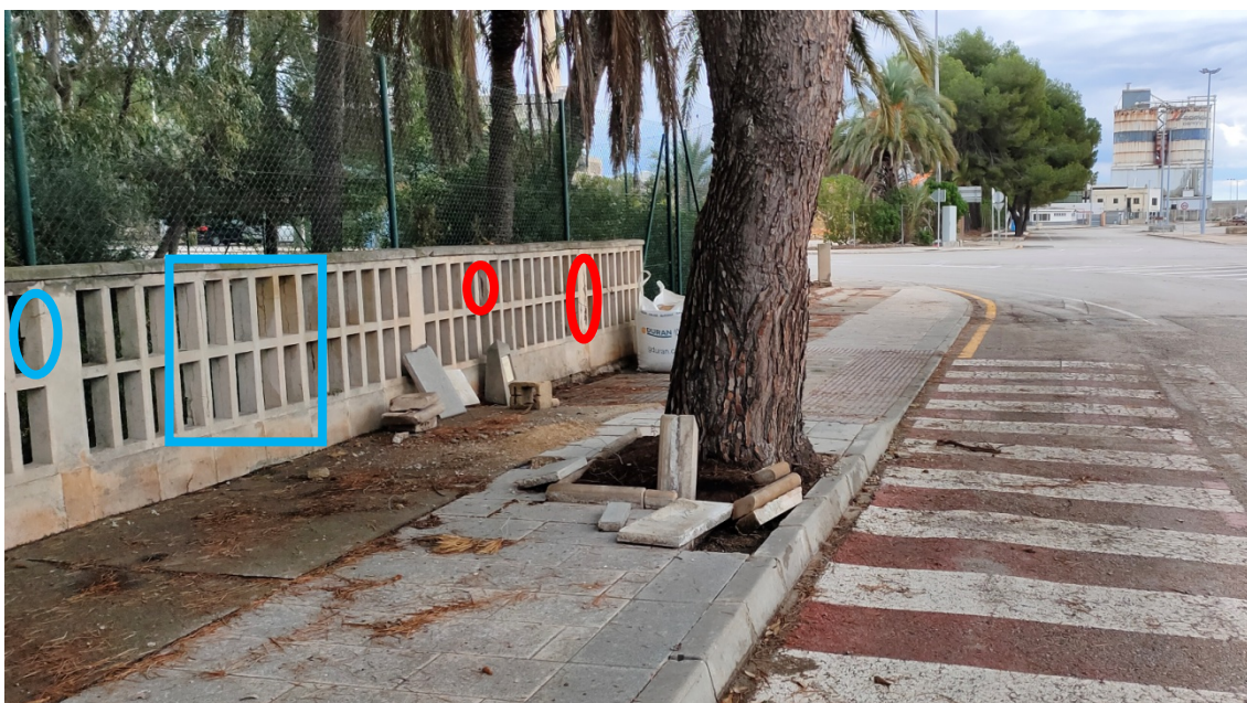
Figura 2.- Lateral sur, final de tramo junto al CCAA. Lesiones de muro y escombros.
