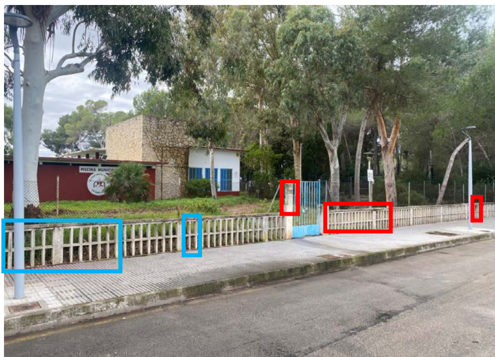
Figura 13.- Lesiones muro norte
