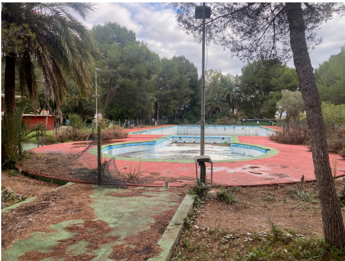
Figura 16.- Vista del vaso de la piscina. Lateral de la foto con reposición de vallado perimetral (postes y red), papelera rota, farola caída y residuos arbóreos.
