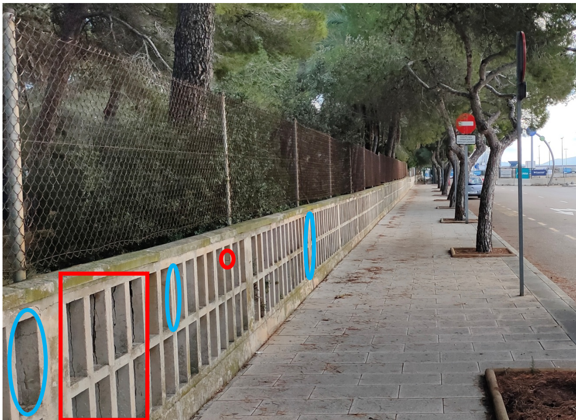
Figura 1.- Lateral sur frente a Estación Marítima. Lesiones de muro resaltadas en rojo (grietas visibles) y azul (fisuras distinguibles). Muro de hormigón armado en celosía sobre el que se anclan los postes del vallado de simple torsión.
