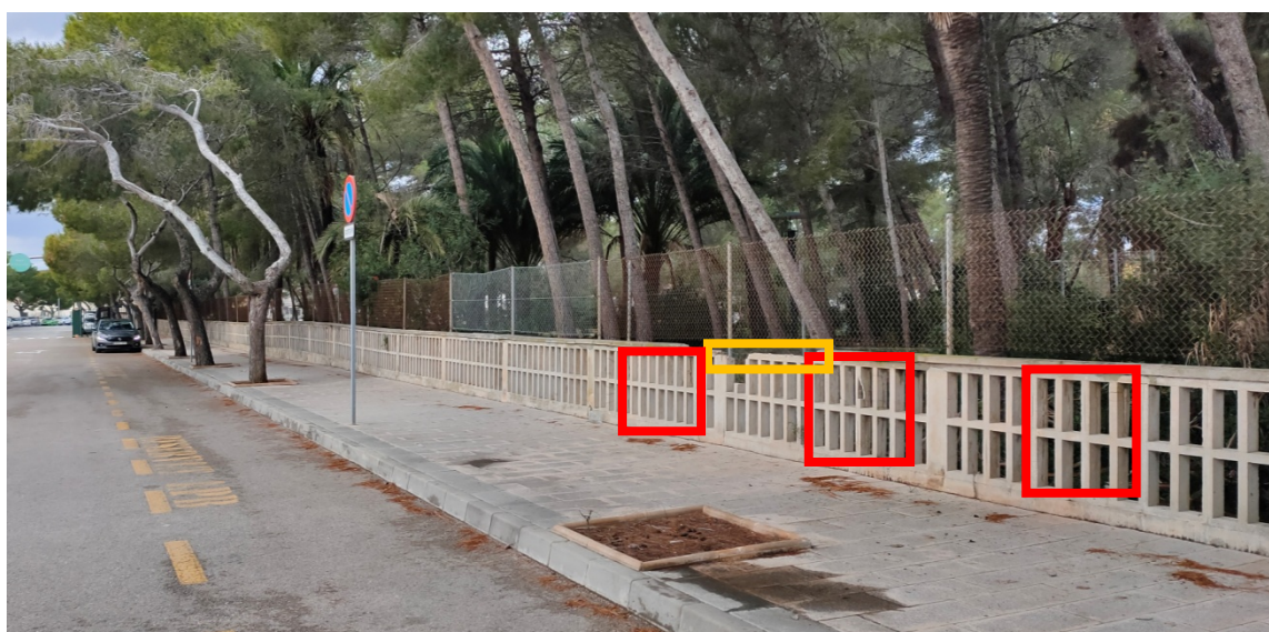
Figura 4.- Lateral sur, frente a Estación Marítima. Lesiones de muro, incluso falta coronación del mismo en un tramo (naranja).
