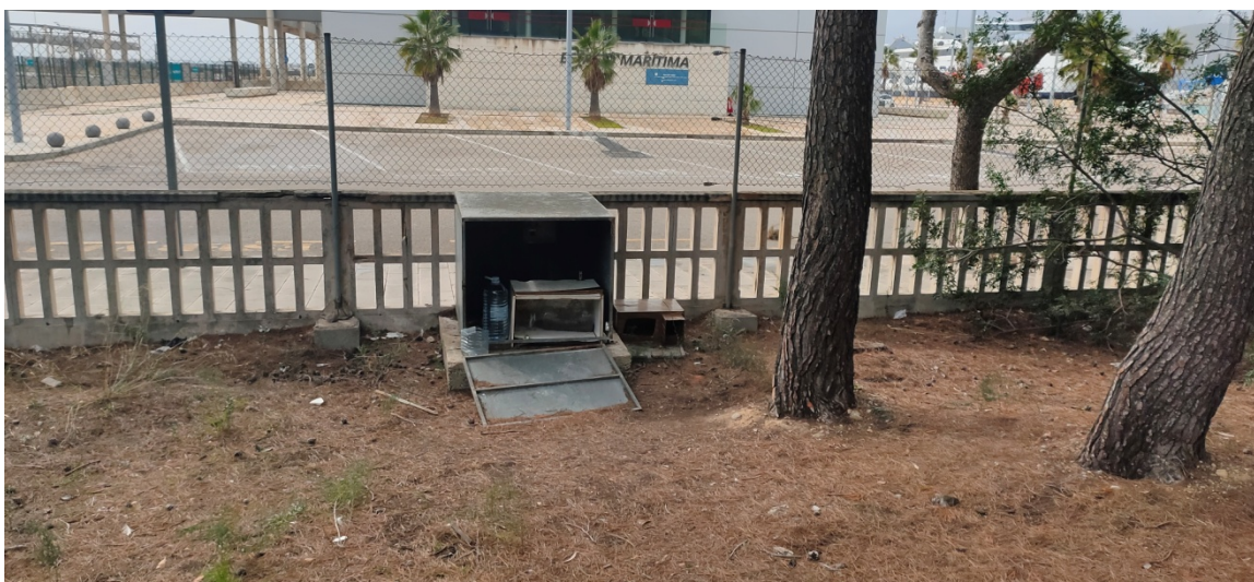
Figura 19.- Estado actual del cuadro de alumbrado. Armario metálico no estanco en mal estado sobre peana de hormigón.
