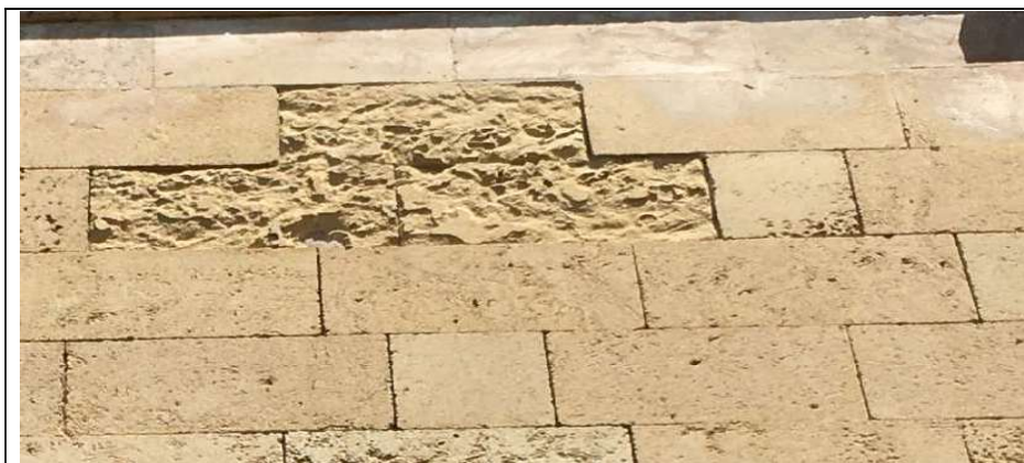
Piezas de marés afectadas por desconchadura
