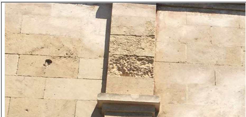
Piezas afectadas por alveolización
