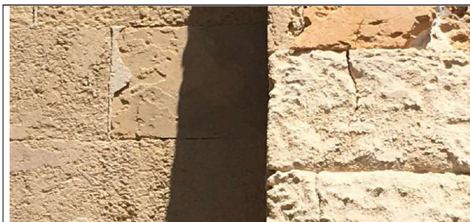
Pieza de marés afectada por desplazación
