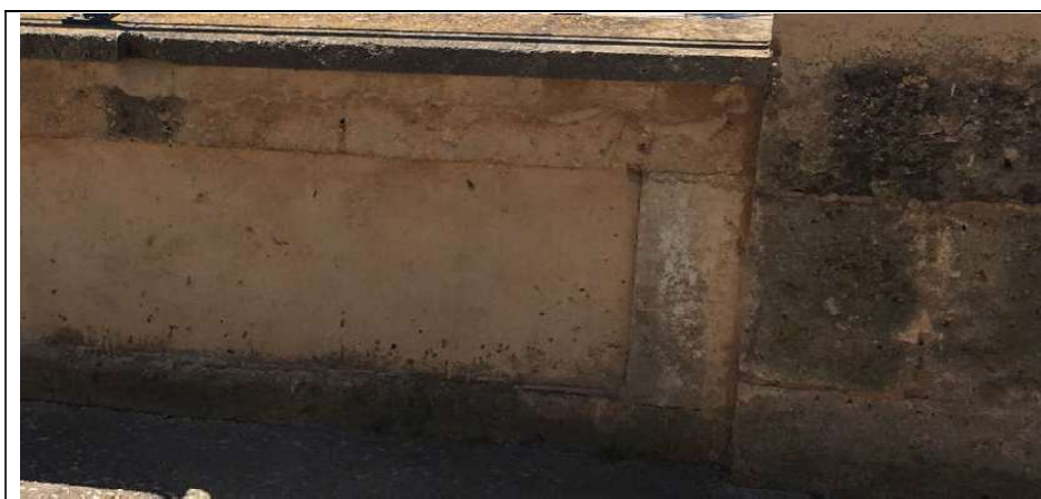
Zonas de afectación de costra biològica (pilastra, zones inferiors muro y fiola de remate superior)
