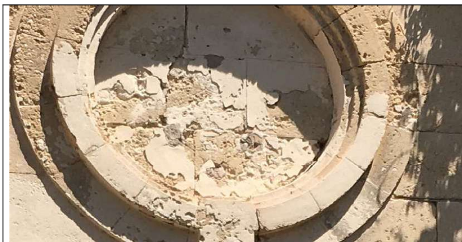
Desprendimiento del mortero de reparación
