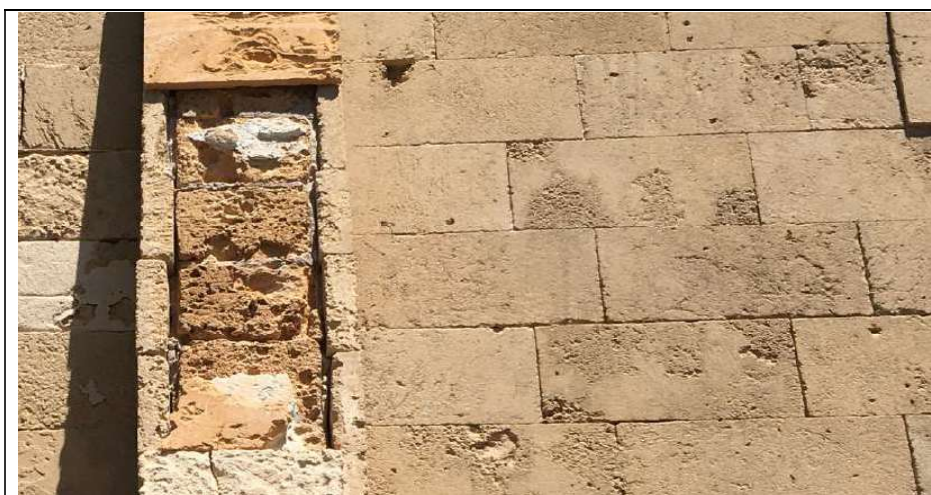
Faltas de aplacado en pilastra nº 3
