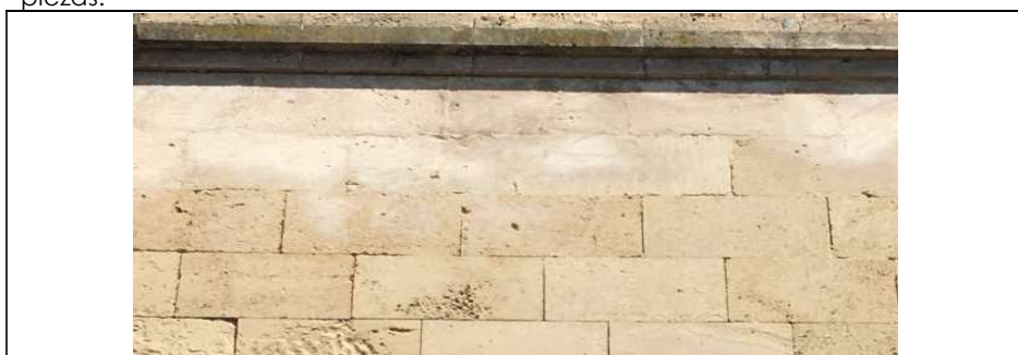
Zonas de afectación por lechada de mortero
