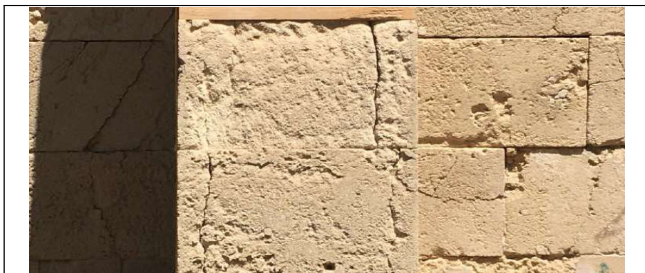
Fisuras de diferente orientación en el aplacado
