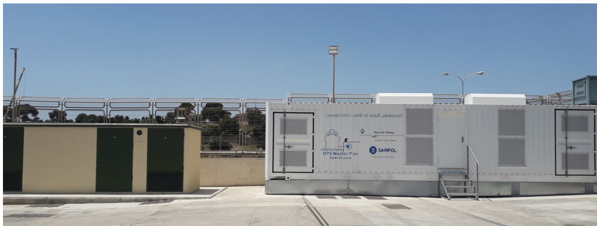
Centro de Transformación y Subestación OPS
