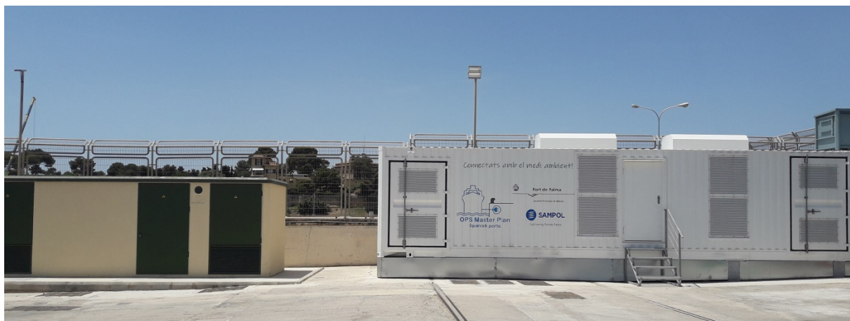
Centro de Transformación y Subestación OPS
