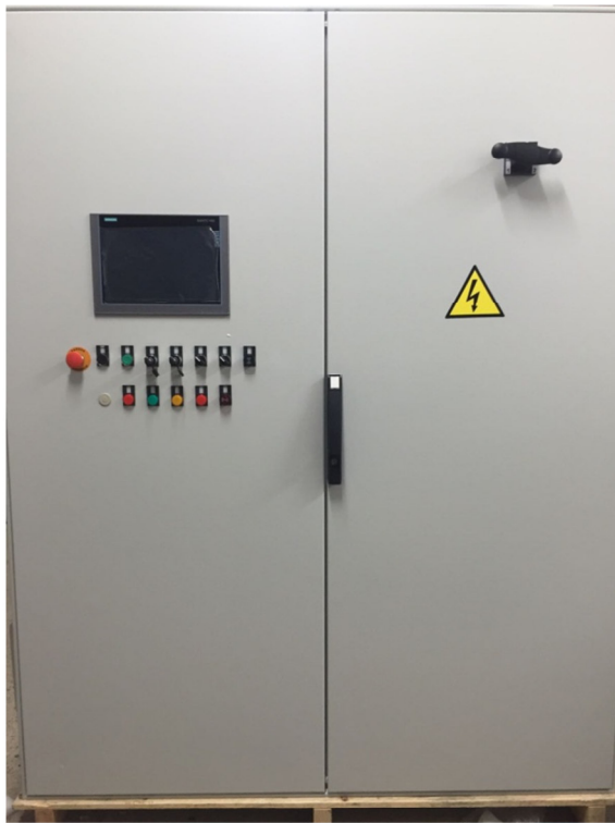
Ilustración 9: exterior del cuadro eléctrico principal
