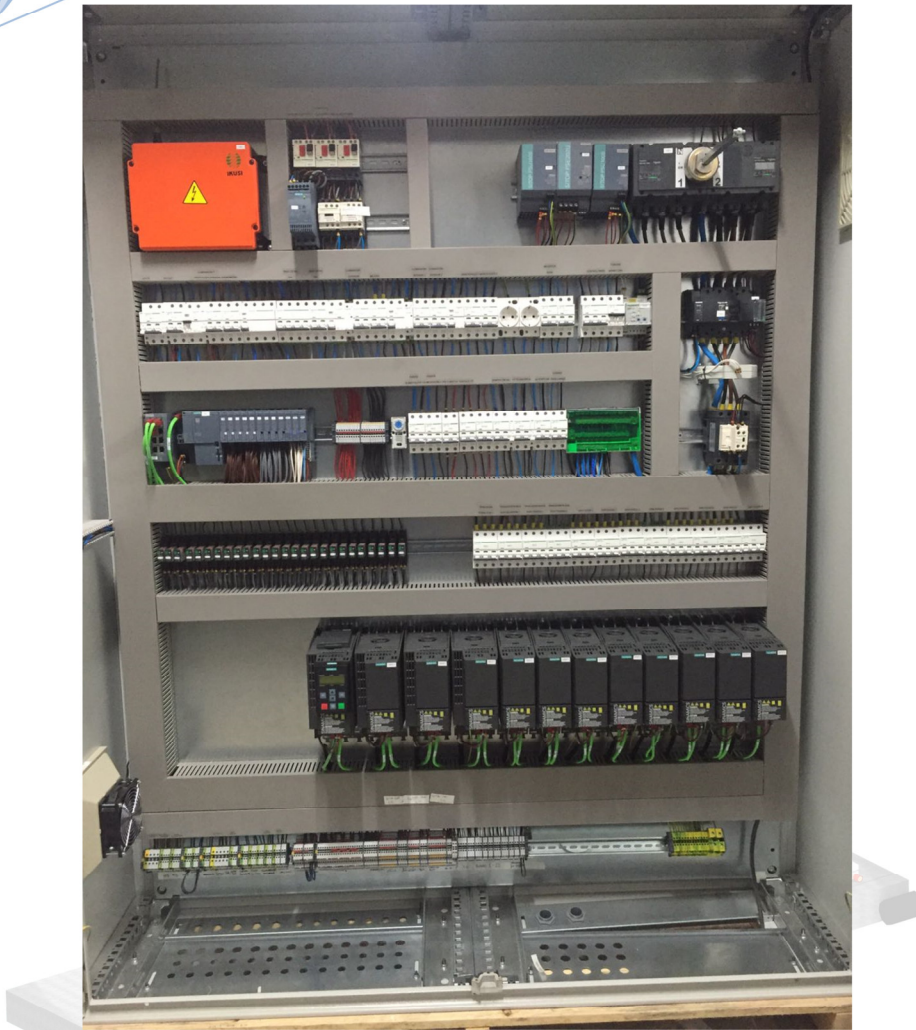
Ilustración 10: interior cuadro eléctrico
