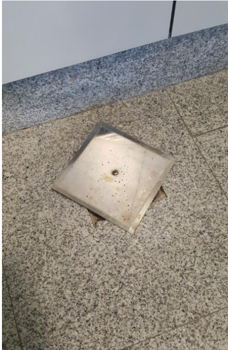
Fotografía 39. Baño Estación Marítima 2, Zona Planta baja – Recogida equipajes. Detalle de registro sin cerrar por el que se filtran olores.
