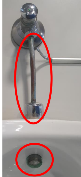
Fotografía 32. Baño Estación Marítima 2, Zona Planta baja – Recogida equipajes. Detalle de oxidación en urinarios.
