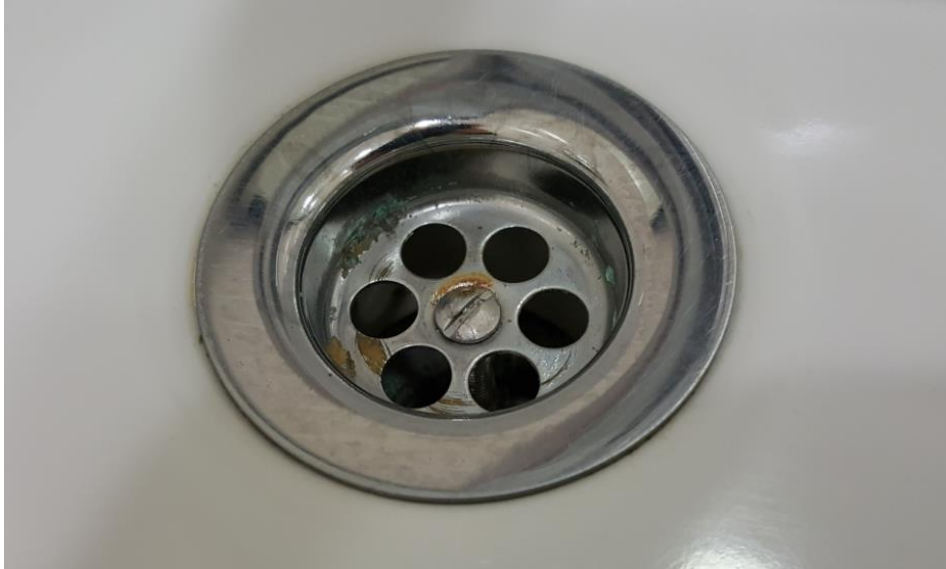
Fotografía 126. Baño Estación Marítima 4, Baños planta baja – Mujeres. Detalle de oxidación moderada en grifería
