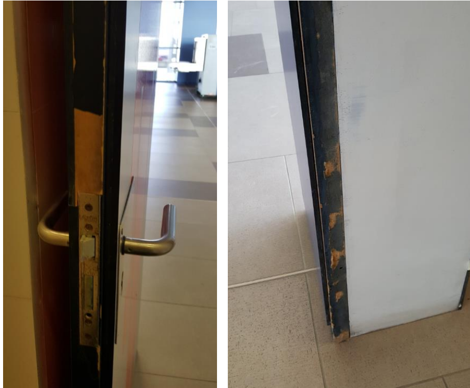
Fotografías 123, 124. Baño Estación Marítima 4, Baños planta baja – Hombres. Detalle del estado de puerta principal
