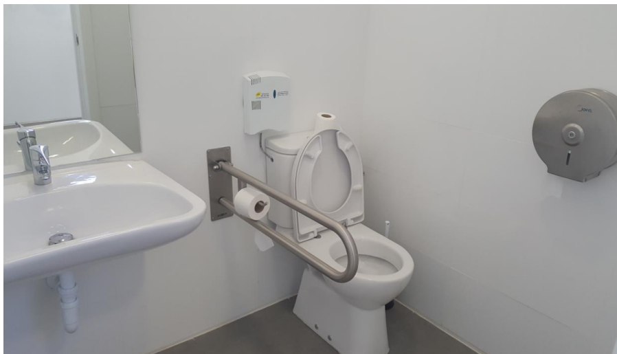
Fotografía 3. Baño Estación Marítima 1, Zona Duty Free, Caballeros. Vista general servicio movilidad reducida.
