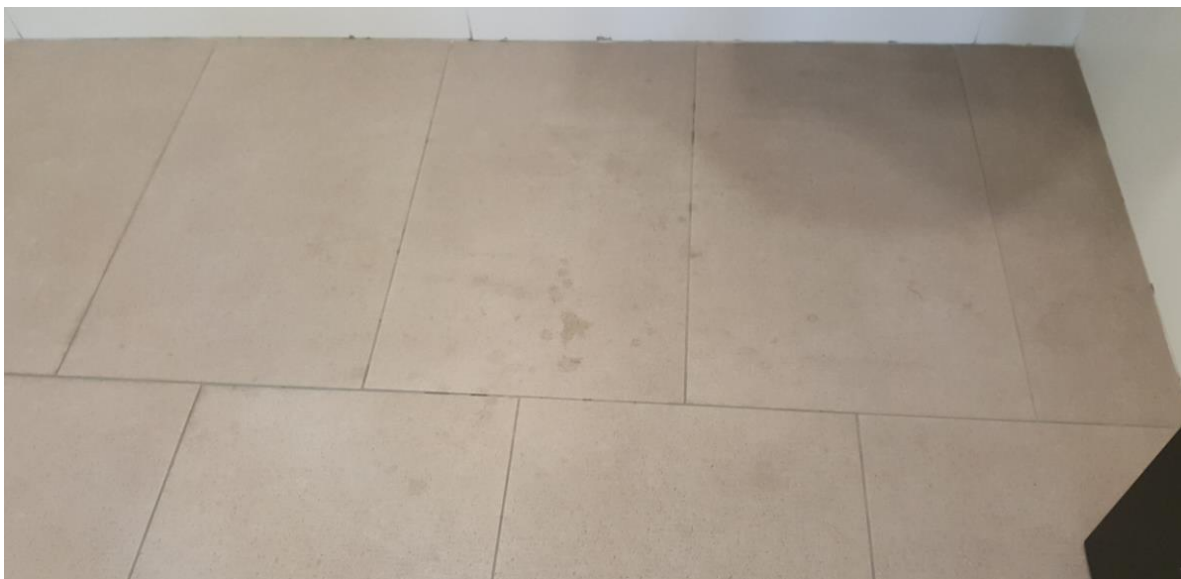
Fotografía 133. Baño Estación Marítima 4, Baños planta alta – Movilidad Reducida. Detalle de manchas en suelos que no se van con limpieza.
