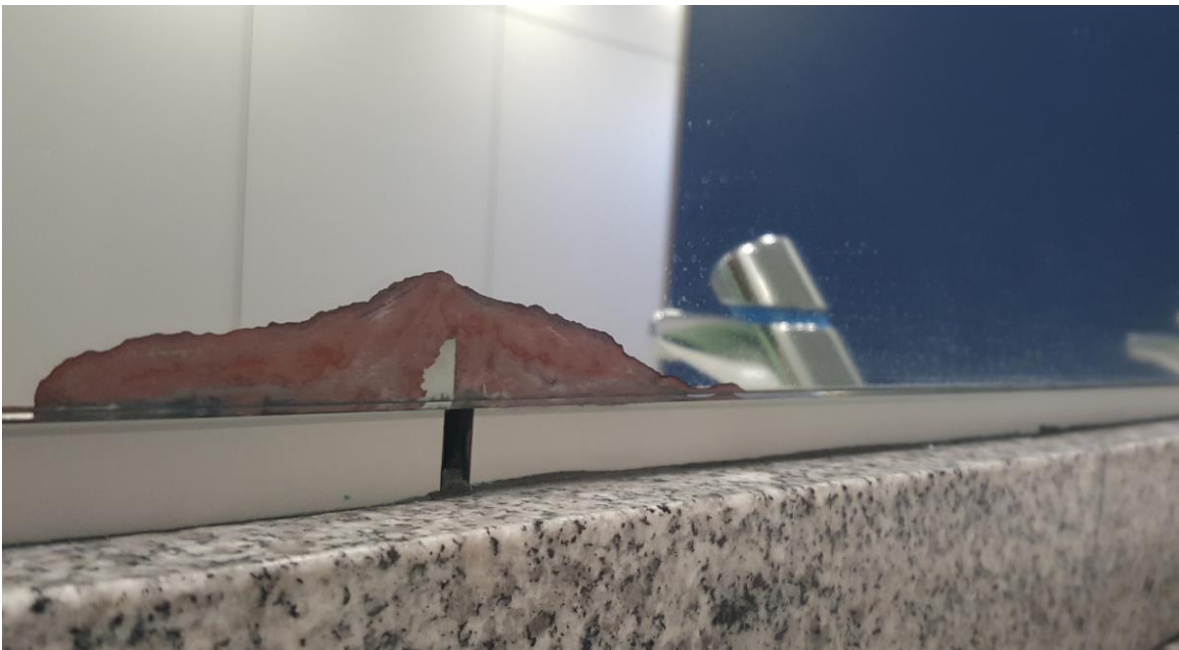
Fotografía 24. Baño Estación Marítima 2, Zona Planta baja – Cafetería, Mujeres. Detalle de deterioro en espejo.
