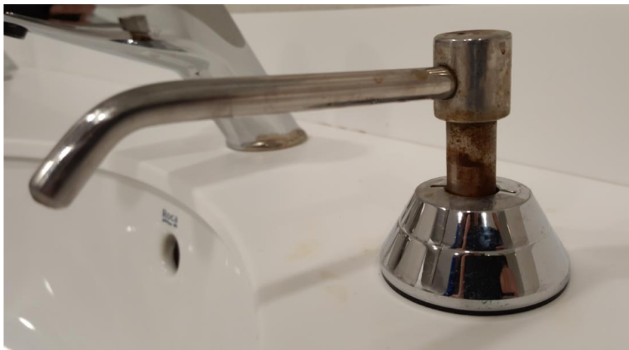
Fotografía 178. Baño Estación Marítima 6, Baños control de seguridad – Hombres. Detalle de oxidación en jabonera
