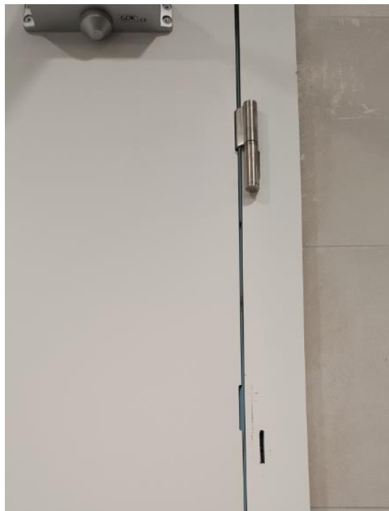
Fotografía 173. Baño Estación Marítima 6, Baños Entrada – Mujeres. Falta de bisagra en puerta principal
