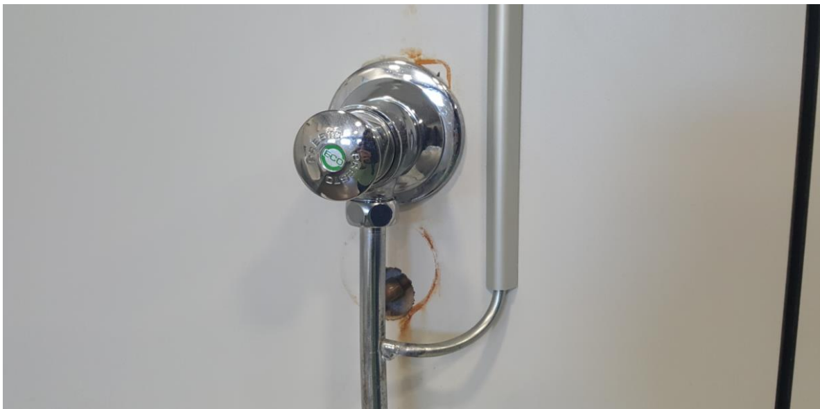
Fotografía 55. Baño Estación Marítima 2, Zona Planta entresuelo – Duty Free. Detalle de marcas en revestimiento de pared.
