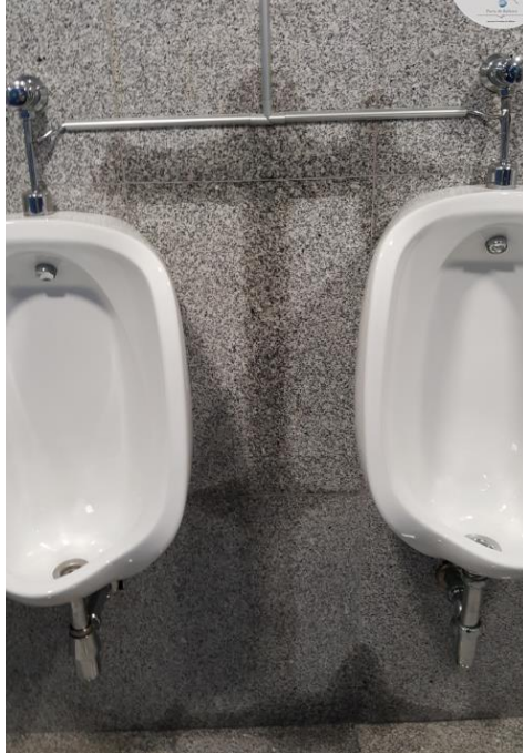
Fotografía 113. Baño Estación Marítima 3, Zona Planta alta – Embarque (Hombres). Detalle de paredes zona urinarios
