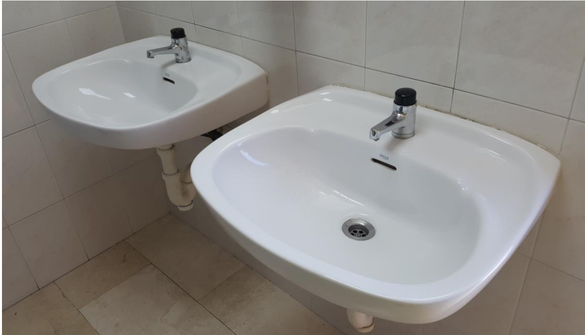
Fotografía 160. Baño Estación Marítima 5, Baños planta alta – Mujeres. Detalle del estado de lavabos, algo despegados, y del sistema de grifería (no funcionan correctamente).
