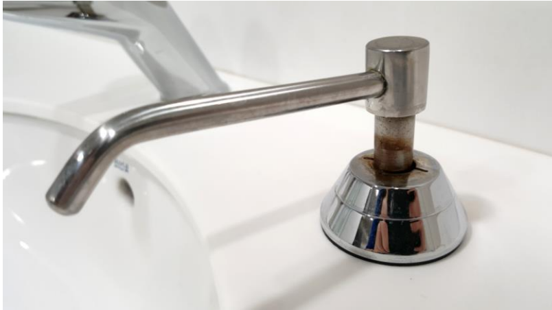
Fotografía 169. Baño Estación Marítima 6, Baños Entrada – Hombres. Detalle de oxidación en jabonera
