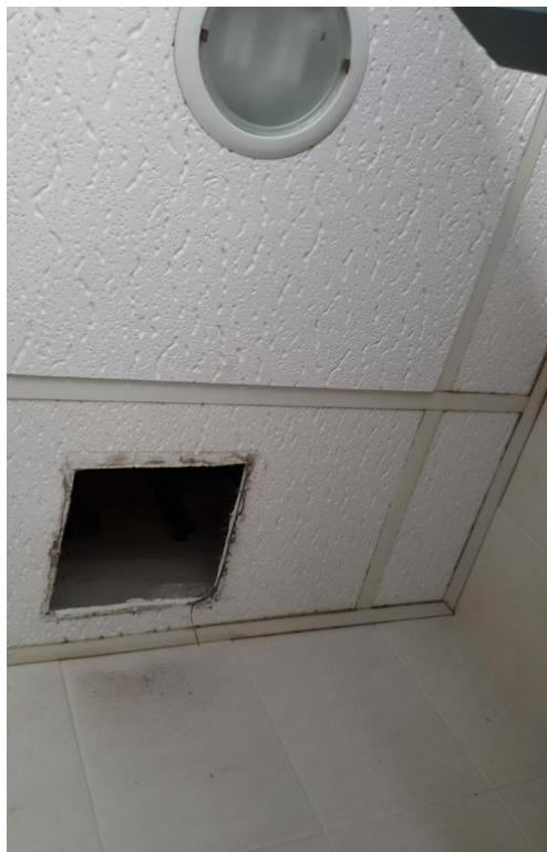
Fotografía 168. Baño Estación Marítima 5, Baños planta alta – Mujeres. Detalle de agujero, a través del que se filtran malos olores continuamente.
