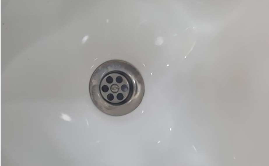
Fotografía 9. Baño Estación Marítima 2, Zona Planta baja – Cafetería, Caballeros. Detalle de grifería en desagües de lavabos (oxidación moderada).
