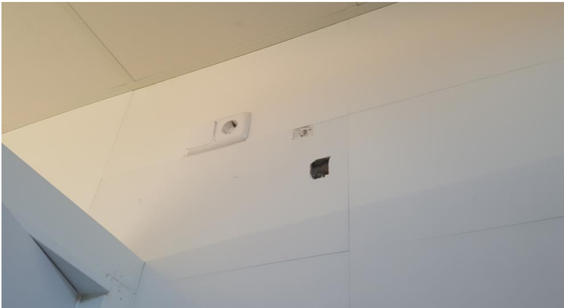
Fotografía 6. Baño Estación Marítima 1, Zona Duty Free, Señoras. Falta de elementos.
