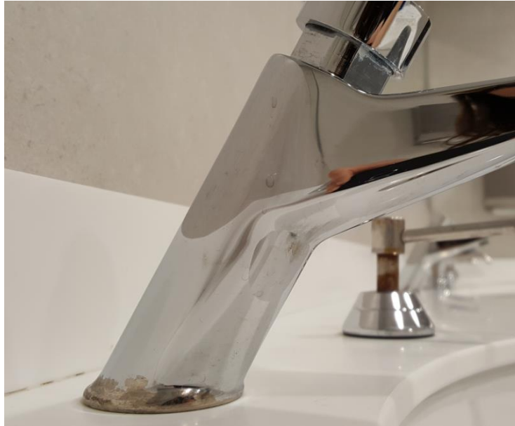
Fotografía 177. Baño Estación Marítima 6, Baños control de seguridad – Hombres. Detalle de oxidación en grifería.
