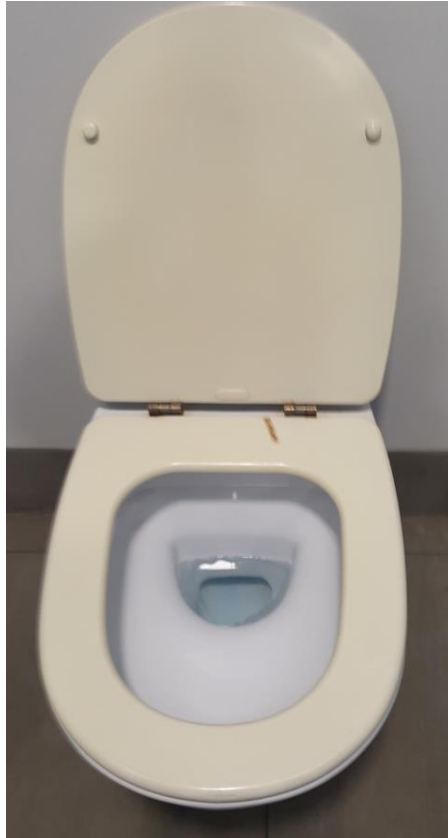
Fotografía 52. Baño Estación Marítima 2, Zona Planta entresuelo – Duty Free. Tapas de WC en mal estado.
