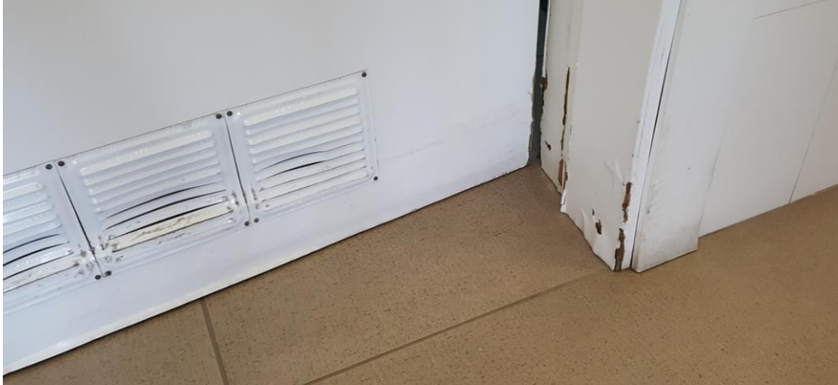
Fotografía 130. Baño Estación Marítima 4, Baños planta baja – Movilidad Reducida. Detalle de rejillas golpeadas y marco de puerta rozado.
