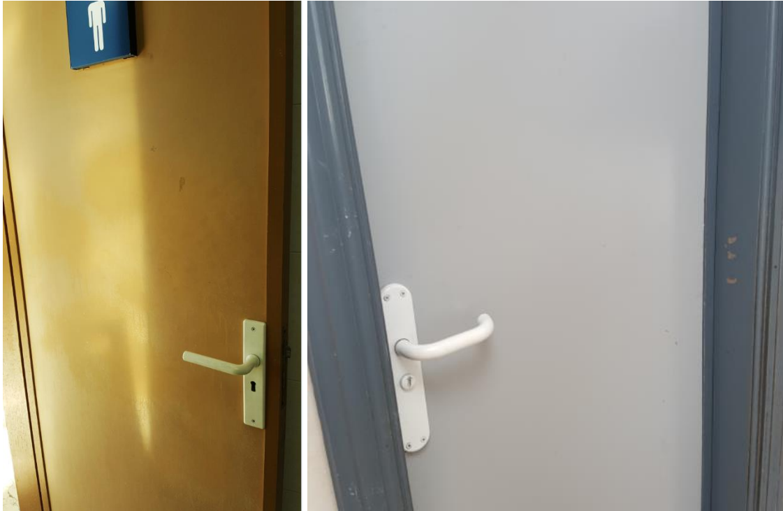
Fotografías 157, 158. Baño Estación Marítima 5, Baños planta alta – Hombres. Detalle de puertas con manchas y zonas desconchadas o rozadas
