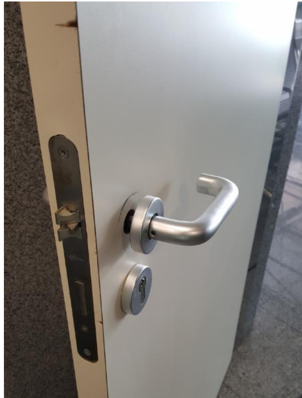
Fotografía 120. Baño Estación Marítima 3, Zona Planta alta – Embarque (Mujeres). Detalle de manilla suelta y rozaduras en puerta
