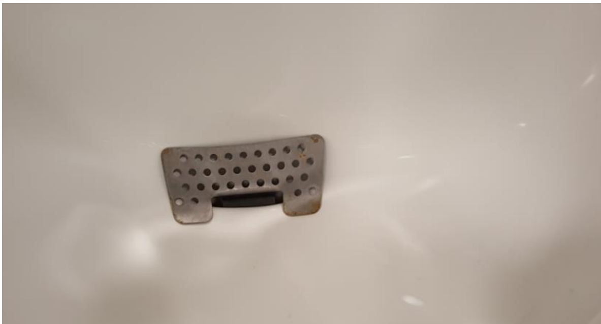
Fotografía 131. Baño Estación Marítima 4, Baños planta alta – Hombres. Detalle de rejillas urinarios oxidadas
