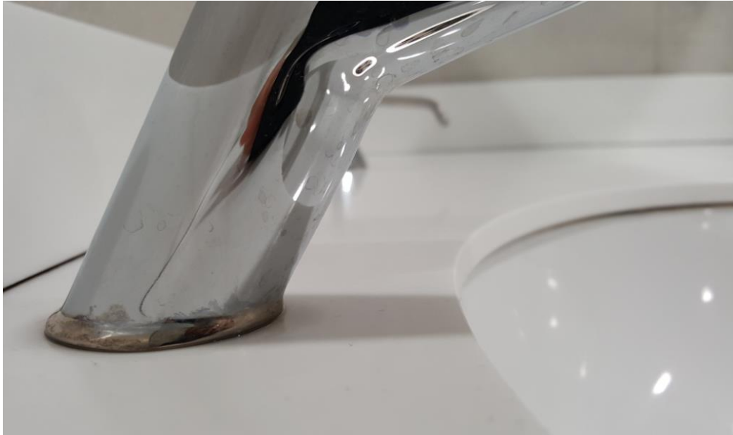
Fotografía 179. Baño Estación Marítima 6, Baños embarque – Hombres. Detalle de oxidación en grifería
