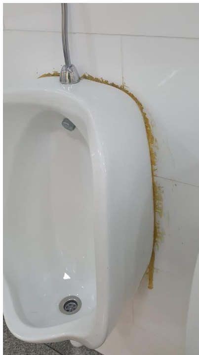
Fotografía 17. Baño Estación Marítima 2, Zona Planta baja – Cafetería, Caballeros. Detalle de pared en urinario.
