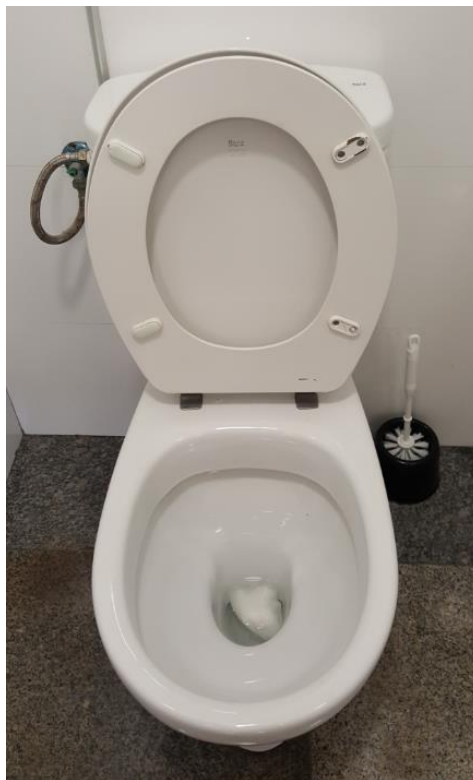
Fotografía 73. Baño Estación Marítima 3, Zona Planta baja – Hall (Hombres). Estado tapa inodoro
