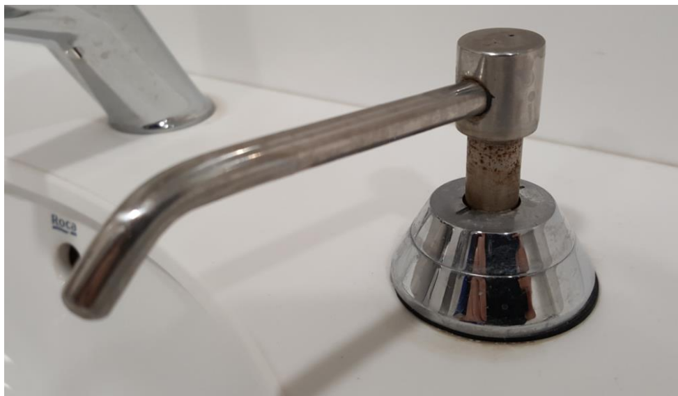
Fotografía 176. Baño Estación Marítima 6, Baños control de seguridad – Hombres. Detalle de oxidación en jabonera
