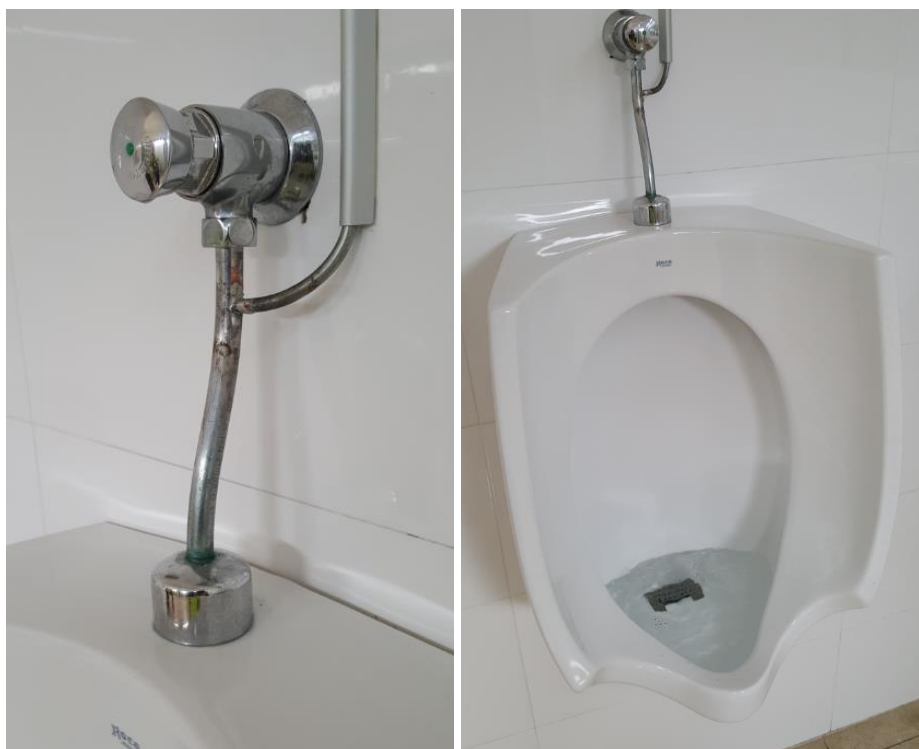
Fotografías 137, 138. Baño Estación Marítima 5, Baños planta baja – Hombres. Detalle de elementos metalizados oxidados en urinarios, y urinario embosado.
