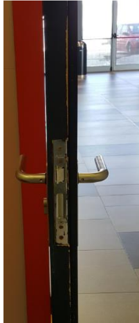
Fotografía 128. Baño Estación Marítima 4, Baños planta baja – Mujeres. Detalle de puerta y roces.
