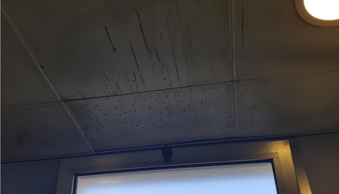
Fotografía 25. Baño Estación Marítima 2, Zona Planta baja – Cafetería, Mujeres. Detalle de deterioro en placas de techo, especialmente en las cercanas a ventanas.
