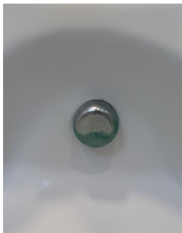
Fotografía 53. Baño Estación Marítima 2, Zona Planta entresuelo – Duty Free. Detalle de urinario con signos de oxidación y envejecimiento en elementos metálicos.
