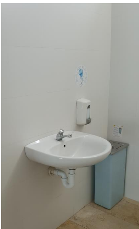
Fotografías 147. Baño Estación Marítima 5, Baños planta baja – Movilidad reducida mujeres. Detalle de lavabo sin espejo ni seca manos
