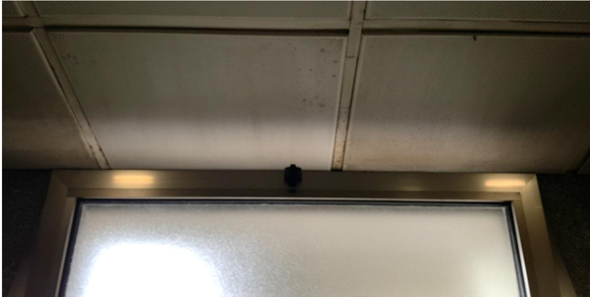
Fotografía 95. Baño Estación Marítima 3, Zona Planta baja – Embarque (Movilidad reducida). Detalle de placas de techo.
