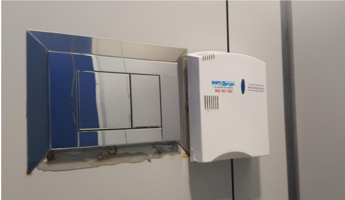
Fotografía 34. Baño Estación Marítima 2, Zona Planta baja – Recogida equipajes. Detalle de falta de marco en cisterna.
