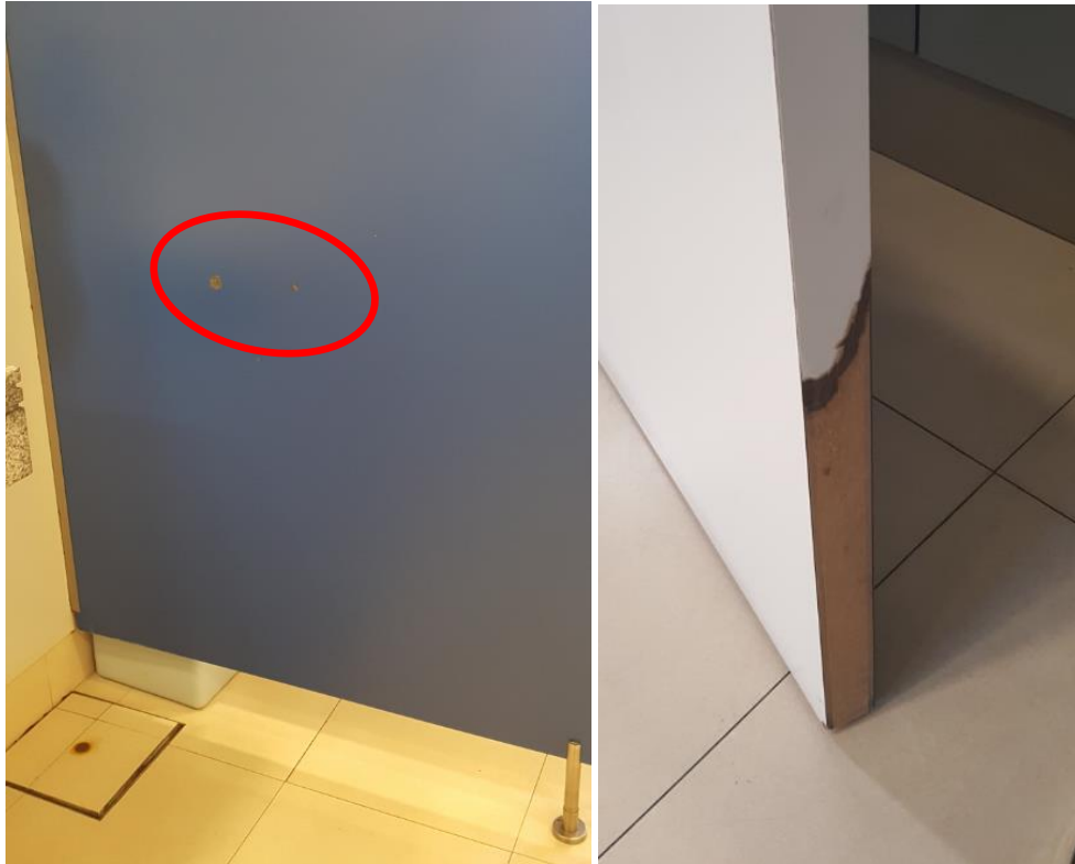
Fotografías 27, 28. Baño Estación Marítima 2, Zona Planta baja – Cafetería, Mujeres. Detalle en separadores, golpeados y desencajados en algunos casos. Fotografía 28: Detalle de puerta principal
