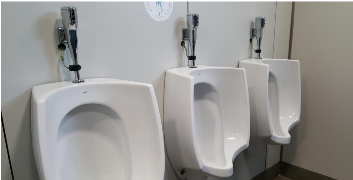
Fotografía 98. Baño Estación Marítima 3, Zona Planta alta – Terraza (Hombres). Detalle de tipo de urinario con detector
