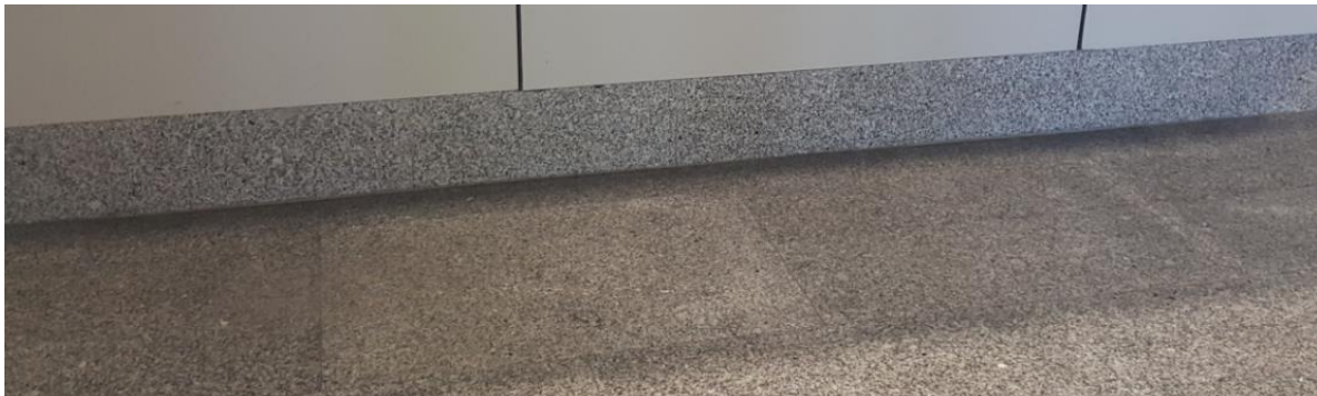
Fotografía 48. Baño Estación Marítima 2, Zona Planta baja – Recogida equipajes. Detalle de baldosas con zonas más oscurecidas
