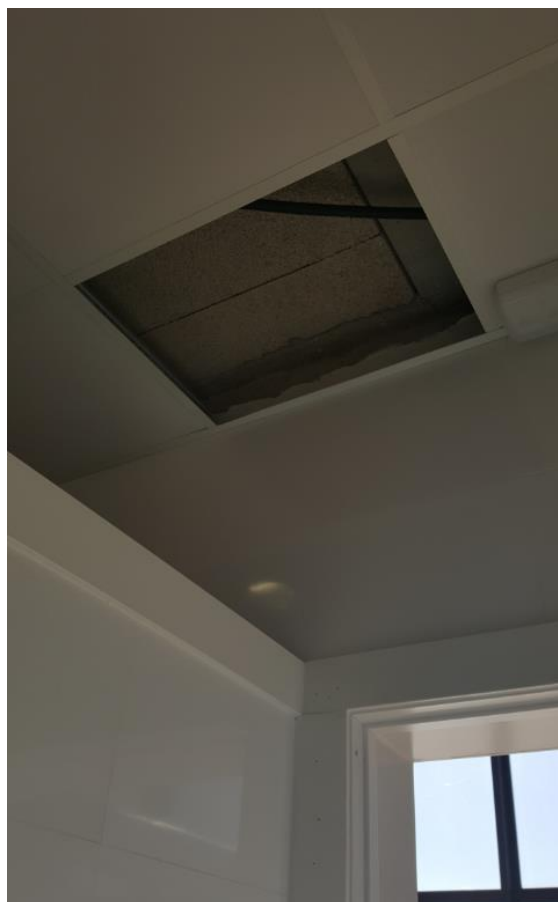
Fotografía 4. Baño Estación Marítima 1, Zona Duty Free, Caballeros. Falta de placa de techo.
