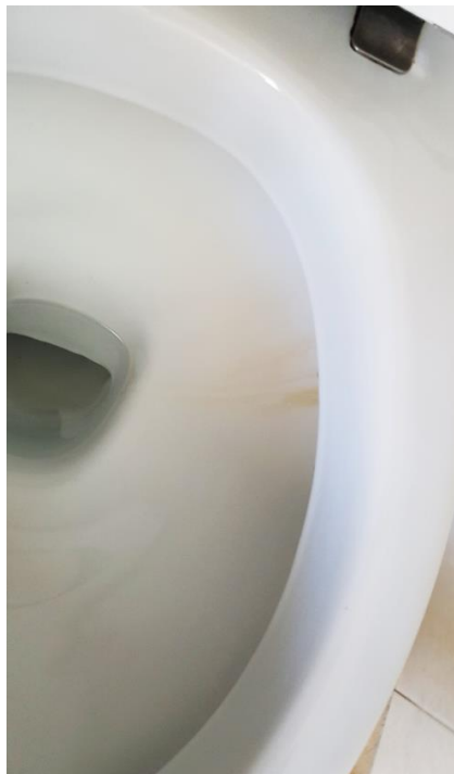
Fotografía 161. Baño Estación Marítima 5, Baños planta alta – Mujeres. Detalle del estado de inodoros, con zonas de sarro que no se van con productos de limpieza.
