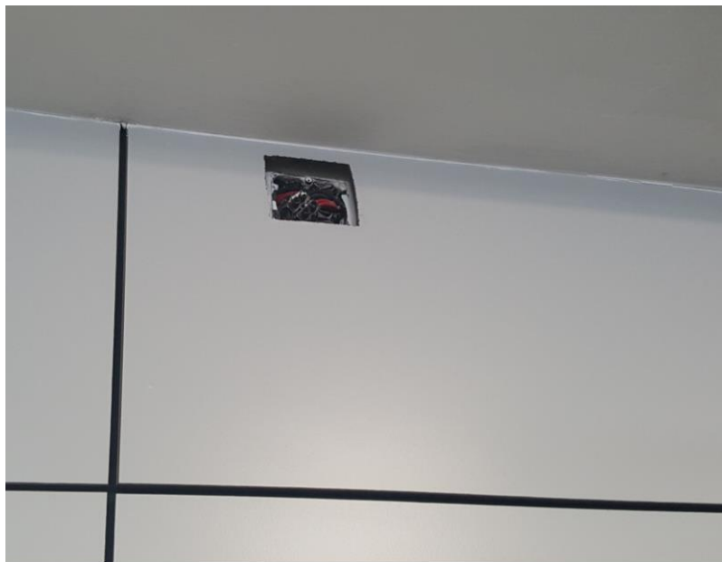
Fotografía 66. Baño Estación Marítima 2, Zona Planta entresuelo– Duty Free (Mujeres). Enchufe alto desinstalado
