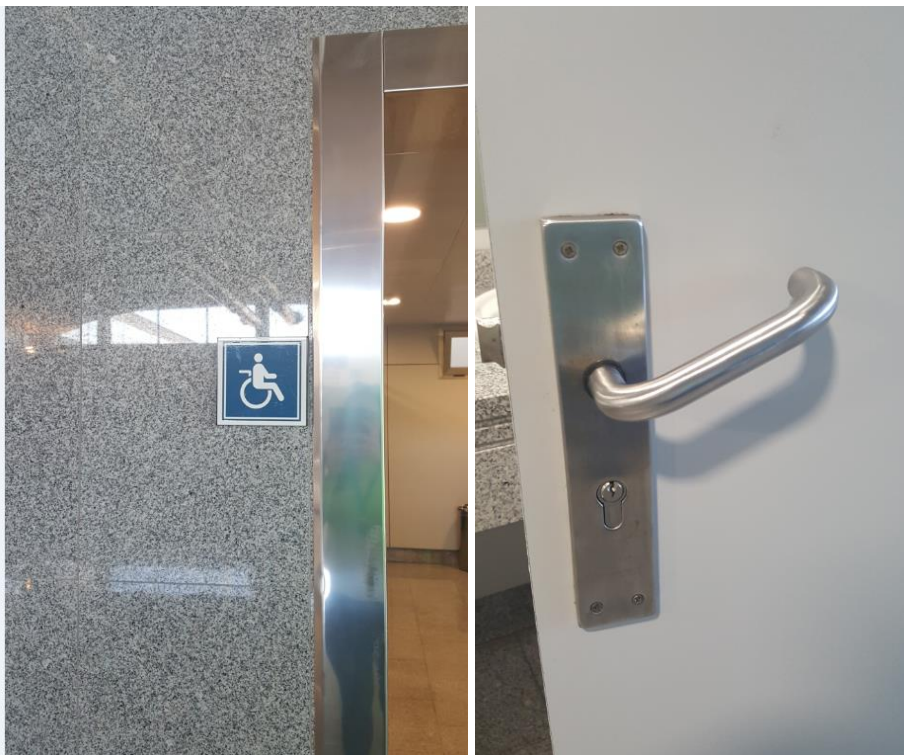
Fotografías 37 y 38. Baño Estación Marítima 2, Zona Planta baja – Recogida equipajes. Detalle de falta de pictograma de “Hombres” y manija con mal funcionamiento de muelle.
