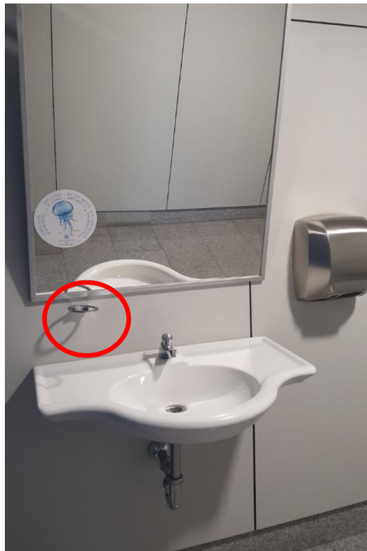
Fotografía 33. Baño Estación Marítima 2, Zona Planta baja – Recogida equipajes. Detalle de falta de jabonera.
