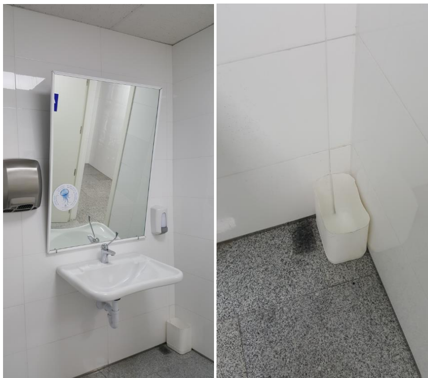
Fotografías 70, 71. Baño Estación Marítima 2, Zona Planta alta – Movilidad reducida (Mujeres). Posible gotera en techo.
