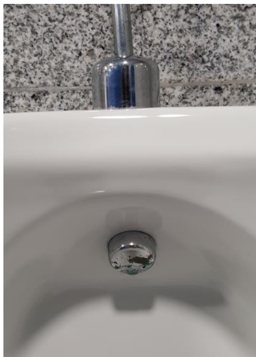
Fotografía 112. Baño Estación Marítima 3, Zona Planta alta – Embarque (Hombres). Detalle de urinario
