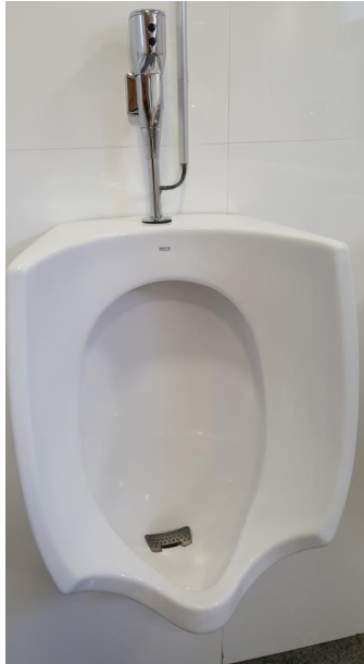
Fotografía 74. Baño Estación Marítima 3, Zona Planta baja – Hall (Hombres). Urinario con detector (dan fallos)
