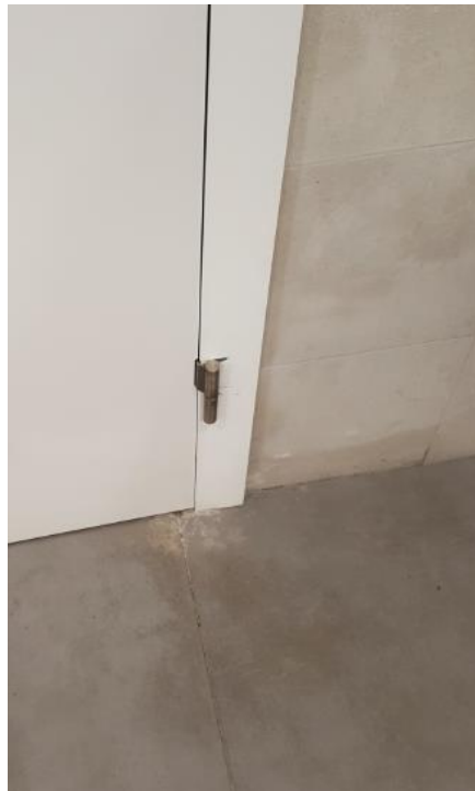
Fotografía 172. Baño Estación Marítima 6, Baños Entrada – Mujeres. Zona manchada en suelo
