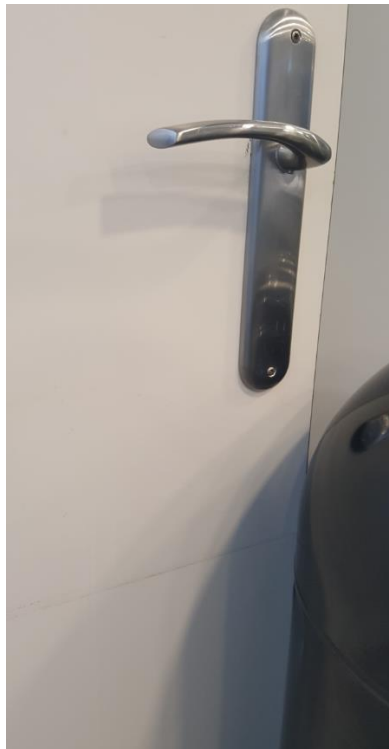
Fotografía 57. Baño Estación Marítima 2, Zona Planta entresuelo – Duty Free. Detalle de marcas en puerta principal. Se debe sujetar con papelera para que se mantenga abierta.
