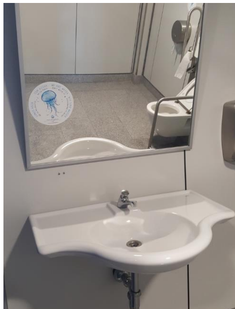
Fotografía 44. Baño Estación Marítima 2, Zona Planta baja – Recogida equipajes. Falta de jabonera.
