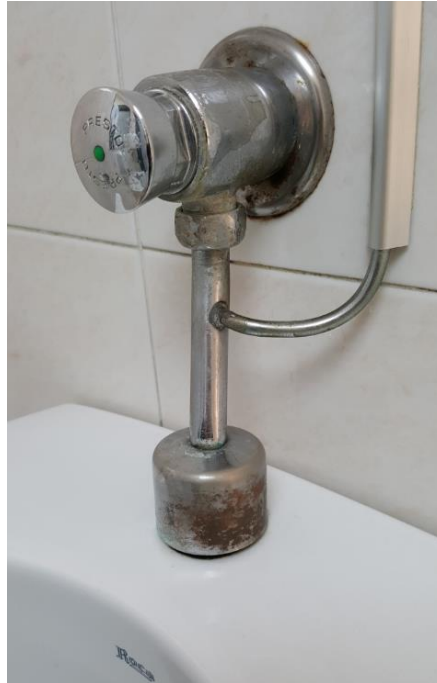
Fotografía 155. Baño Estación Marítima 5, Baños planta alta – Hombres. Detalle de elementos metálicos oxidados y envejecidos en urinarios.
