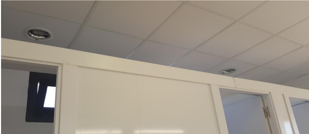
Fotografía 7. Baño Estación Marítima 1, Zona Duty Free, Señoras. Línea de focos sin funcionar.
