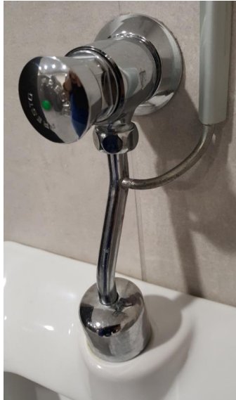
Fotografía 175. Baño Estación Marítima 6, Baños control de seguridad – Hombres. Detalle de oxidación leve en urinarios
