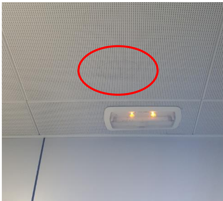
Fotografía 35. Baño Estación Marítima 2, Zona Planta baja – Recogida equipajes. Detalle de manchas en placas de techo.
