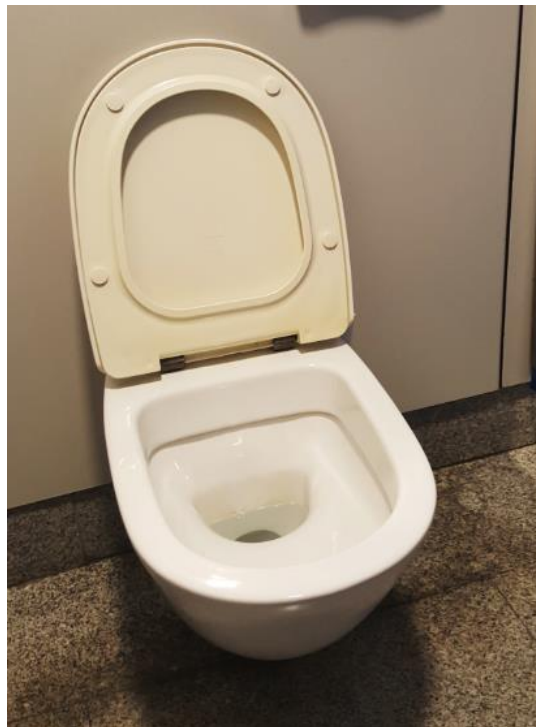
Fotografía 31. Baño Estación Marítima 2, Zona Planta baja – Recogida equipajes. Detalle de tapas de inodoros.
