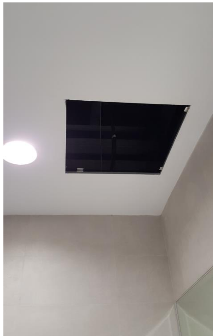
Fotografía 184. Baño Estación Marítima 6, Baños embarque – Mujeres. Falta de registro en techo de baño
