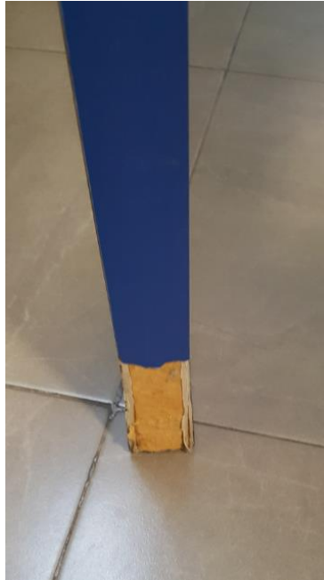
Fotografía 99. Baño Estación Marítima 3, Zona Planta alta – Terraza (Hombres). Detalle de rotura en puerta de movilidad reducida
