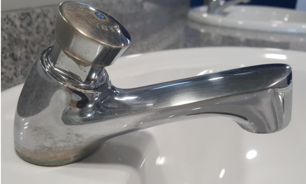
Fotografía 41. Baño Estación Marítima 2, Zona Planta baja – Recogida equipajes. Detalle de grifería con principio de oxidación.
