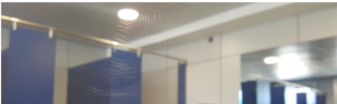
Fotografías 61, 62. Baño Estación Marítima 2, Zona Planta entresuelo – Duty Free (Mujeres). Detalle de espejos (rayones y envejecimiento)
