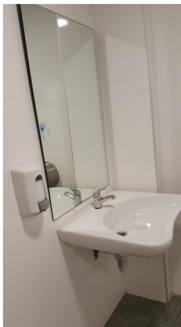
Fotografía 82. Baño Estación Marítima 3, Zona Planta baja – Hall (Mujeres). Detalle aseo movilidad reducida sin seca manos.
