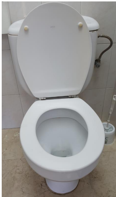
Fotografía 154. Baño Estación Marítima 5, Baños planta alta – Hombres. Detalle del inodoro, con zonas con sarro que no se van.
