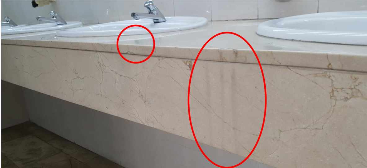
Fotografías 144. Baño Estación Marítima 5, Baños planta baja – Mujeres. Detalle de manchas en grifería
