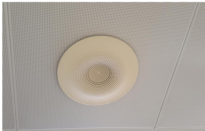
Fotografía 29. Baño Estación Marítima 2, Zona Planta baja – Cafetería, Mujeres. Detalle de equipos de megafonía.
