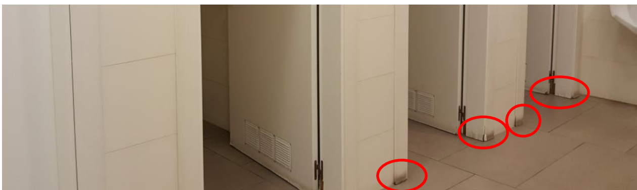
Fotografía 125. Baño Estación Marítima 4, Baños planta baja – Hombres. Detalle del estado de puertas interiores, en marco inferior.
