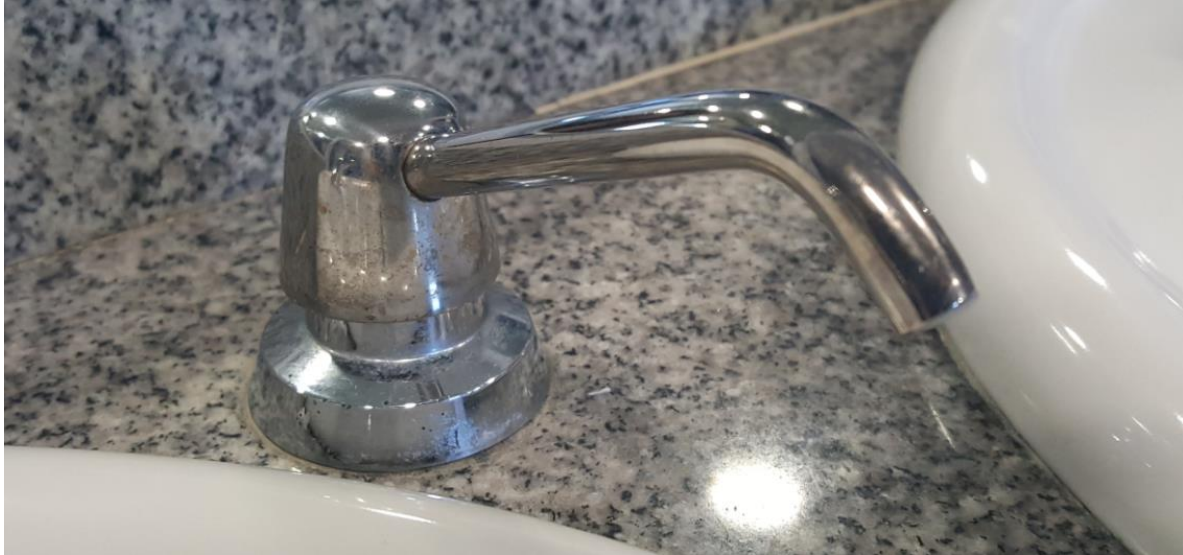
Fotografía 63. Baño Estación Marítima 2, Zona Planta entresuelo – Duty Free (Mujeres). Detalle de jabonera.
