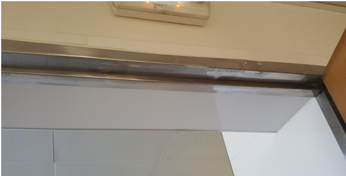
Fotografía 20. Baño Estación Marítima 2, Zona Planta baja – Cafetería, Caballeros. Detalle de marco de puerta con abolladuras.
