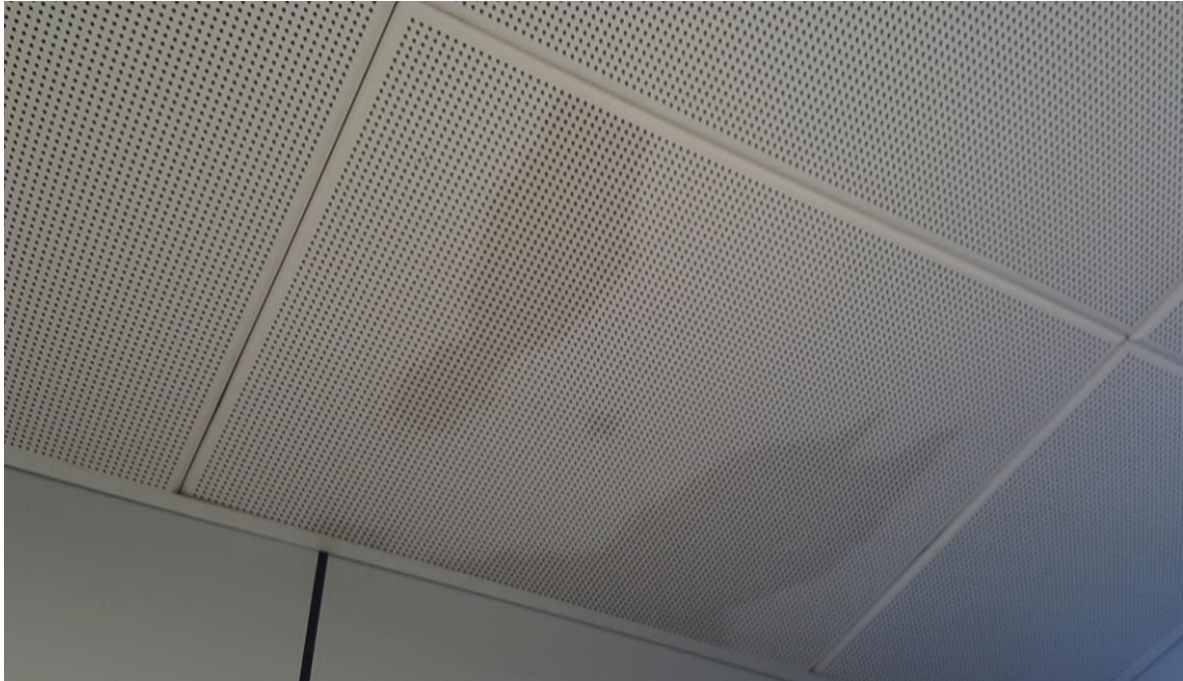
Fotografía 47. Baño Estación Marítima 2, Zona Planta baja – Recogida equipajes. Placas de techo con manchas.
