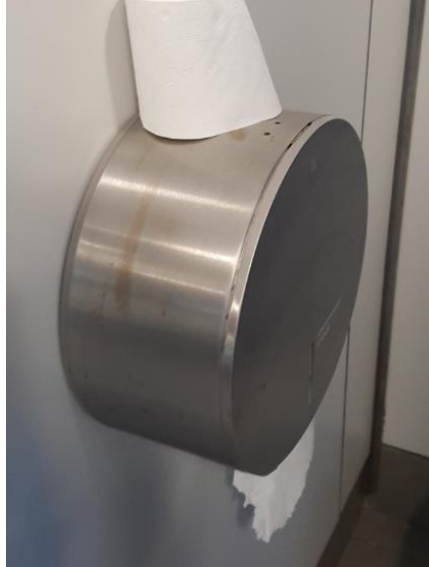
Fotografía 58. Baño Estación Marítima 2, Zona Planta entresuelo – Duty Free. Estado de portarrollos.
