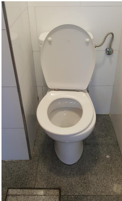
Fotografía 10. Baño Estación Marítima 2, Zona Planta baja – Cafetería, Caballeros. Detalle de tapas desencajadas.
