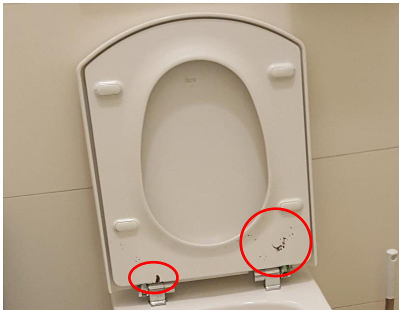
Fotografía 127. Baño Estación Marítima 4, Baños planta baja – Mujeres. Detalle de tapa con roces.
