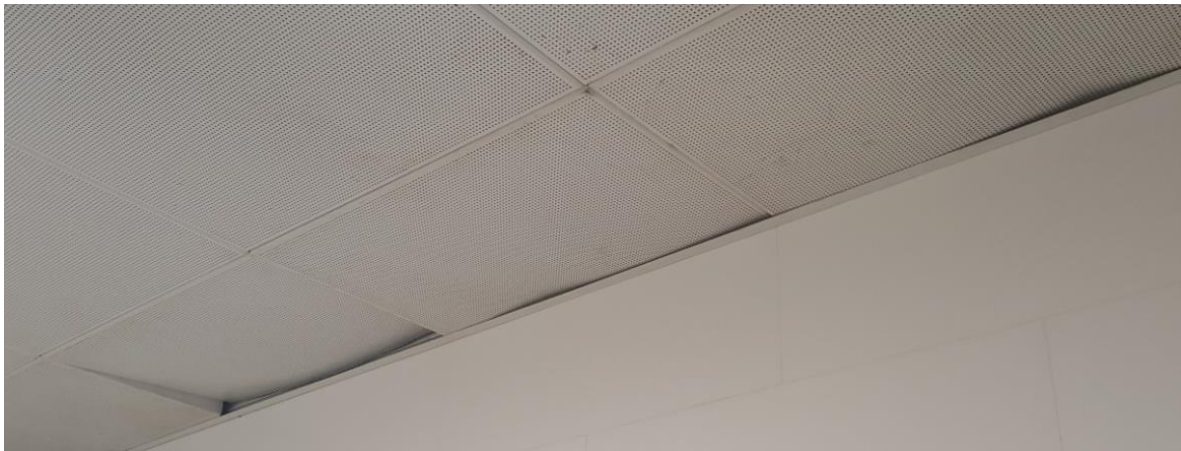
Fotografías 15, 16. Baño Estación Marítima 2, Zona Planta baja – Cafetería, Caballeros. Detalle de placas de techo caídas y movidas.
