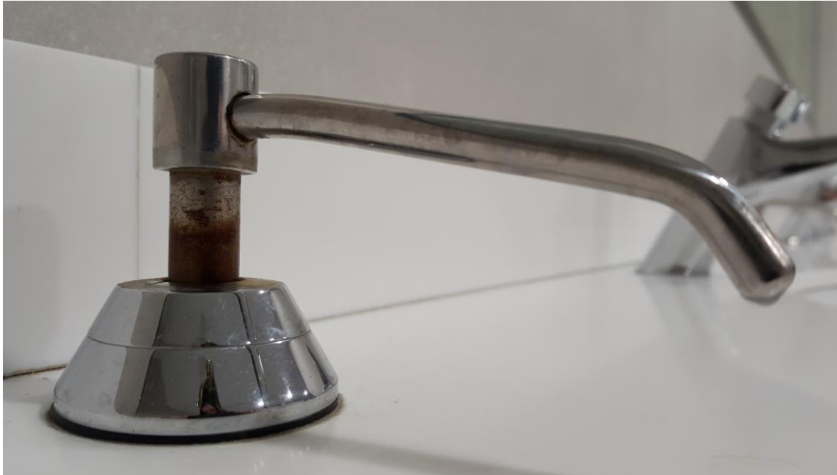
Fotografía 181. Baño Estación Marítima 6, Baños embarque – Hombres. Detalle de oxidación en jabonera
