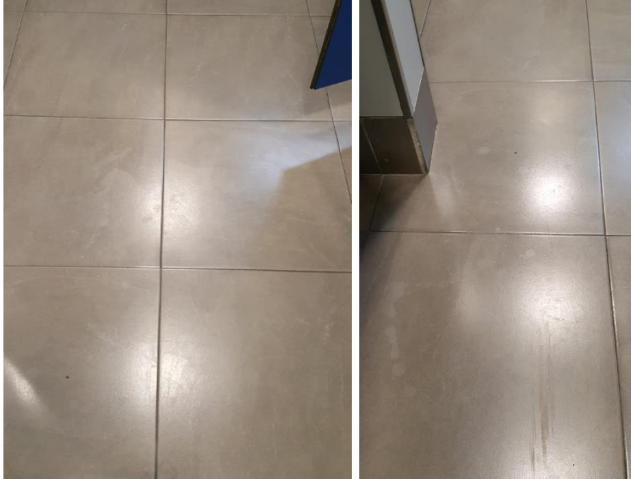
Fotografías 102, 103. Baño Estación Marítima 3, Zona Planta alta – Terraza (Hombres). Detalle del estado de baldosas de suelo.
