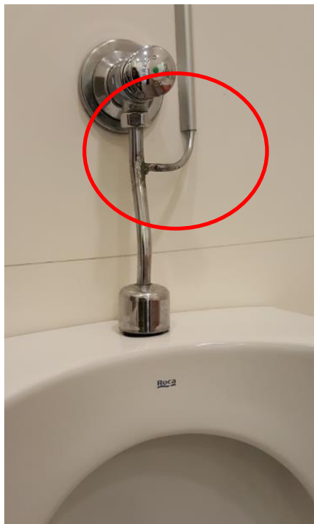
Fotografía 122. Baño Estación Marítima 4, Baños planta baja – Hombres. Detalle de elementos metálicos oscurecidos
