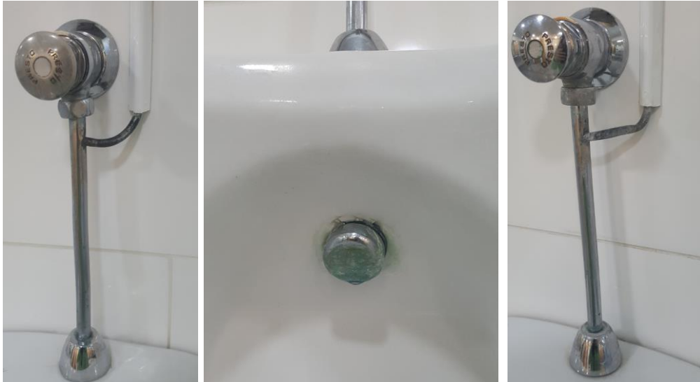
Fotografías 11, 12 y 13. Baño Estación Marítima 2, Zona Planta baja – Cafetería, Caballeros. Detalles de oxidación en elementos metálicos de urinarios.
