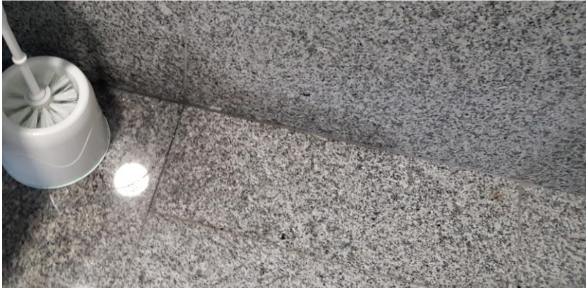
Fotografía 119. Baño Estación Marítima 3, Zona Planta alta – Embarque (Mujeres). Detalle de zonas oscurecidas en suelo
