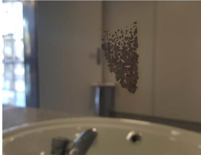
Fotografía 43. Baño Estación Marítima 2, Zona Planta baja – Recogida equipajes. Detalle de desgaste en espejo
