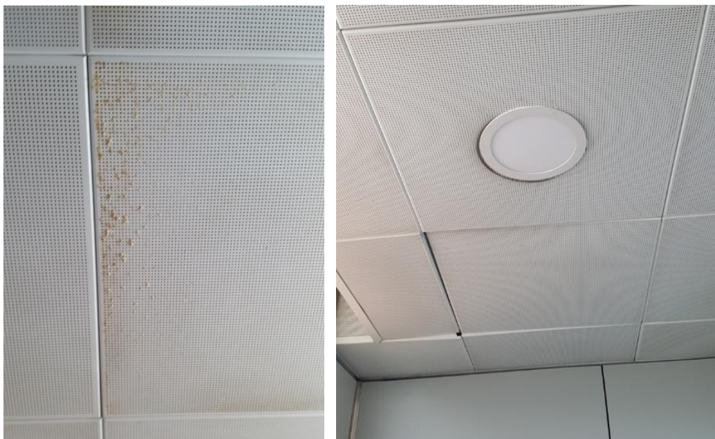
Fotografías 100, 101. Baño Estación Marítima 3, Zona Planta alta – Terraza (Hombres). Detalle del estado de las placas del techo.
