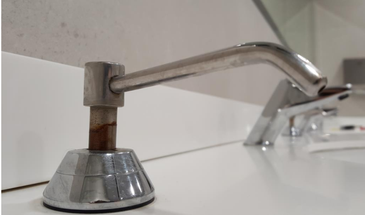
Fotografía 183. Baño Estación Marítima 6, Baños embarque – Mujeres. Detalle de oxidación en jabonera
