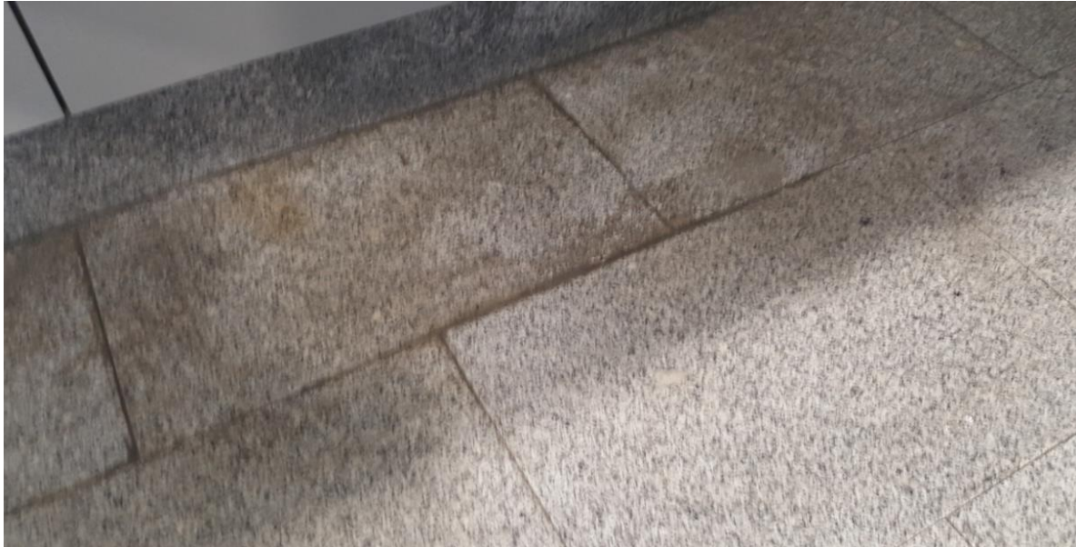
Fotografía 36. Baño Estación Marítima 2, Zona Planta baja – Recogida equipajes. Detalle de manchas en baldosas.
