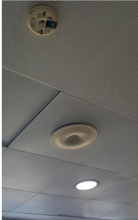
Fotografía 21. Baño Estación Marítima 2, Zona Planta baja – Cafetería, Caballeros. Detalle de megafonía.
