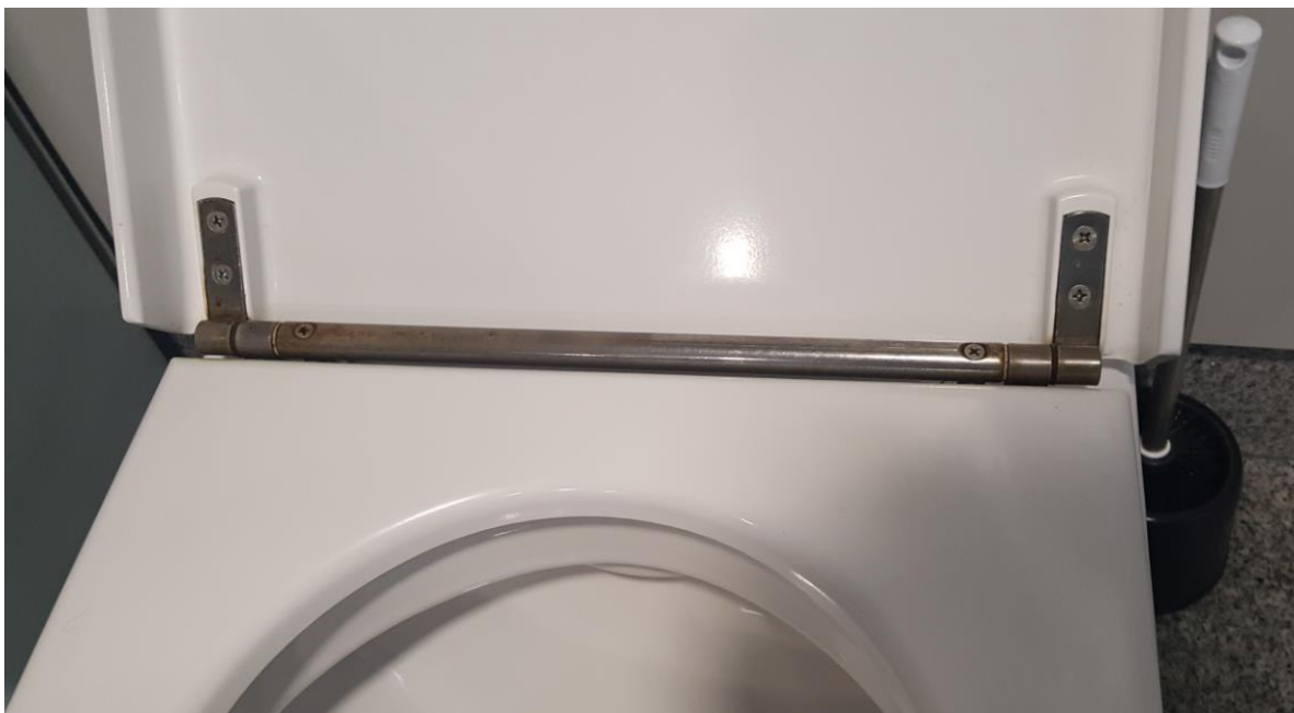
Fotografía 42. Baño Estación Marítima 2, Zona Planta baja – Recogida equipajes. Detalle de tapas WC con oxidación.
