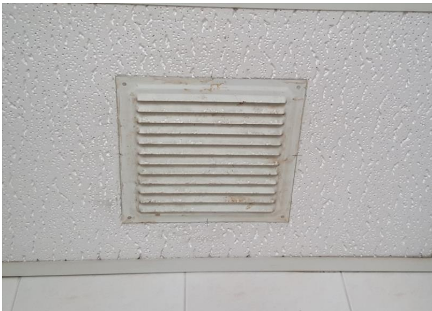
Fotografía 159. Baño Estación Marítima 5, Baños planta alta – Hombres. Detalle del estado de rejilla.
