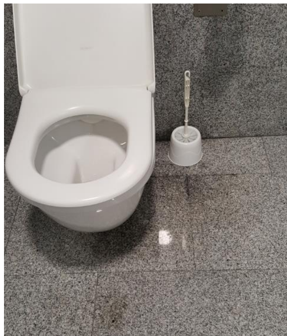
Fotografía 96. Baño Estación Marítima 3, Zona Planta baja – Embarque (Movilidad reducida). Detalle de suelo con zonas oscurecidas
