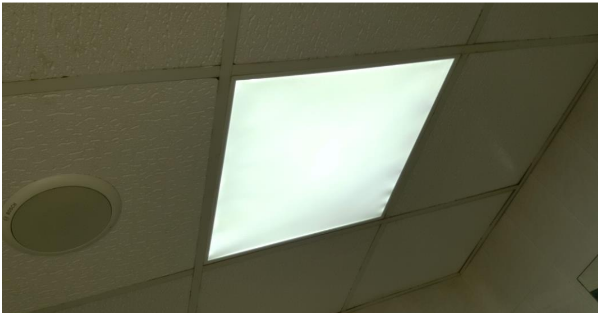
Fotografía 156. Baño Estación Marítima 5, Baños planta alta – Hombres. Detalle de márgenes en luces y techo con placas sucias
