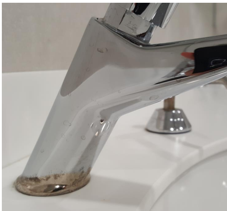
Fotografía 174. Baño Estación Marítima 6, Baños control de seguridad – Hombres. Detalle de coloración en grifería
