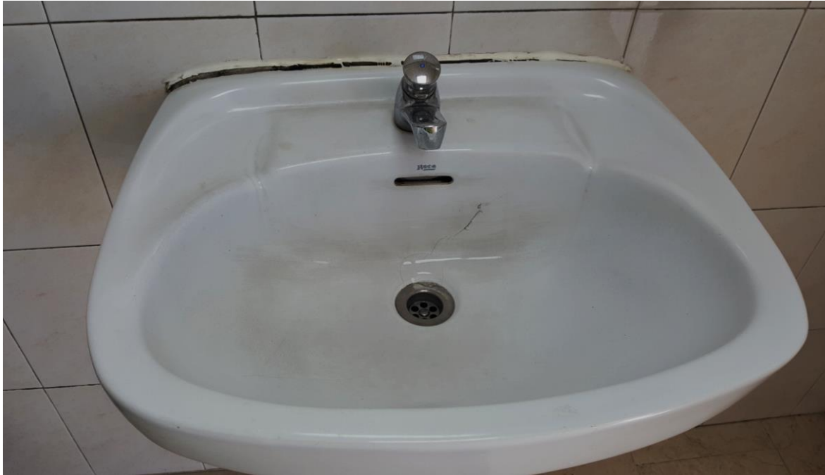
Fotografía 153. Baño Estación Marítima 5, Baños planta alta – Hombres. Detalle de lavabo, con zonas oscurecidas y rozadas, además de estar bastante despegado de la pared
