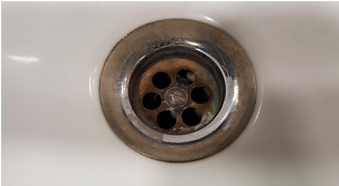
Fotografía 104. Baño Estación Marítima 3, Zona Planta alta – Terraza (Mujeres). Detalle del estado de desagües (grifería).
