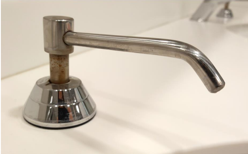
Fotografía 171. Baño Estación Marítima 6, Baños Entrada – Mujeres. Detalle de oxidación en jabonera
