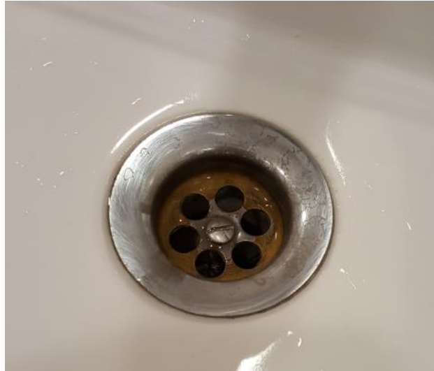
Fotografía 121. Baño Estación Marítima 4, Baños planta baja – Hombres. Detalle del estado de grifería y desagües
