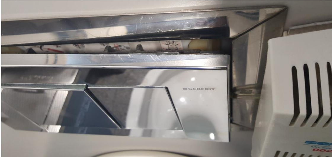
Fotografía 45. Baño Estación Marítima 2, Zona Planta baja – Recogida equipajes. Detalle de cisterna medio desencajada por la instalación del bacteriostático, que impide que se cierre totalmente.
