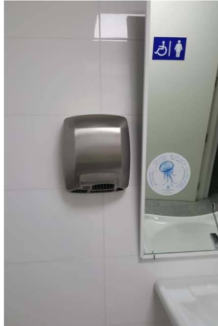
Fotografía 69. Baño Estación Marítima 2, Zona Planta alta – Movilidad reducida (Hombres/Mujeres). Detalle de falta de enchufe en seca manos. Al acercarse para que se ponga en marcha, no funciona.
