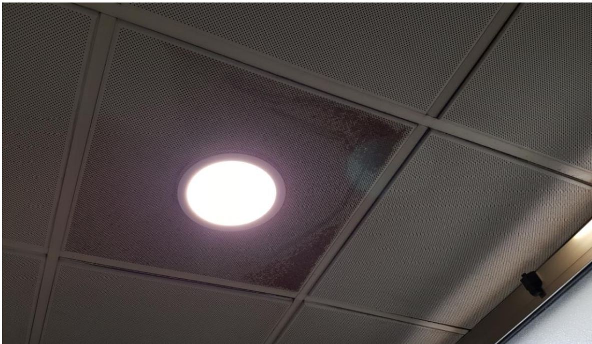
Fotografía 88. Baño Estación Marítima 3, Zona Planta baja – Embarque (Hombres). Detalle de placas techo
