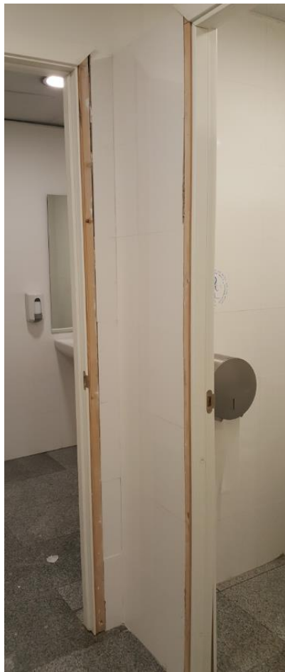
Fotografías 83, 84. Baño Estación Marítima 3, Zona Planta baja – Hall (Mujeres). Detalles en marcos de puerta principal (foto arriba) y marcos rotos y cedidos (foto inferior).
