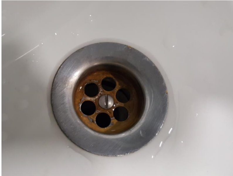
Fotografía 85. Baño Estación Marítima 3, Zona Planta baja – Embarque (Hombres). Detalles de desagües
