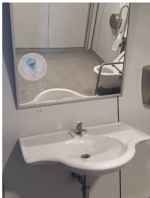
Fotografía 44. Baño Estación Marítima 2, Zona Planta baja – Recogida equipajes. Falta de jabonera.
