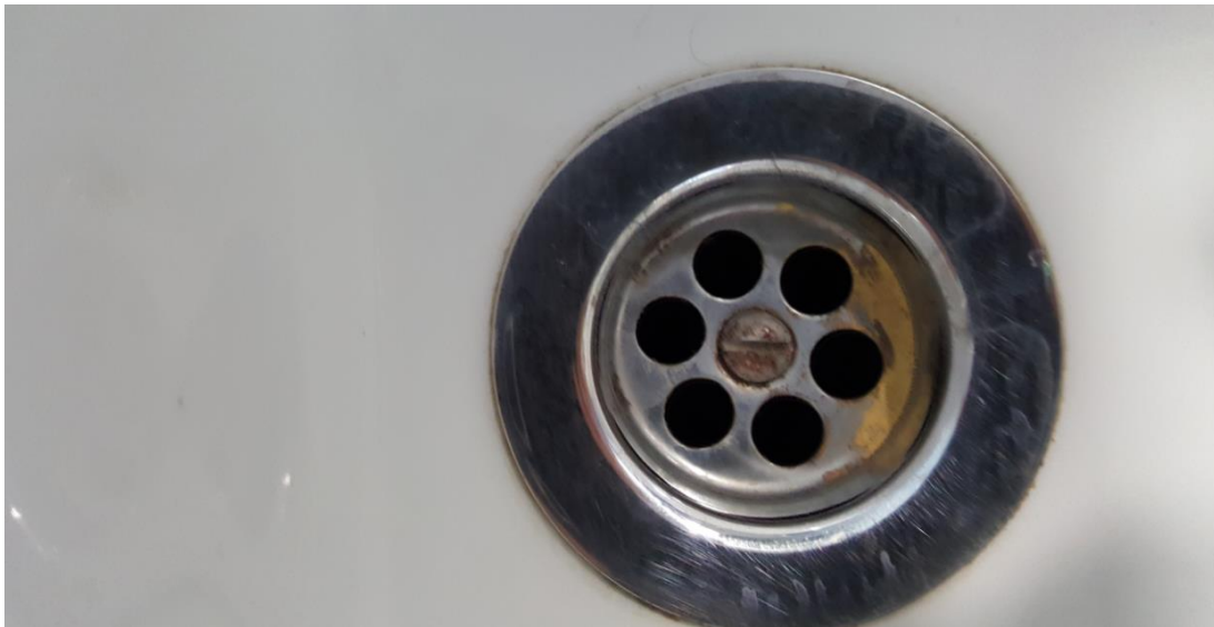
Fotografía 110. Baño Estación Marítima 3, Zona Planta alta – Embarque (Hombres). Detalle del estado de la grifería
