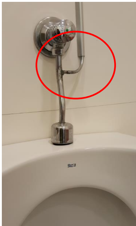
Fotografía 122. Baño Estación Marítima 4, Baños planta baja – Hombres. Detalle de elementos metálicos oscurecidos
