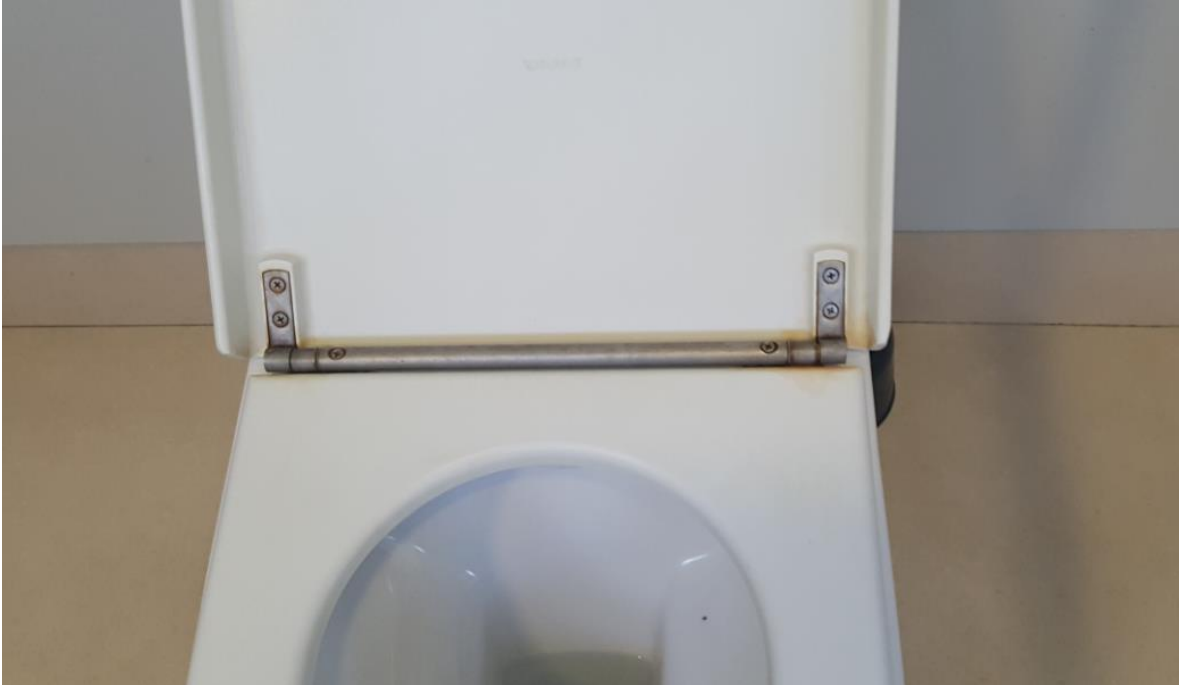
Fotografía 23. Baño Estación Marítima 2, Zona Planta baja – Cafetería, Mujeres. Detalle de oxidación en tapa WC.
