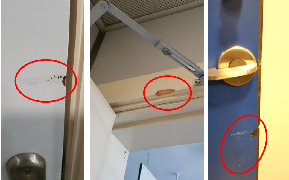
Fotografías 107, 108, 109. Baño Estación Marítima 3, Zona Planta alta – Terraza (Mujeres). Detalle del estado de la puerta principal y separadores
