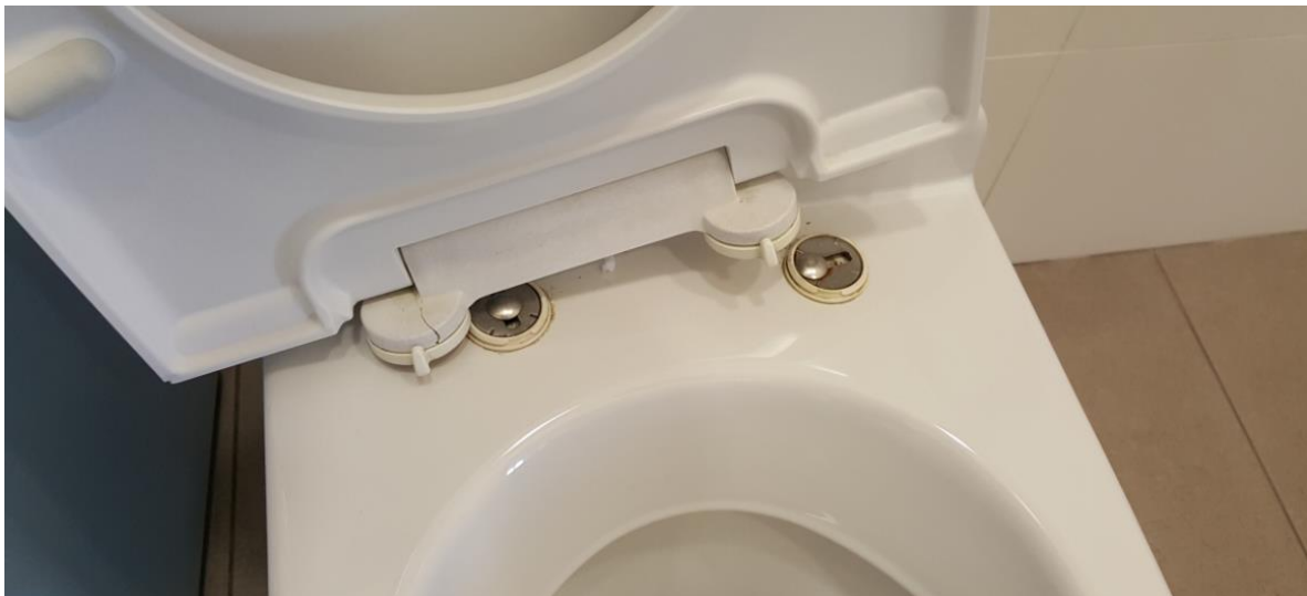
Fotografía 129. Baño Estación Marítima 4, Baños planta baja – Movilidad Reducida. Detalle de tapa rota.
