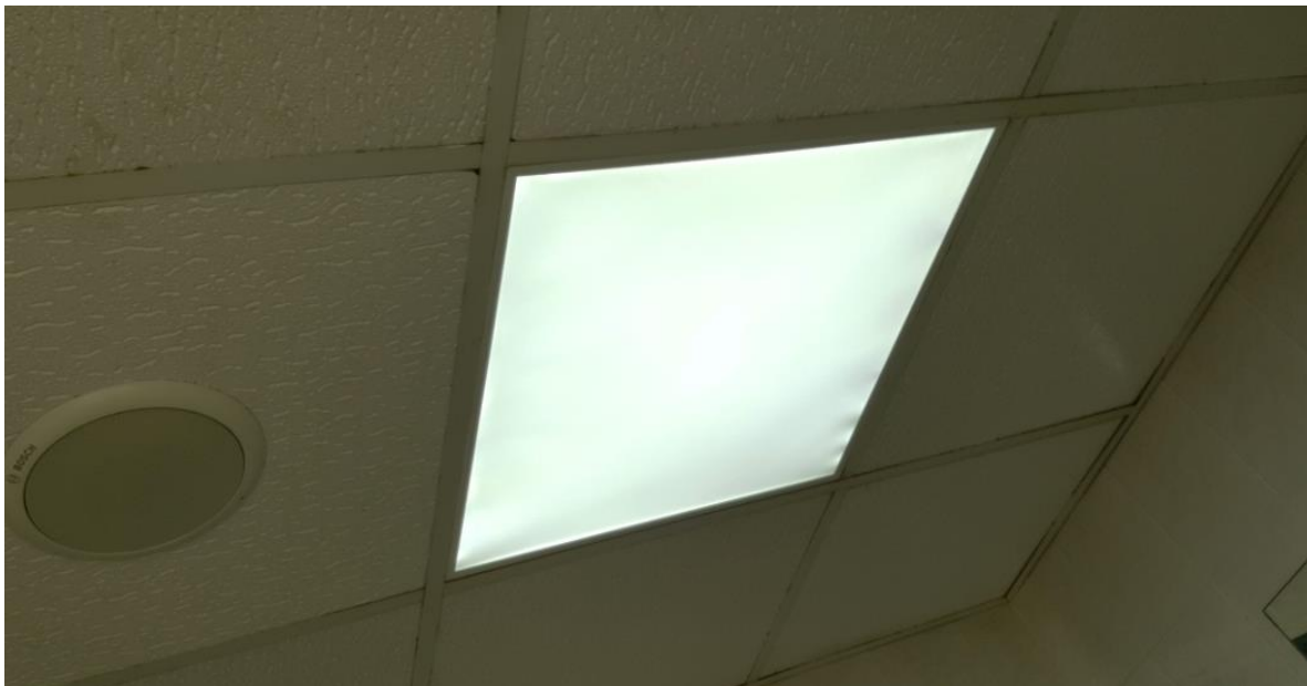
Fotografía 156. Baño Estación Marítima 5, Baños planta alta – Hombres. Detalle de márgenes en luces y techo con placas sucias
