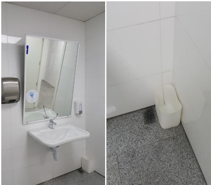
Fotografías 70, 71. Baño Estación Marítima 2, Zona Planta alta – Movilidad reducida (Mujeres). Posible gotera en techo.
