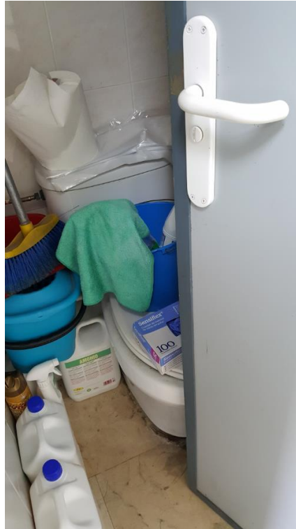
Fotografía 162. Baño Estación Marítima 5, Baños planta alta – Mujeres. Tercer cuarto de baño individual, al que no se puede acceder por roce de puerta con inodoro. Se usa como zona de acopio de material de limpieza
