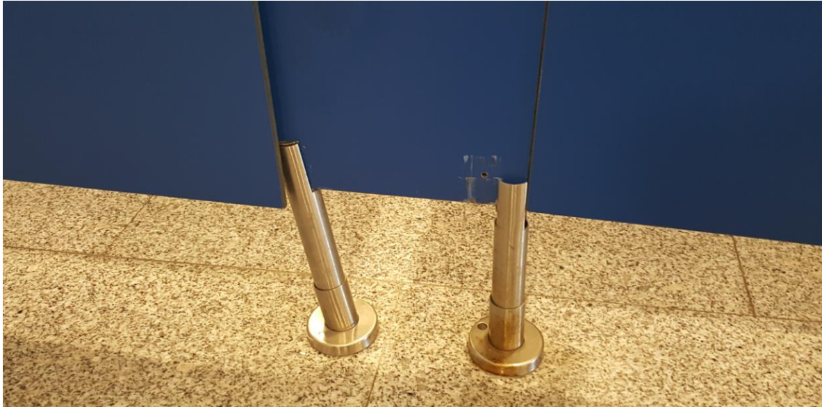
Fotografía 49. Baño Estación Marítima 2, Zona Planta baja – Recogida equipajes. Separadores de baños desenchajados, las puertas de los baños no pueden cerrarse con pestillo.
