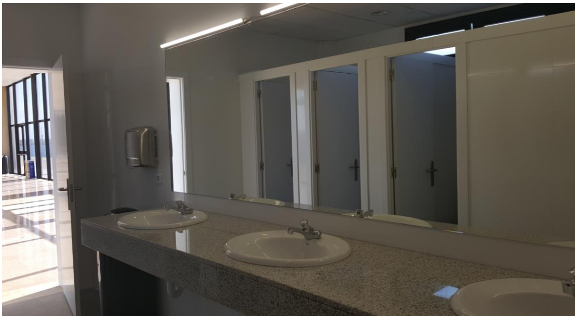
Fotografía 8. Baño Estación Marítima 1, Zona Duty Free, Señoras. Vista general (faltan jaboneras y cambiadores de bebé).
