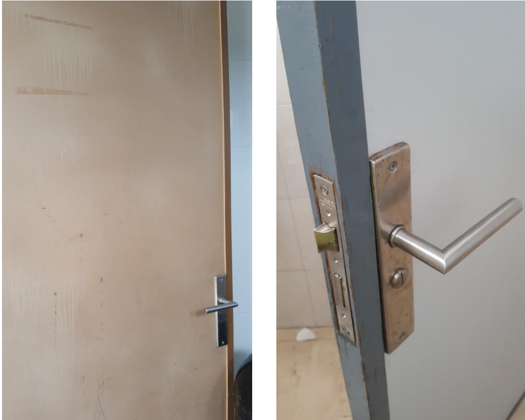
Fotografías 141, 142. Baño Estación Marítima 5, Baños planta baja – Hombres. Detalle de puerta principal, color marrón, y puertas baños individuales, color gris. Desgastadas, sin cartel de “Hombres”. Envejecidas.
