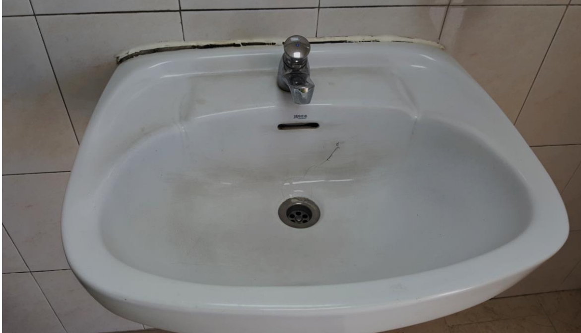
Fotografía 153. Baño Estación Marítima 5, Baños planta alta – Hombres. Detalle de lavabo, con zonas oscurecidas y rozadas, además de estar bastante despegado de la pared
