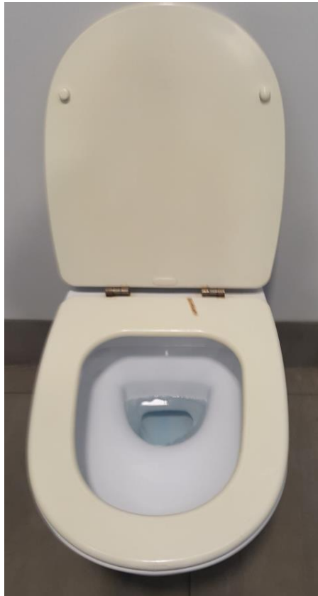
Fotografía 52. Baño Estación Marítima 2, Zona Planta entresuelo – Duty Free. Tapas de WC en mal estado.
