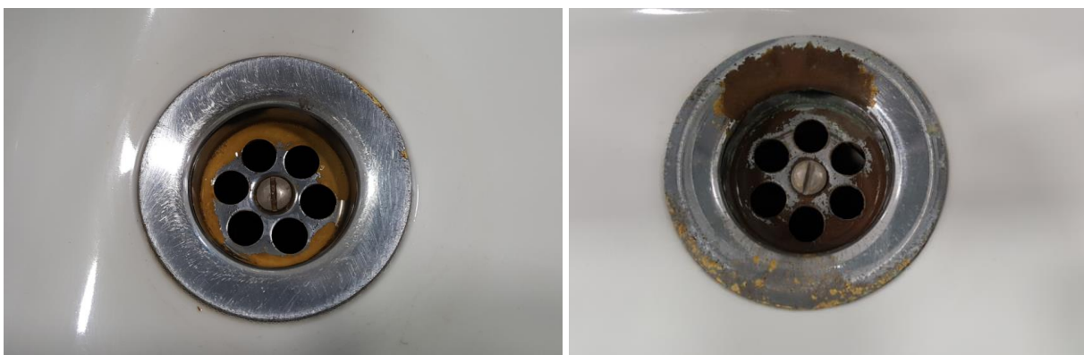
Fotografías 91, 92. Baño Estación Marítima 3, Zona Planta baja – Embarque (Mujeres). Detalle de desagües/grifería
