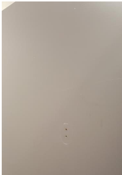
Fotografía 170. Baño Estación Marítima 6, Baños Entrada – Hombres. Detalle de falta de perchas en separadores
