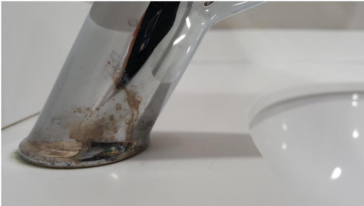
Fotografía 182. Baño Estación Marítima 6, Baños embarque – Mujeres. Detalle de oxidación en grifería
