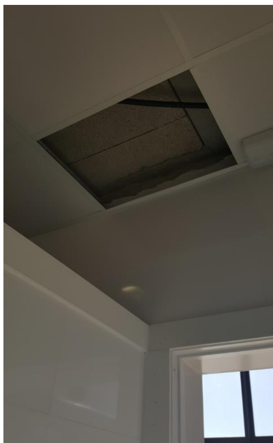
Fotografía 4. Baño Estación Marítima 1, Zona Duty Free, Caballeros. Falta de placa de techo.
