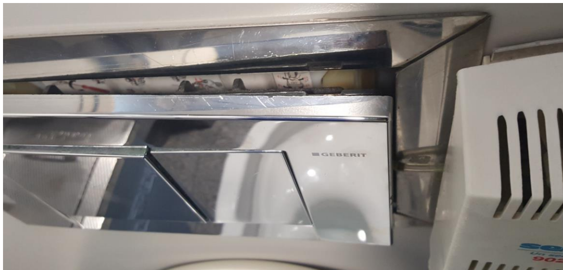
Fotografía 45. Baño Estación Marítima 2, Zona Planta baja – Recogida equipajes. Detalle de cisterna medio desencajada por la instalación del bacteriostático, que impide que se cierre totalmente.
