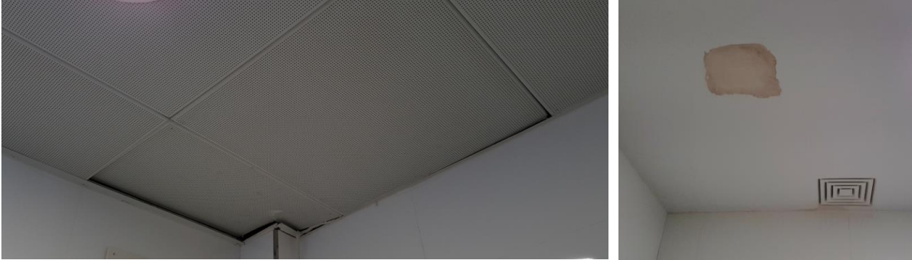
Fotografías 77, 78. Baño Estación Marítima 3, Zona Planta baja – Hall (Hombres). Detalles en techos.
