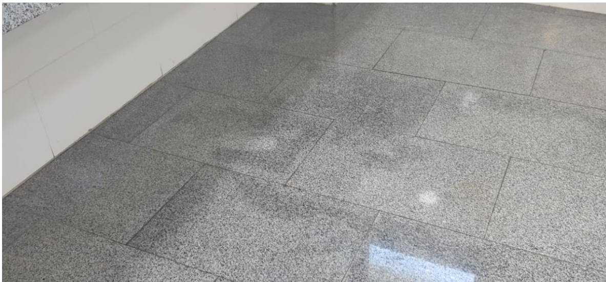
Fotografía 18. Baño Estación Marítima 2, Zona Planta baja – Cafetería, Caballeros. Detalle de suelos y manchas oscuras
