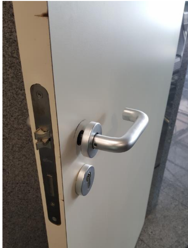
Fotografía 120. Baño Estación Marítima 3, Zona Planta alta – Embarque (Mujeres). Detalle de manilla suelta y rozaduras en puerta
