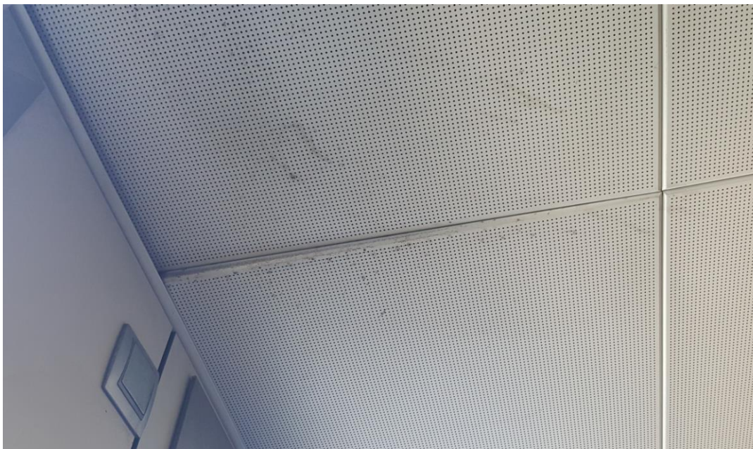
Fotografía 68. Baño Estación Marítima 2, Zona Planta entresuelo- Duty Free (Mujeres). Detalle de placas de techo
