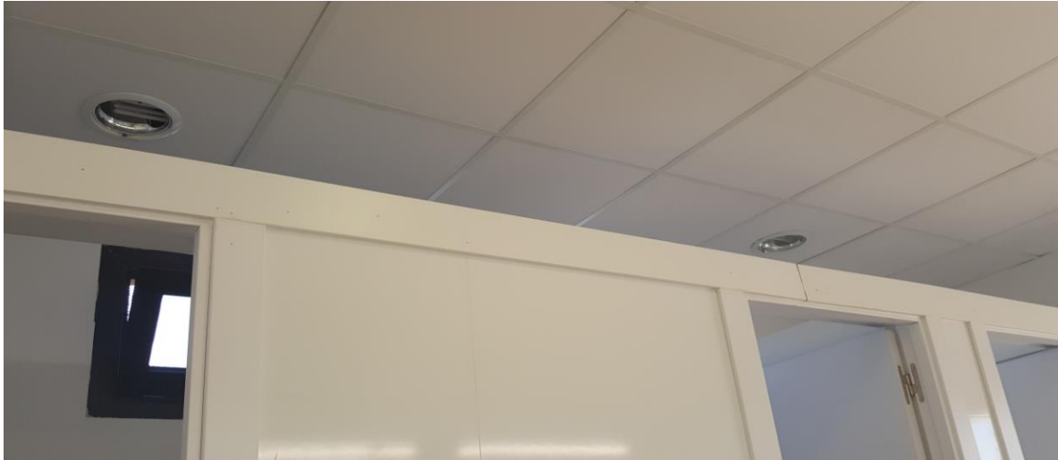
Fotografía 7. Baño Estación Marítima 1, Zona Duty Free, Señoras. Línea de focos sin funcionar.
