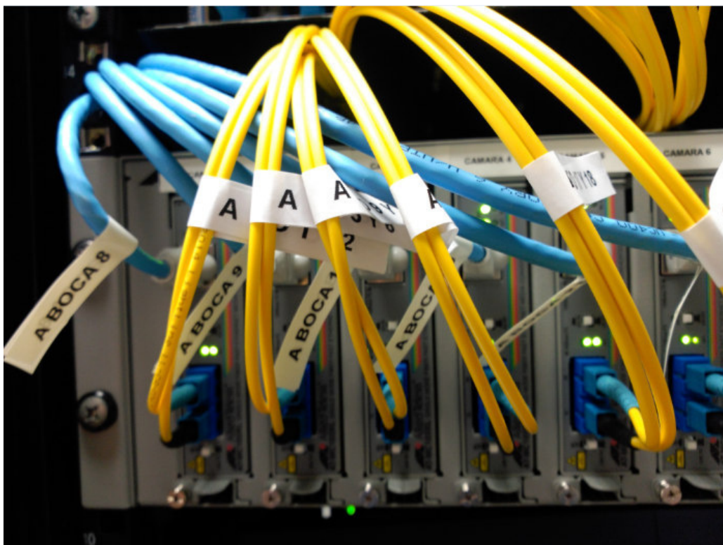
Detalle conversores de medio en rack oficinas APB
