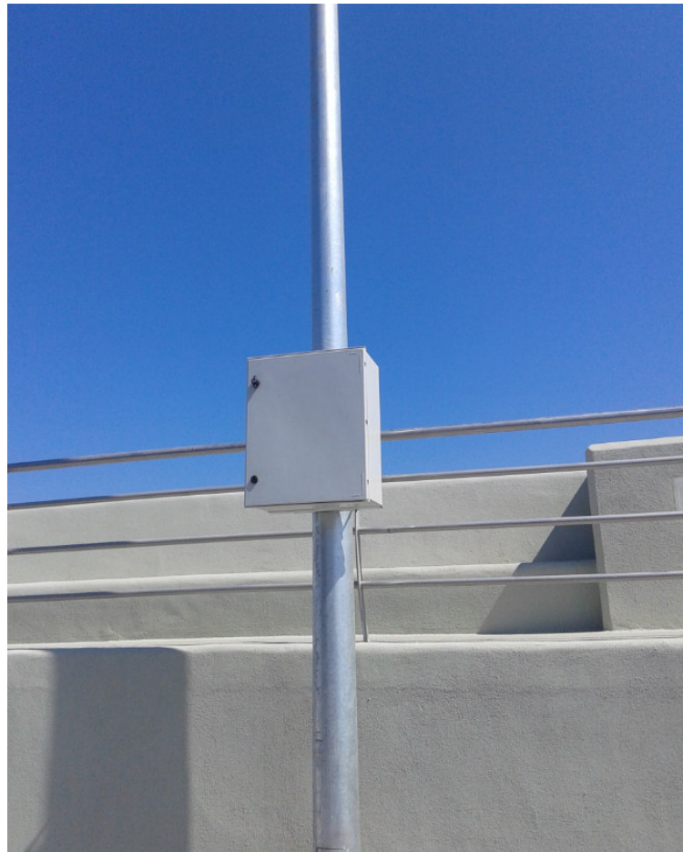
Detalle armario cámara nº 1
