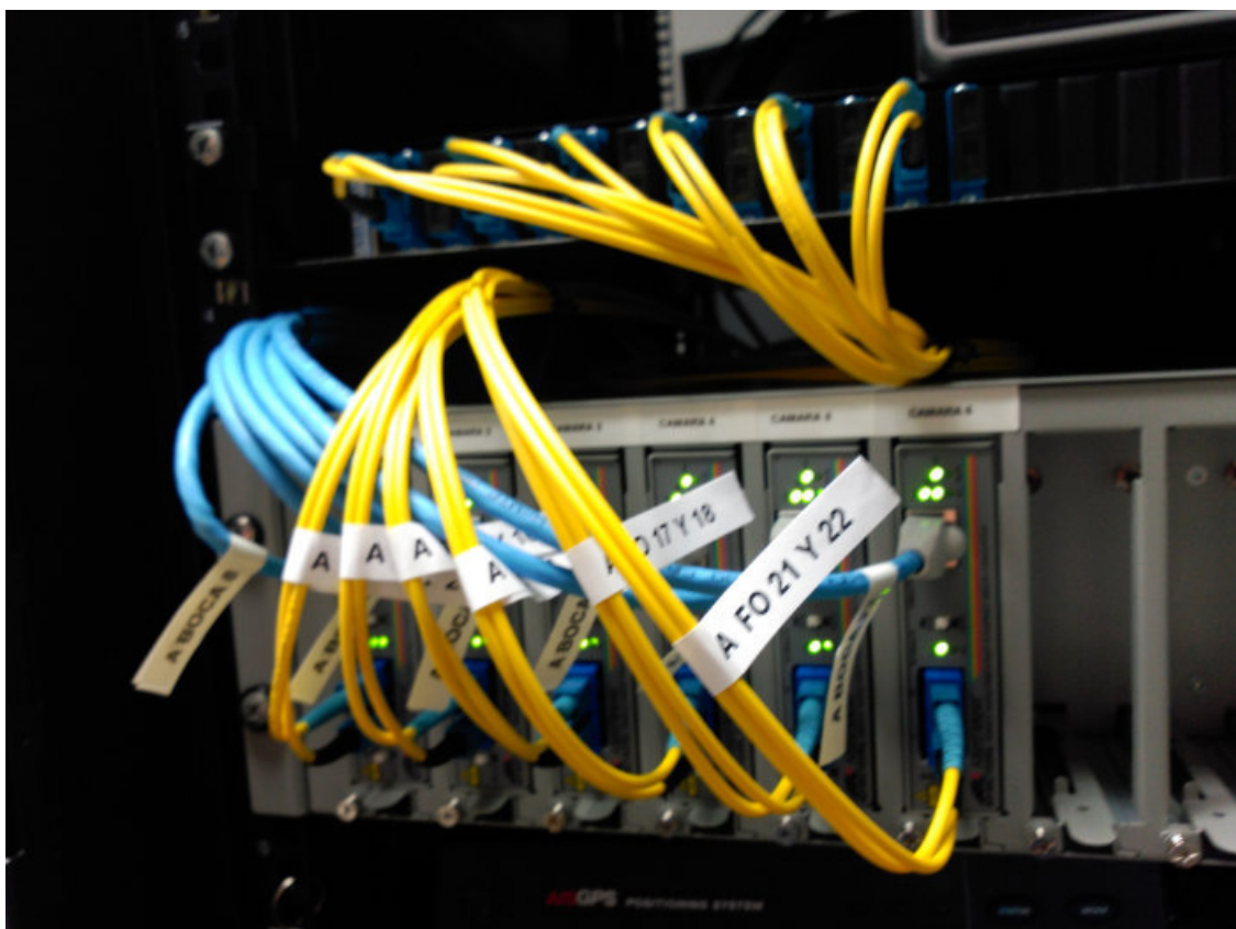
Conexión fibras a convertidores de medio en rack oficinas APB
