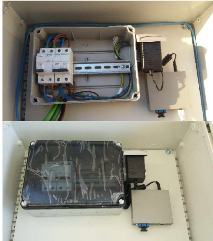
Detalle cuadro protección eléctrica en báculos
