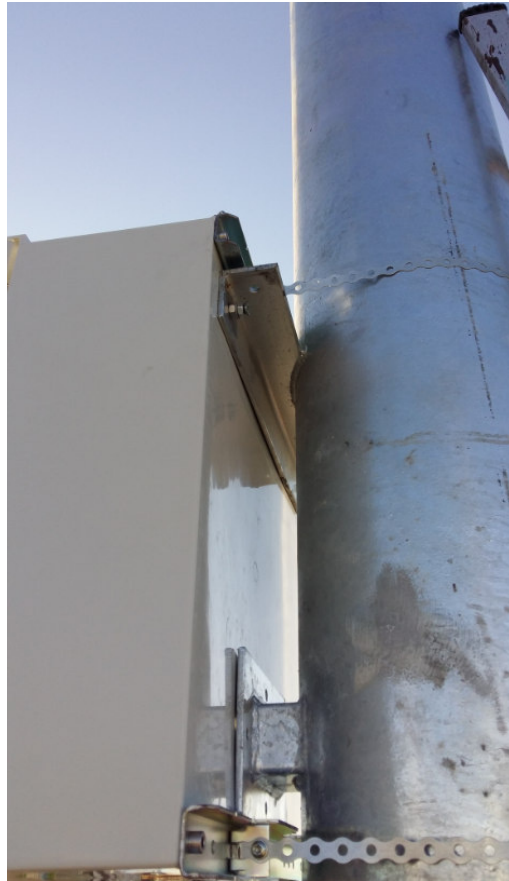
Detalle sujeción armario a báculo de la cámara nº 6
