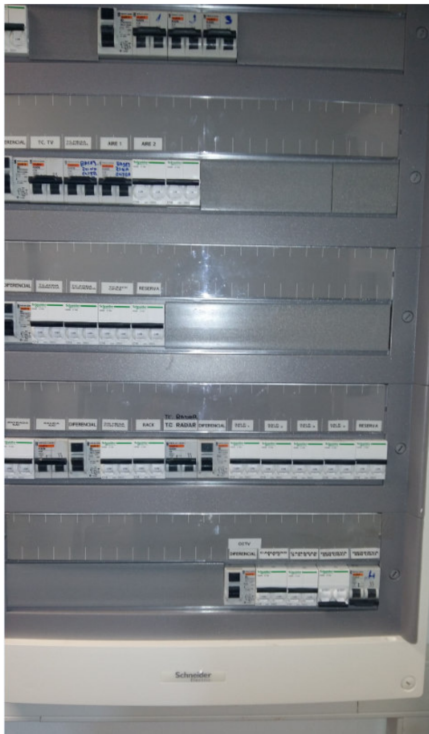
Quadro eléctrico en la sala de racks de las oficinas de la APB
