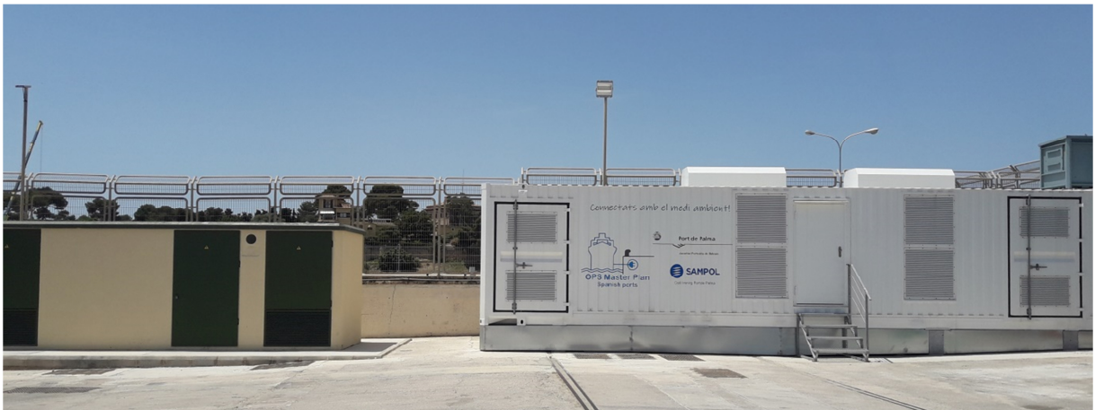
Centro de Transformación y Subestación OPS
