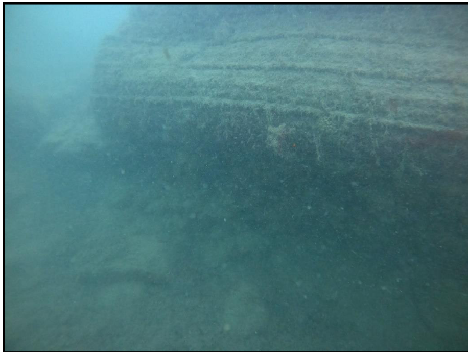
Foto N°4 Descalce en TRAMO 1
