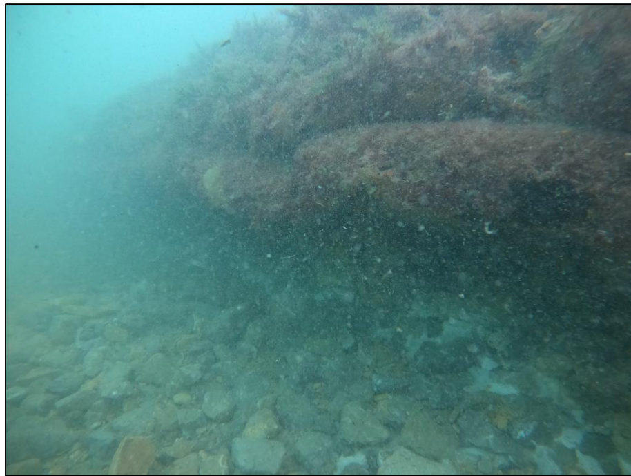
Foto N°12 Descalce en TRAMO 10
