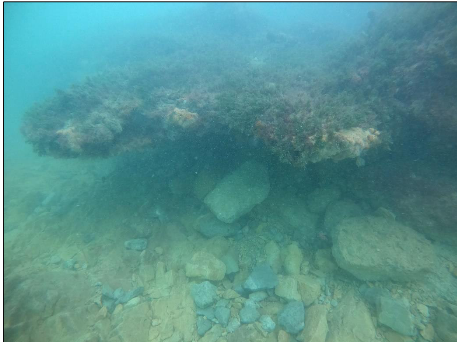
Foto N°17 Descalce en TRAMO 11
