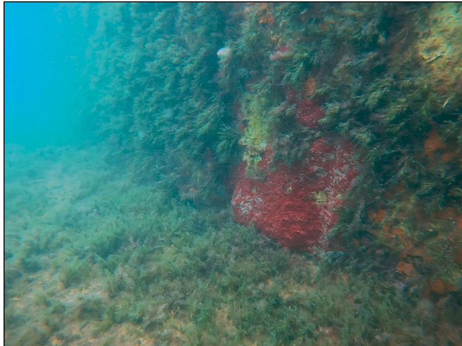
Foto junta de viga de atado con muelle de hormigón en masa TRAMO 12
