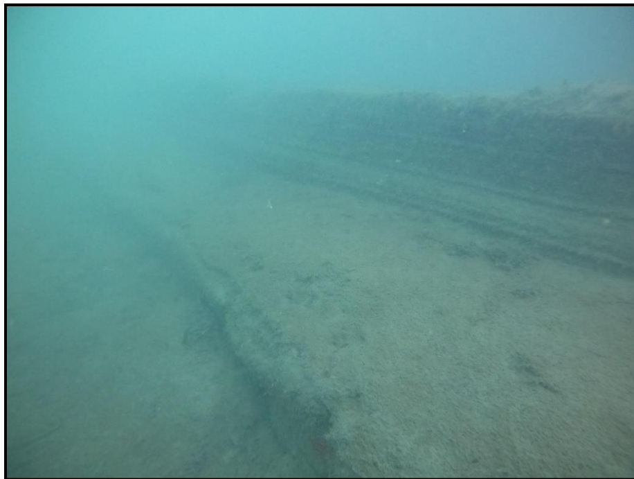
Foto N°9 Descalce en TRAMO 2
