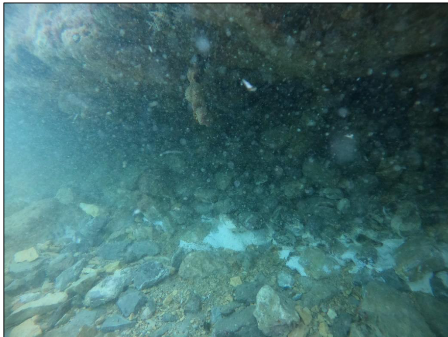
Foto N°14 Descalce en TRAMO 10
