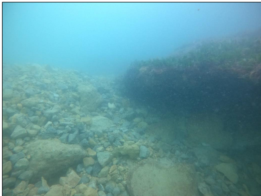
Foto N°26 Descalce en TRAMO 11
