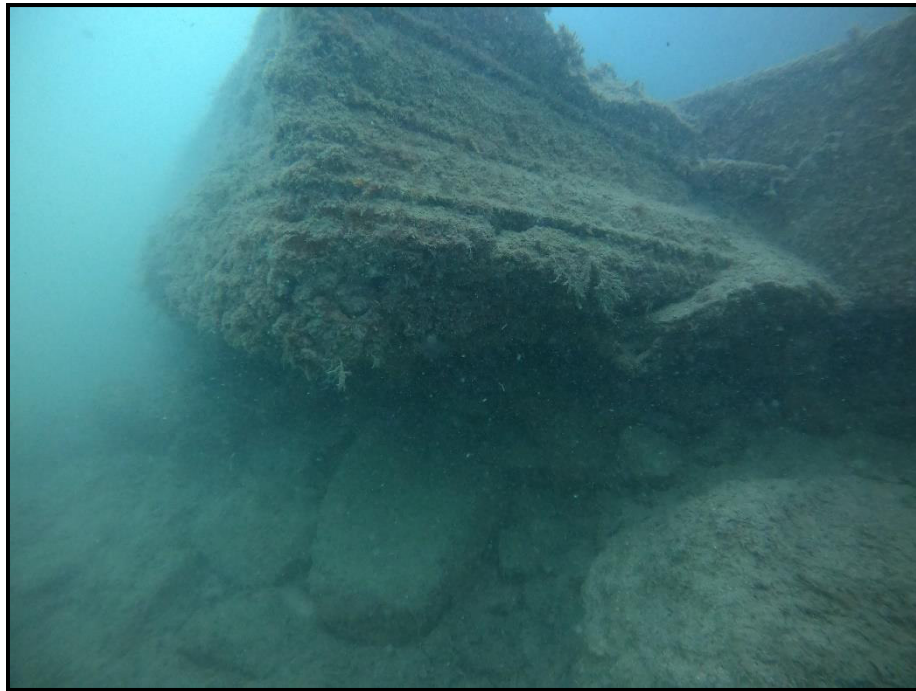
Foto N°3 Descalce en TRAMO 1
