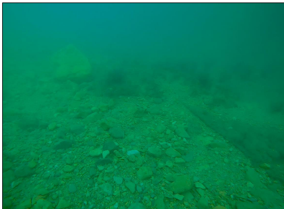
Foto viga de atado inferior al final del TRAMO 9 sepultada por gravas y piedras
