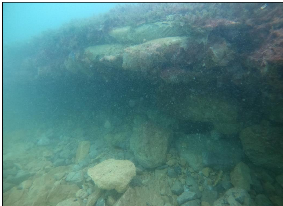
Foto N°18 Descalce en TRAMO 11
