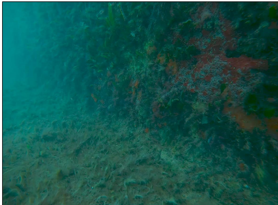
Foto junta de viga de atado con muelle de hormigón en masa TRAMO 11
