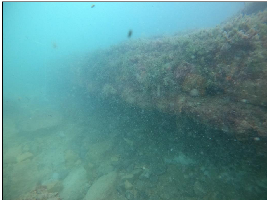
Foto N°13 Descalce en TRAMO 10
