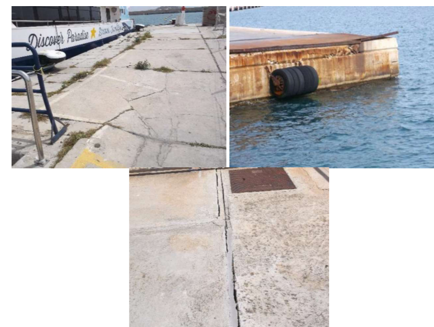
Figura 9. Ejemplo de fotografías tomadas en zonas de daños emergidos.
