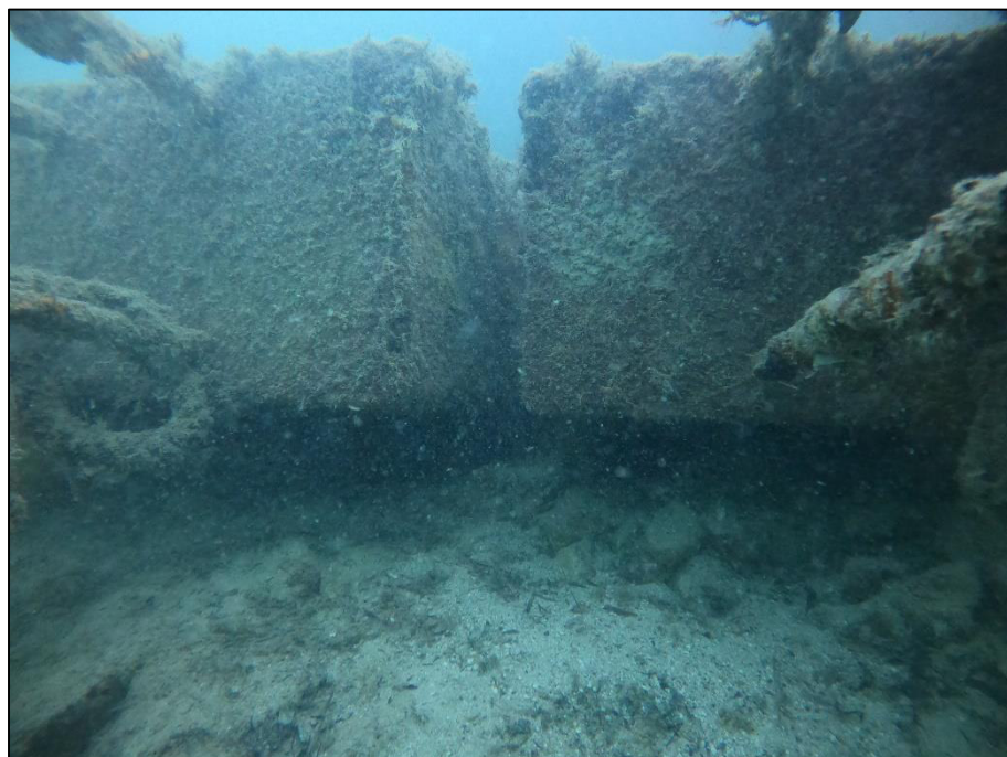
Foto N°2 Descalce en TRAMO 1
