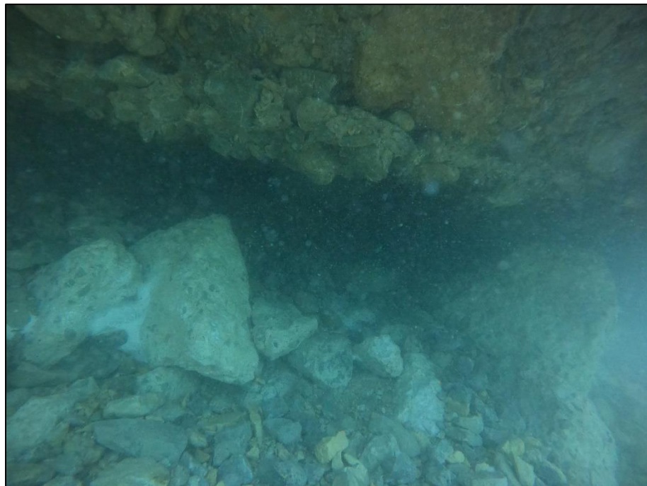
Foto N°25 Descalce en TRAMO 11
