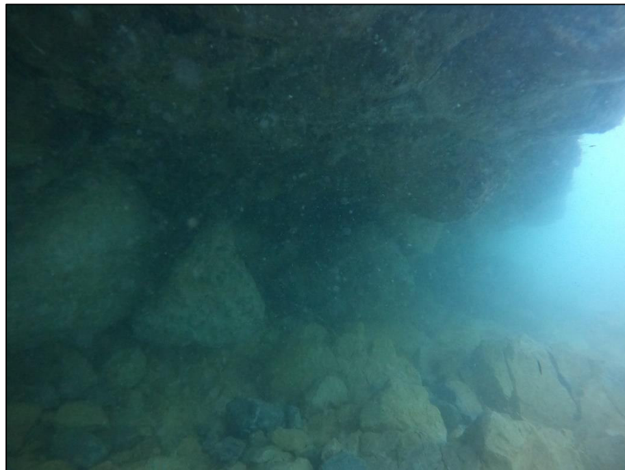
Foto N°22 Descalce en TRAMO 11
