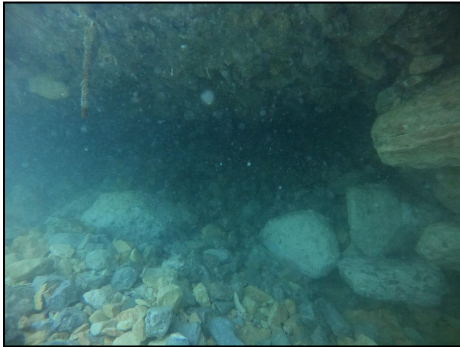
Foto N°21 Descalce en TRAMO 11
