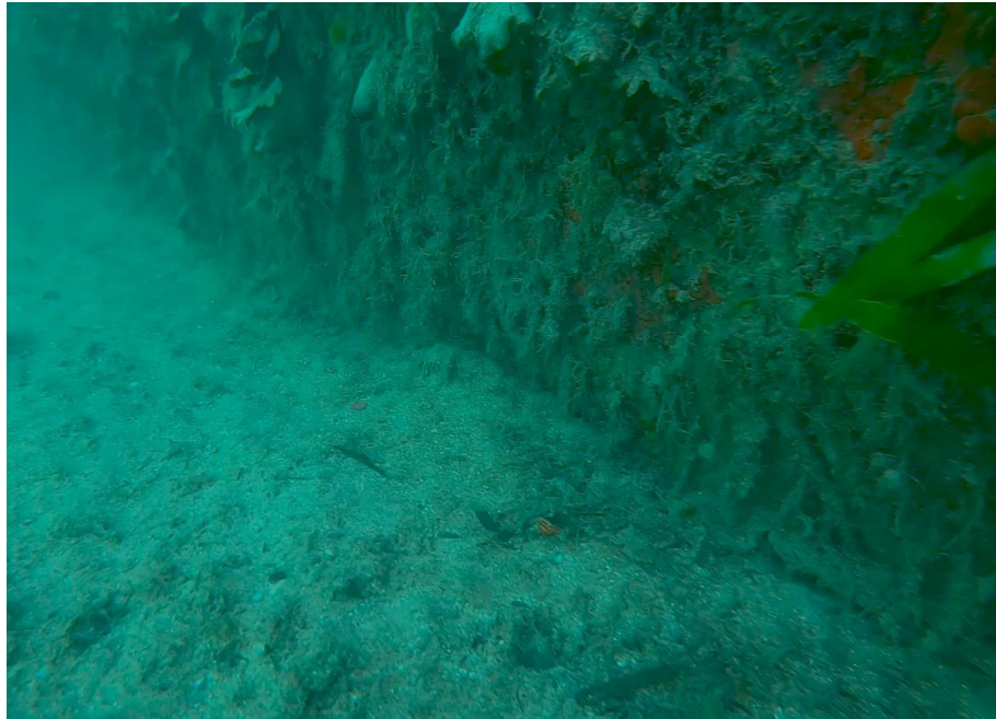
Foto junta de viga de atado con muelle de hormigón en masa TRAMO 7
