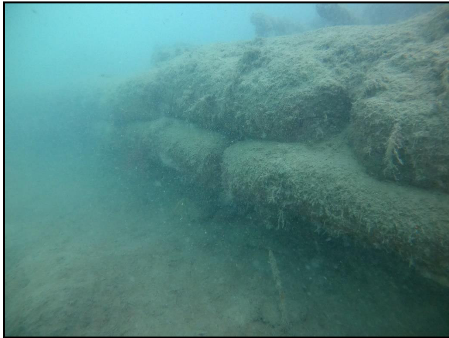
Foto N°8 Descalce en TRAMO 2
