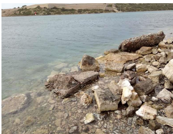
Restos en la rampa actual (11/03/2019)
