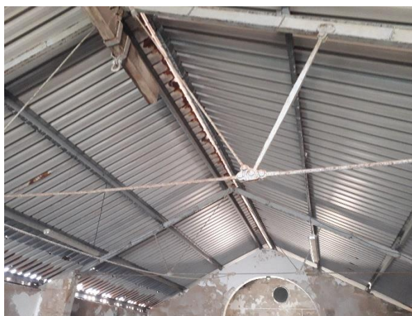
Estado de la celosía (03/06/2020)
