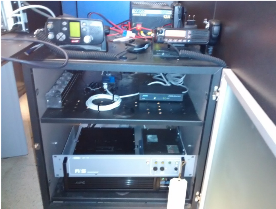
Ilustración 9. Rack AIS centro control Alcudia.
