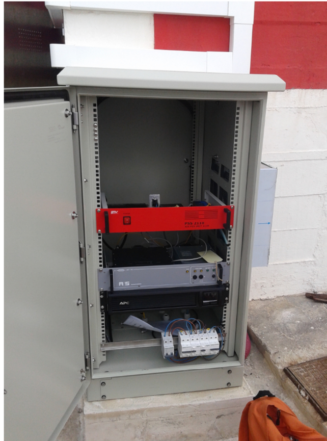
Ilustración 3. Exterior armario intemperie faro dique oeste Palma Mallorca.
