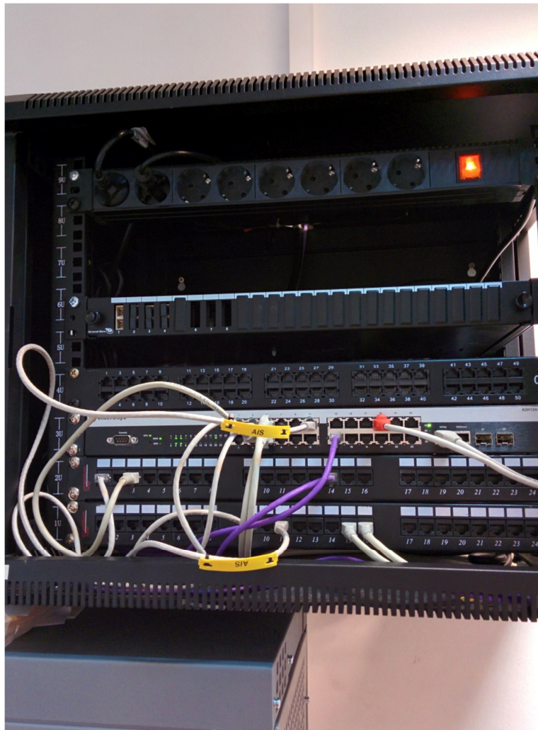
Ilustración 20 - Rack sala técnica
