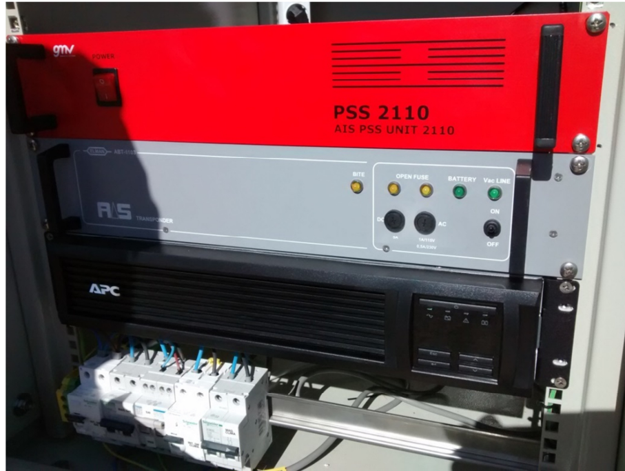
Ilustración 14. Interior armario intemperie faro San Carlos.
