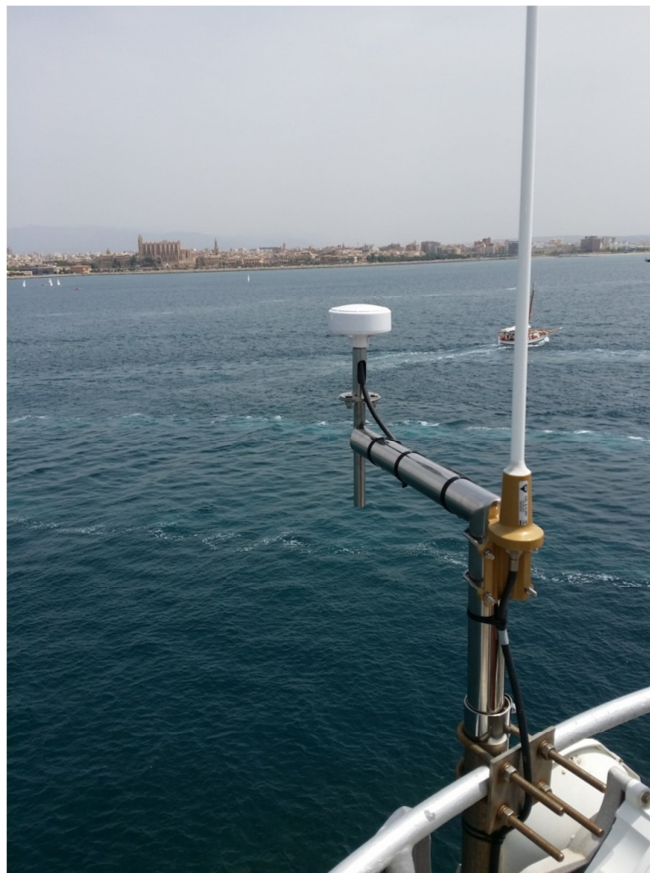
Ilustración 5. Antenas VHF y GPS faro dique oeste.
