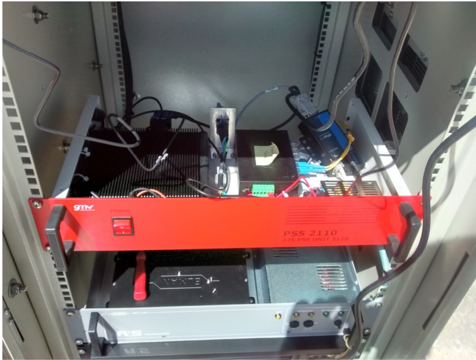
Ilustración 4. Interior armario intemperie faro dique oeste Palma Mallorca.
