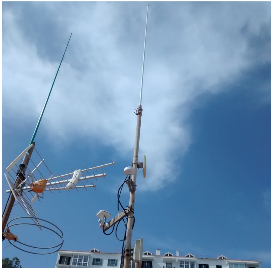
Ilustración 13. Antena GPS y VHF edificio AP Mahón.
