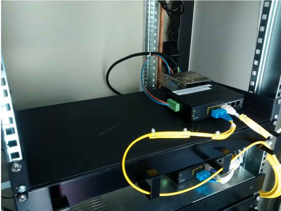
Ilustración 6. Switch IGS.511TS15 caseta nodo 7.
