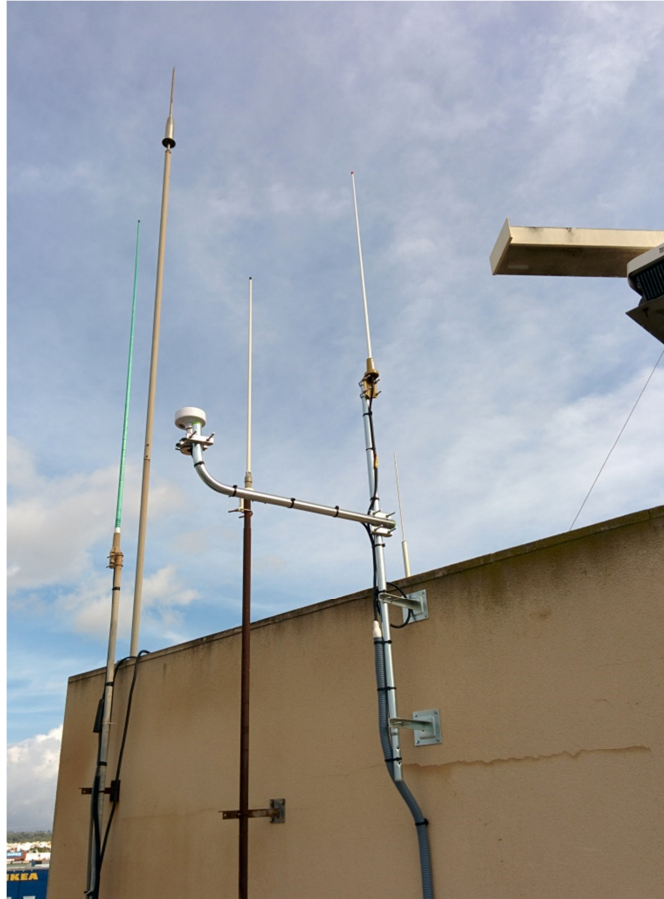
Ilustración 18 - Antenas VHF y GPS
