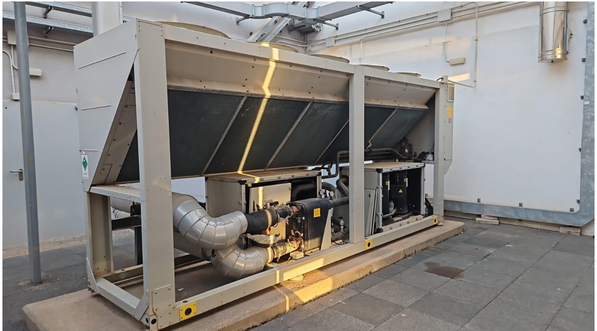
Bomba de calor:
