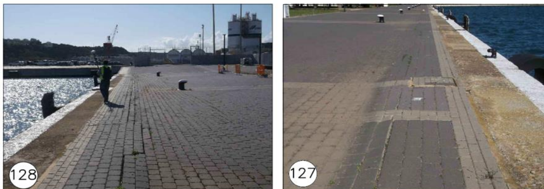
Figura 5. Condición del trasdós del muelle en 2016
