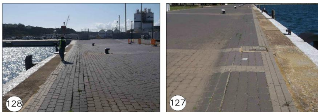
Figura 3. Condición del trasdós del muelle en 2016
