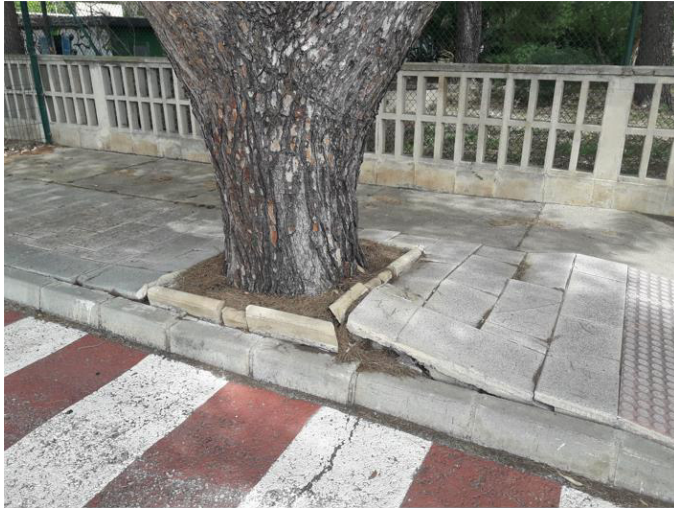
Imagen 5. Estado actual acera M. Ribera
