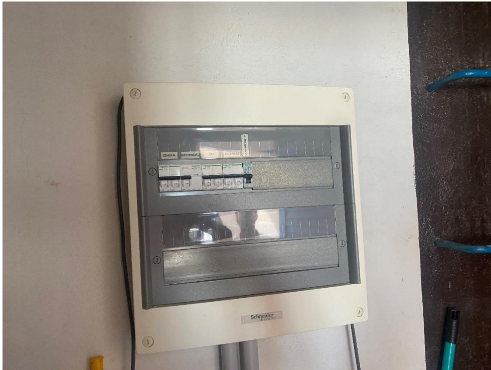
Ilustración 15 Cuadro eléctrico general en el cuartillo
