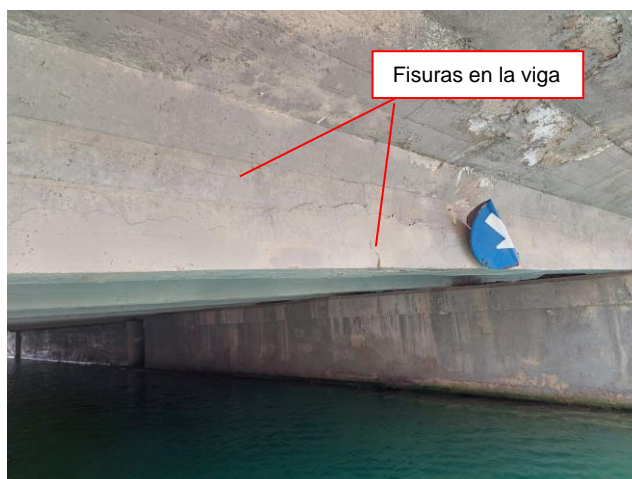
Figura. 2 Fisuras presentes en la viga
