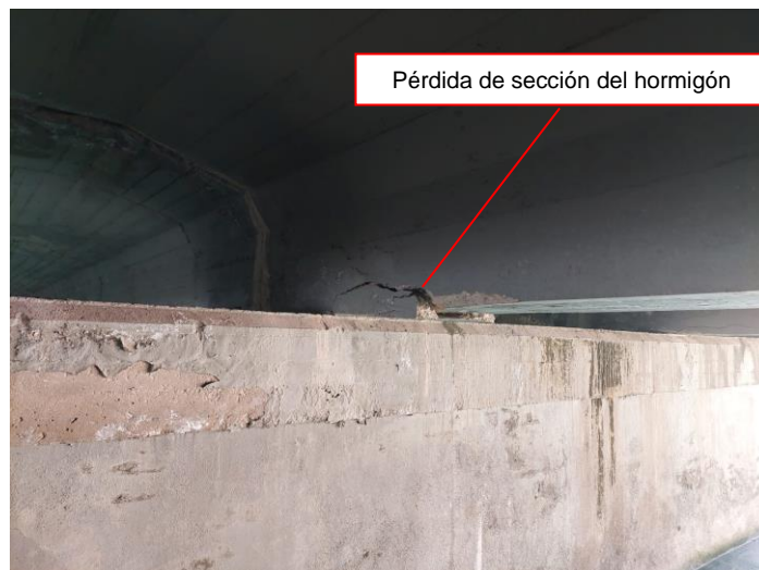
Figura. 6 Pérdida de sección en apoyo de viga
