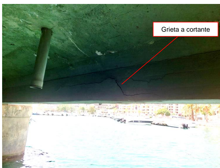
Figura. 5 Grieta debido a cortante.
