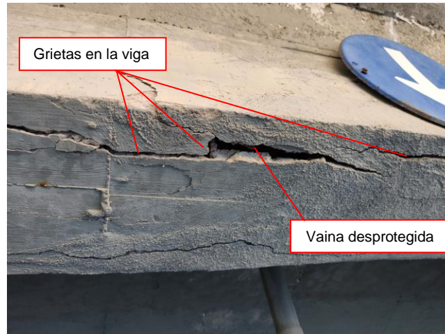
Figura. 3 Grietas presentes en cara inferior. Inspección de 2021.
