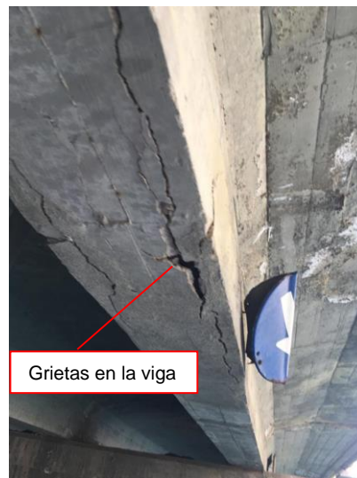
Figura. 4 Grietas presentes en cara inferior. Inspección de 2023.
