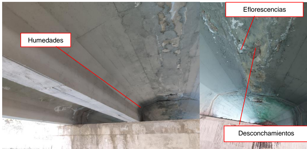
Figura. 7 Defectos en el tablero.
