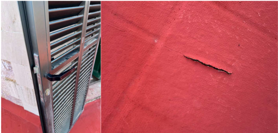
Il·lustració 8 Grietas en la cubierta y puerta de acceso
