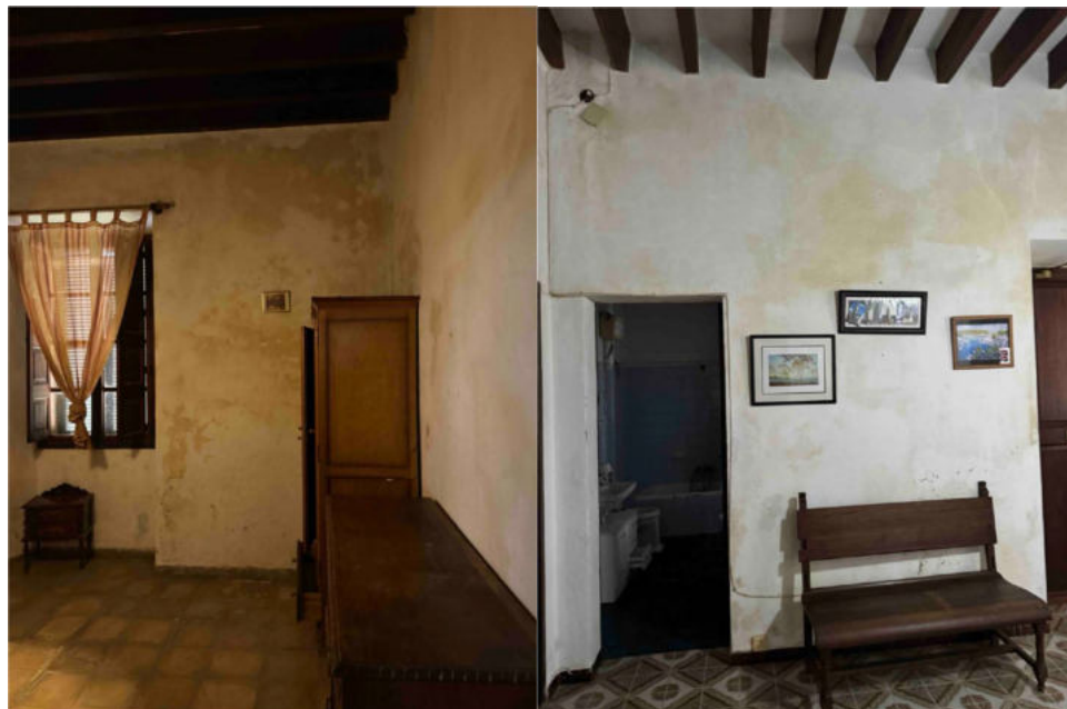
Ilustración 2 Estado interior vivienda
