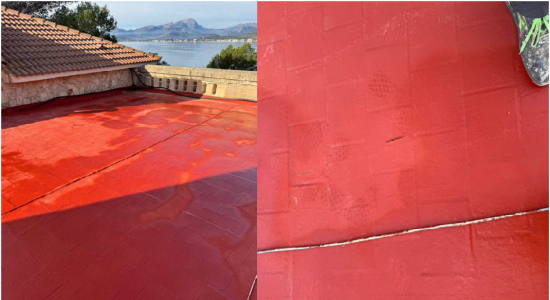
Ilustración 9 Estado de la cubierta
