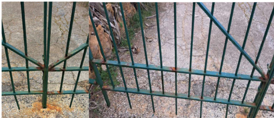
Ilustración 11 Estado de la puerta de acceso al faro
