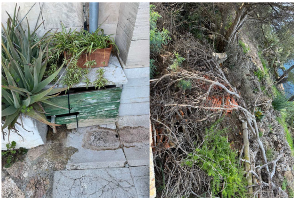
Il·lustració 6 Elementos en mal estado
