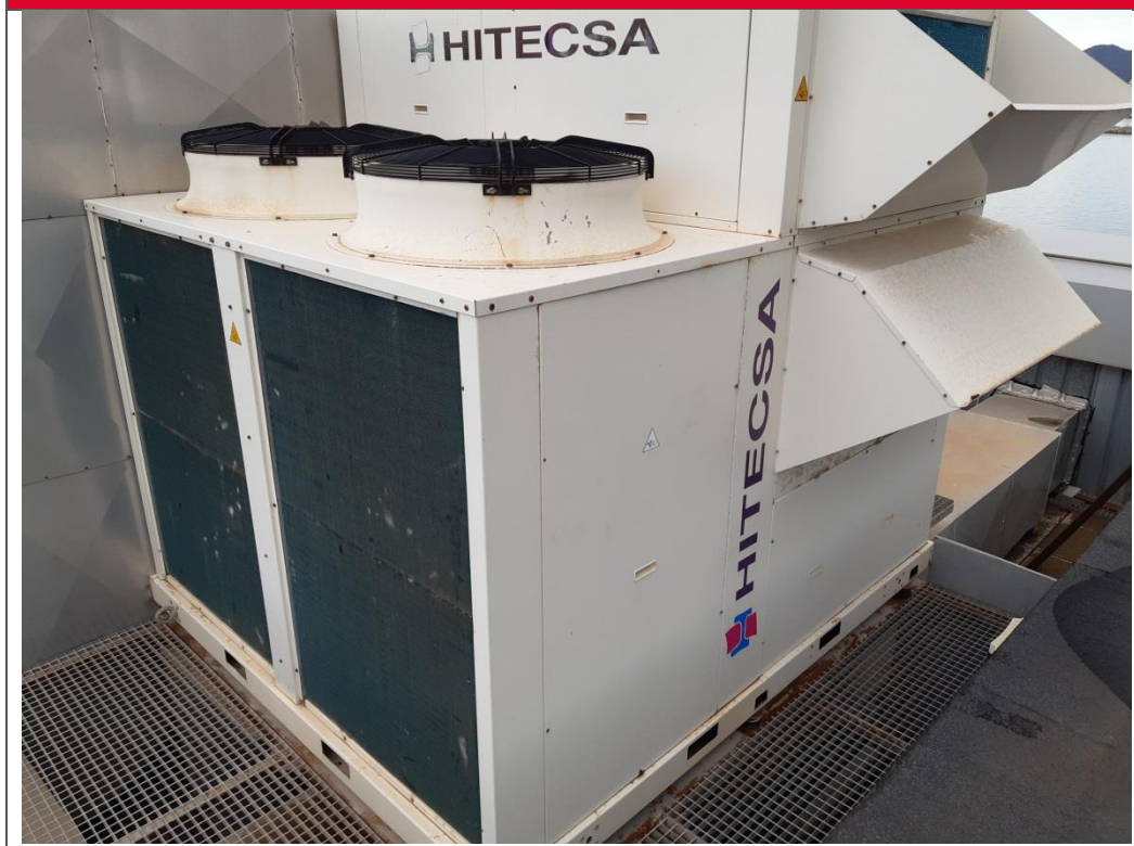
Bomba de calor de expansión directa tipo rooftop para la climatización del Hall principal del edificio
