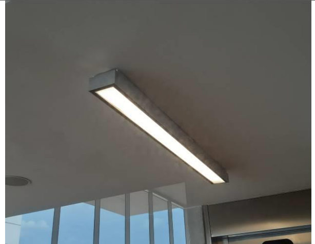
Luminarias con tubo fluorescente tipo T5 en oficinas y salas de espera
