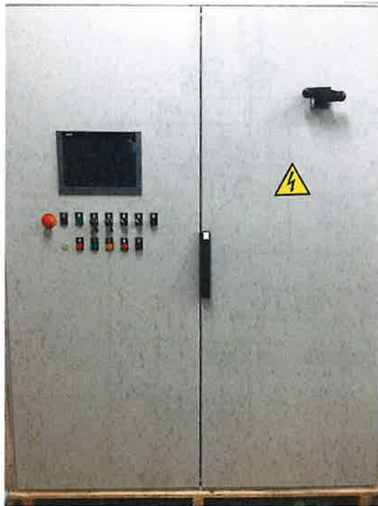
Ilustración 9: exterior del cuadro electrico principal
