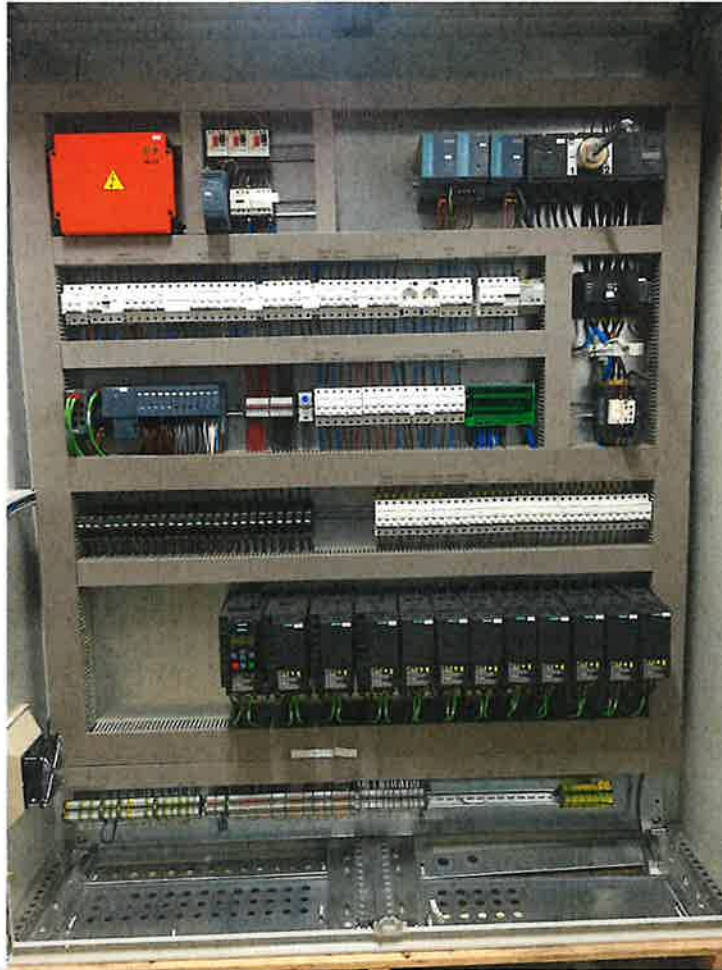
Ilustración 10: interior cuadro eléctrico
