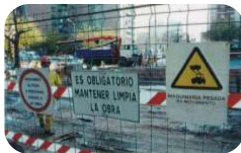
Ejemplo: señalización en zonas de obras
