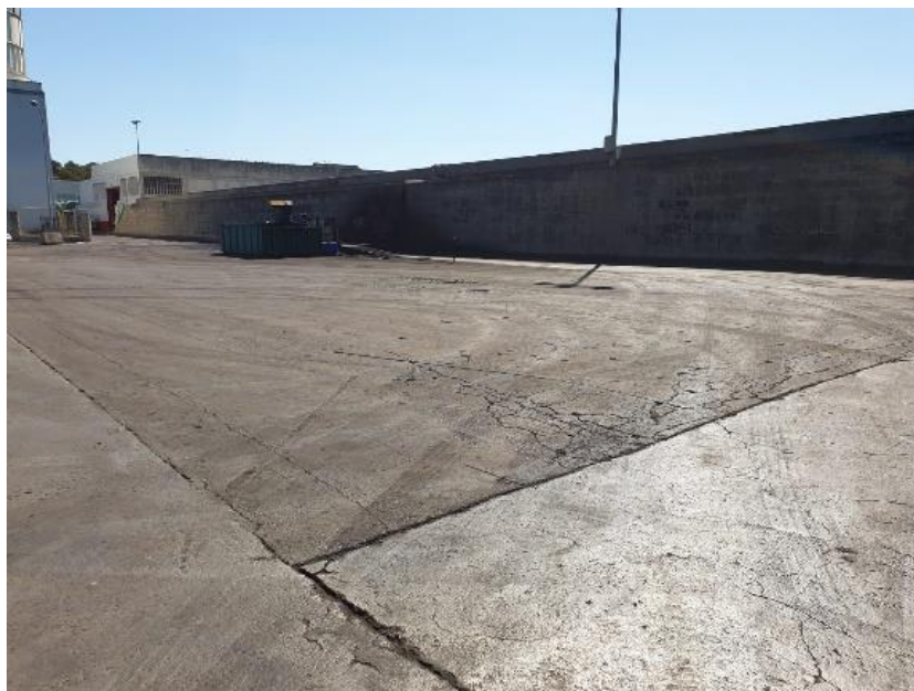
Ilustración 14 Estado del firme
