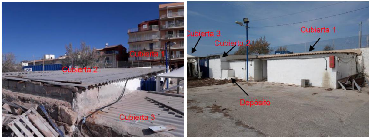
Fotografía 1. Cubiertas y depósito de fibrocemento existentes en almacenes del Puerto del Molinar
