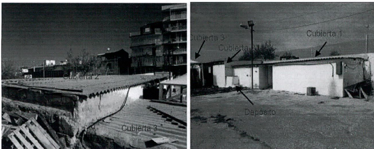
Fotografía 1. Cubiertas y depósito de fibrocemento existentes en almacenes del Puerto del Molinar
