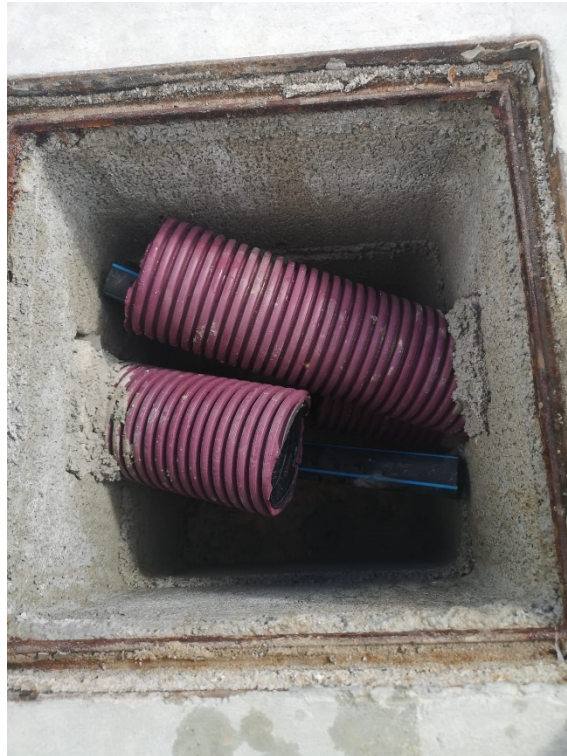
22 Detalle prisma de canalizaciones
