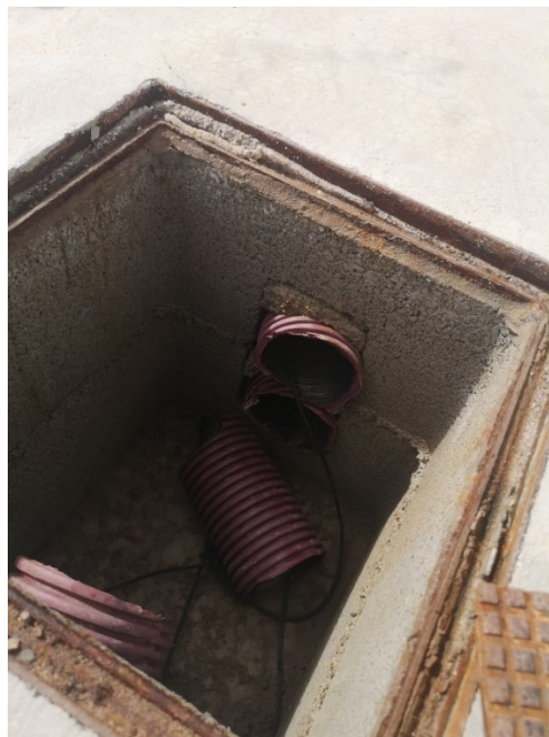
23 Detalle prisma de canalizaciones.
