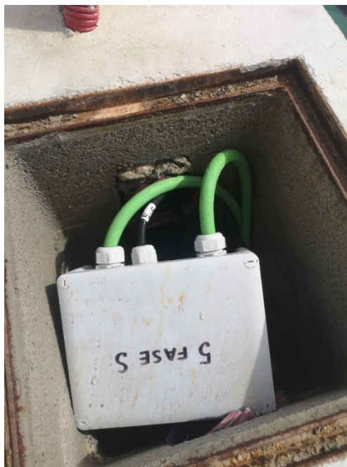
21 Detalle arqueta prisma de canalizaciones.
