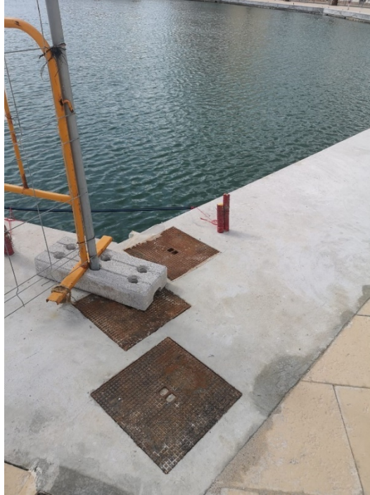
20 Arquetas de registro prisma de canalizaciones.
