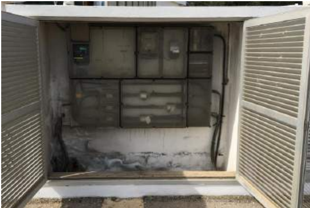
Figura 23.- Batería de contadores.
