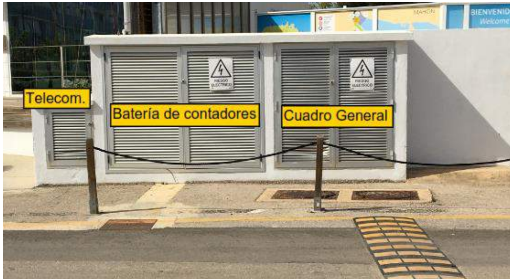
Figura 15.- Detalle de los armarios de instalaciones.
