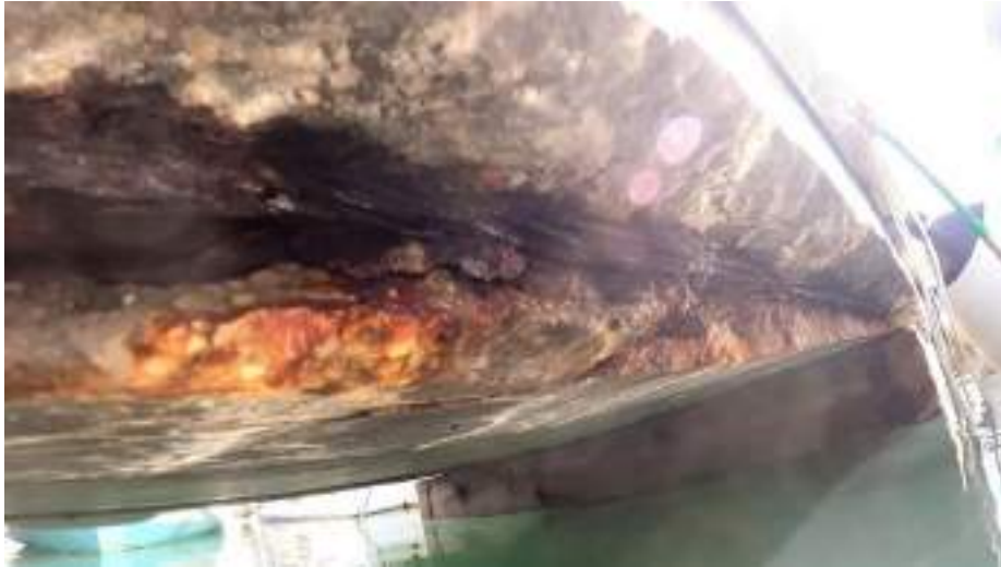
Figura 8.- Detalle de patología en una de las losas de hormigón del pantalán 4.
