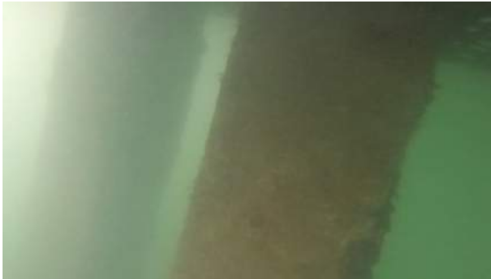
Figura 9.- Detalle de dos de los pilotes en el pantalán 7.
