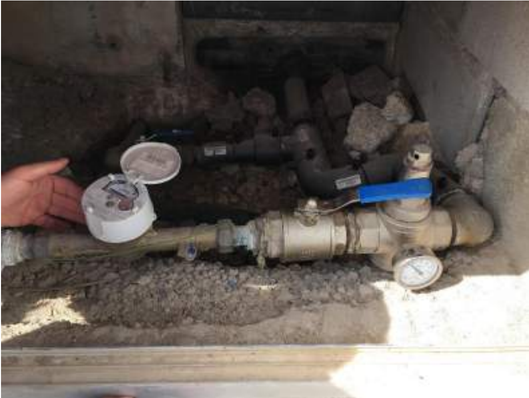
Figura 18.- Detalle de ubicación de la acometida y el contador de la instalación.
