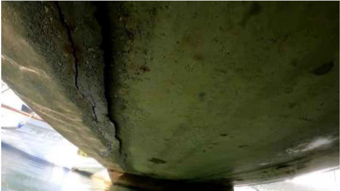
Patología en una de las losas de hormigón del pantalán 1.
