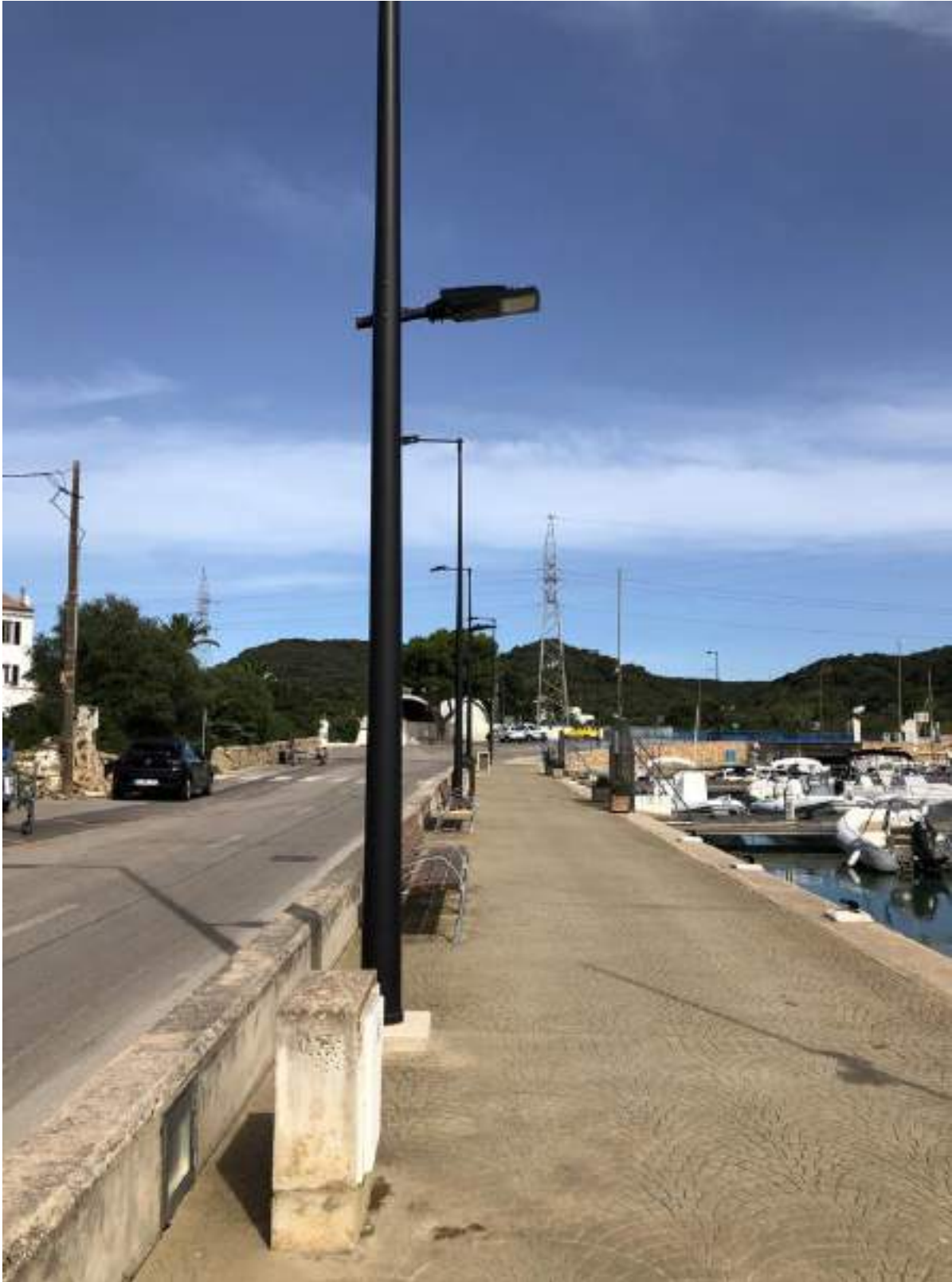
Figura 14.- Baculos y luminarias actuales del moll de Colársega a mantener.
