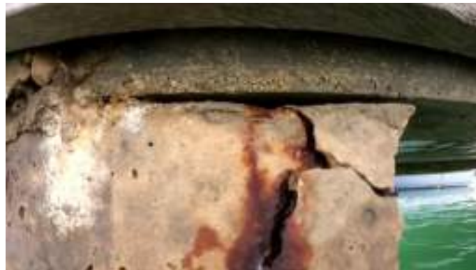
Patología en una de las vigas de encepado del pantalán 4
