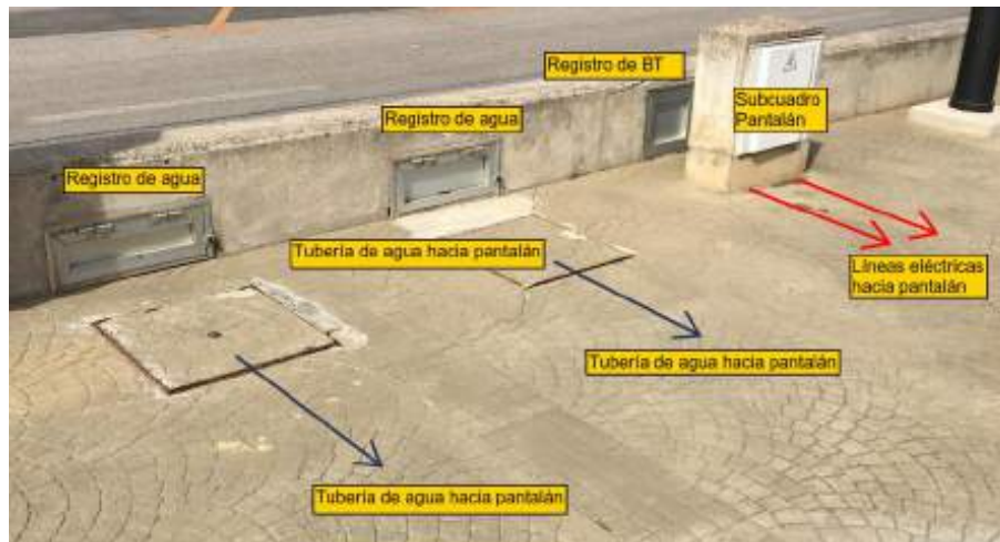
Figura 14.- Detalle de derivaciones eléctricas y de agua potable hacia uno de los pantalanes.
