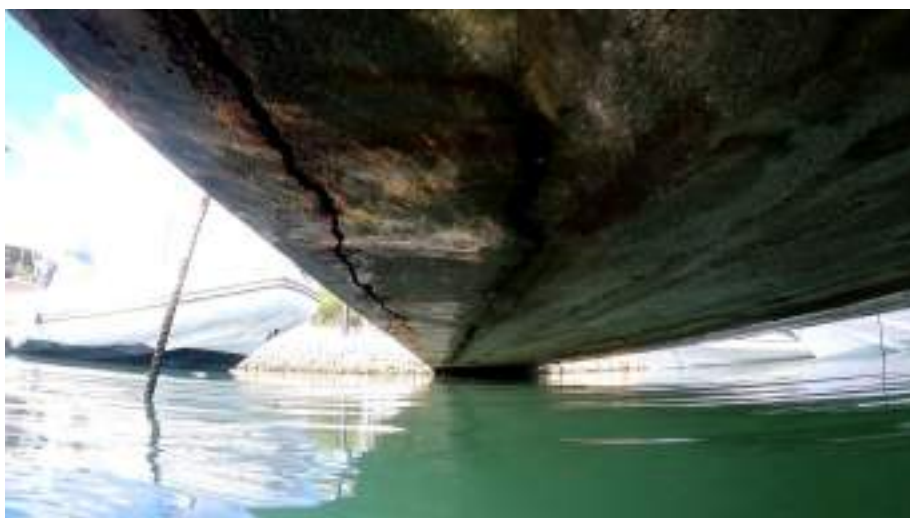
Figura 7.- Detalle de patología en una de las losas de hormigón del pantalán 2.
