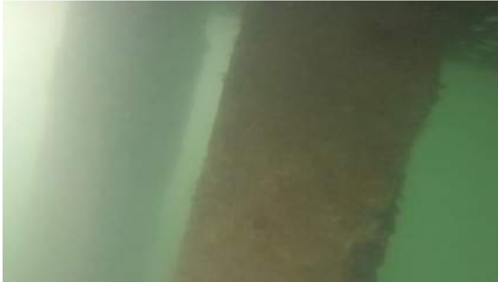
Figura 3.- Detalle de dos de los pilotes en el pantalán 7.
