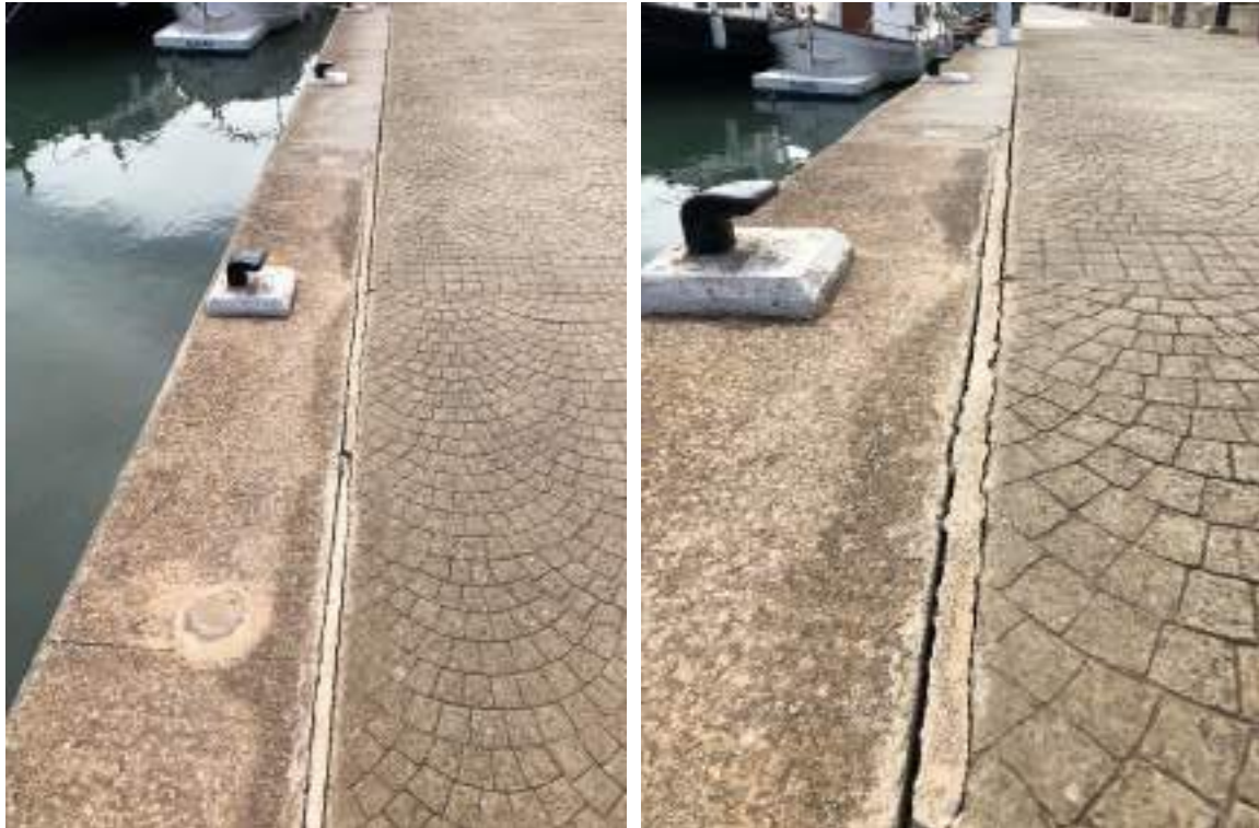
Figura 5.- Detalles de patologías del muelle.
