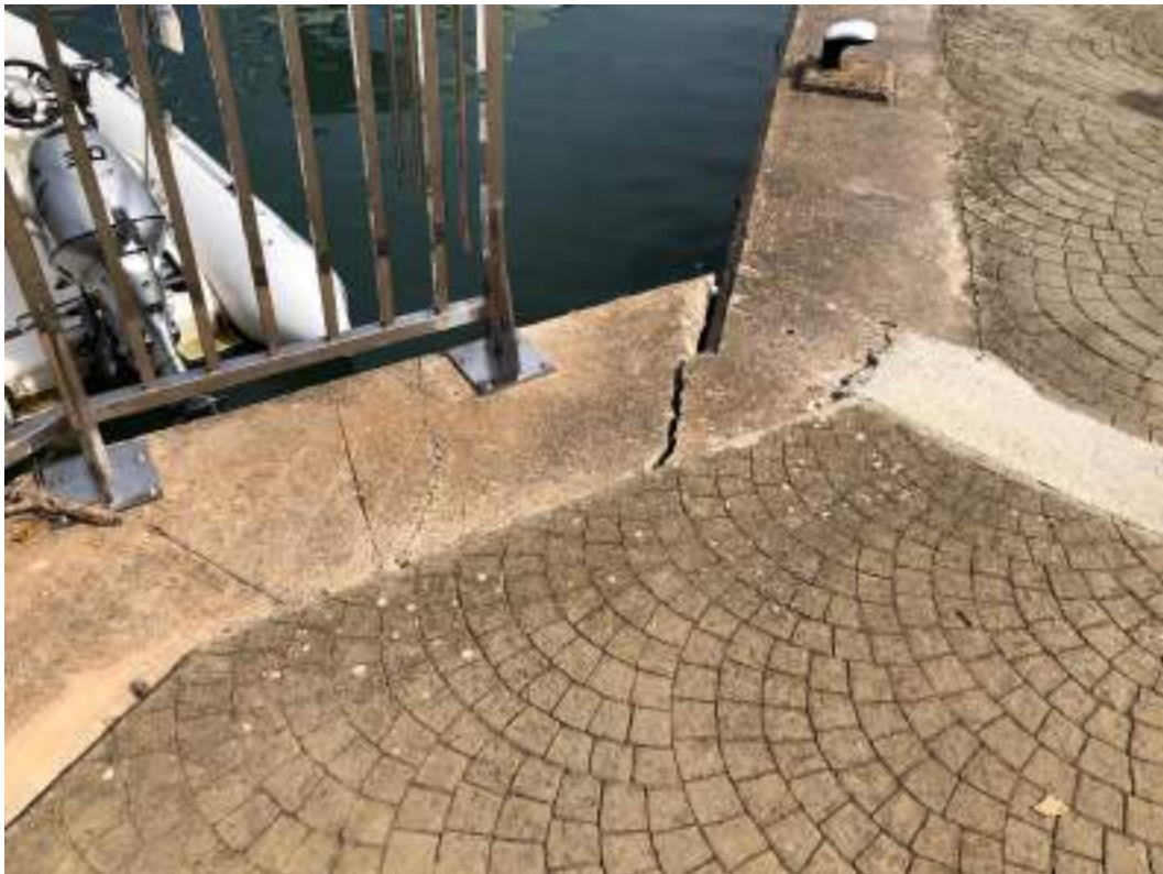
Figura 6.- Detalle de patologías del muelle
