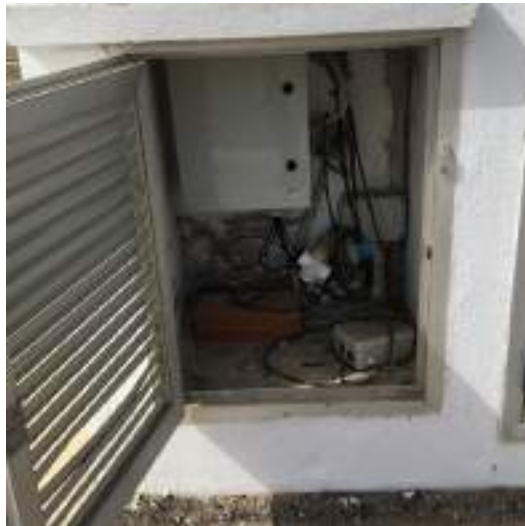
Figura 29.- Detalle del armario de telecomunicaciones.
