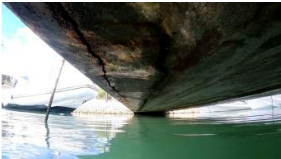
Figura 2.- Detalle de patología en una de las losas de hormigón del pantalán 2.
