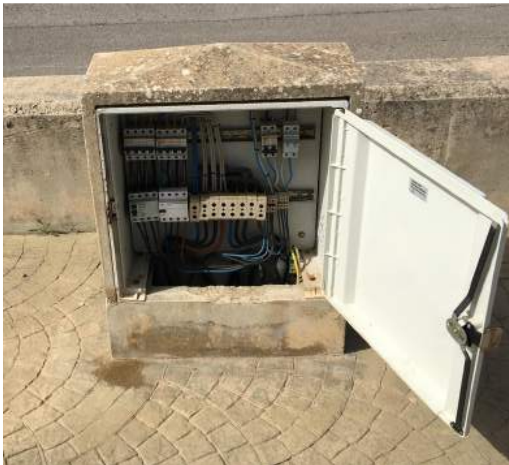
Figura 26. - Subcuadro eléctrico de pantalán.
