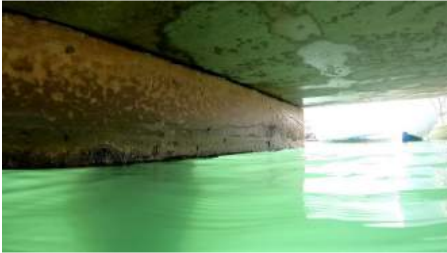
Patología en vigas y losas del pantalán 3
