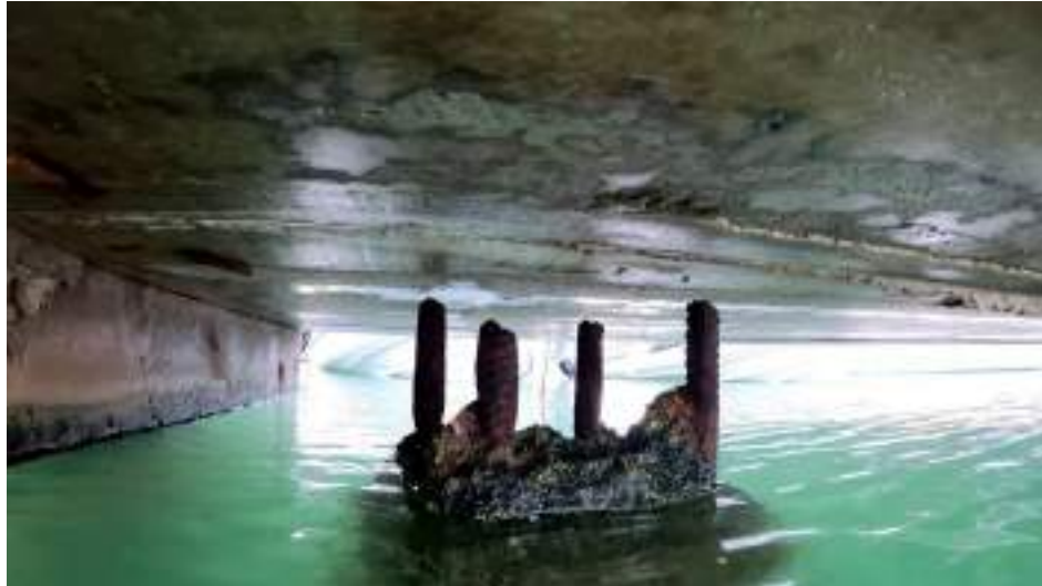
Detalle del pilote sin uso bajo el pantalán 2.
