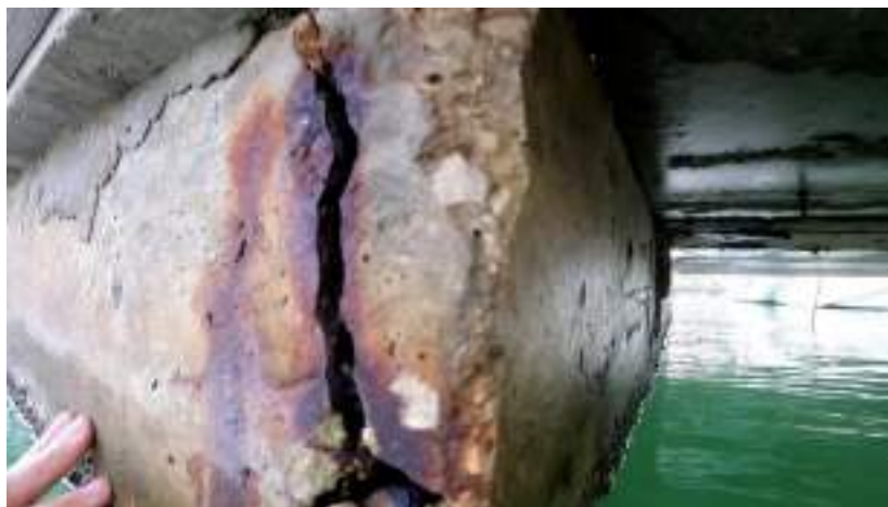
Patología en una de las vigas de encepado del pantalán 2.
