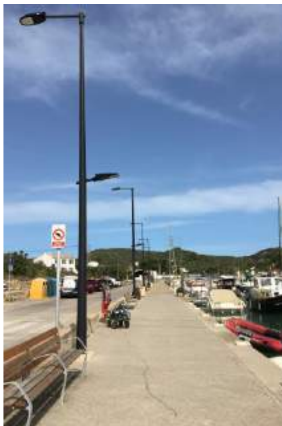
Figura 32.- Vista del alumbrado público existente en el muelle de la Colársega.
