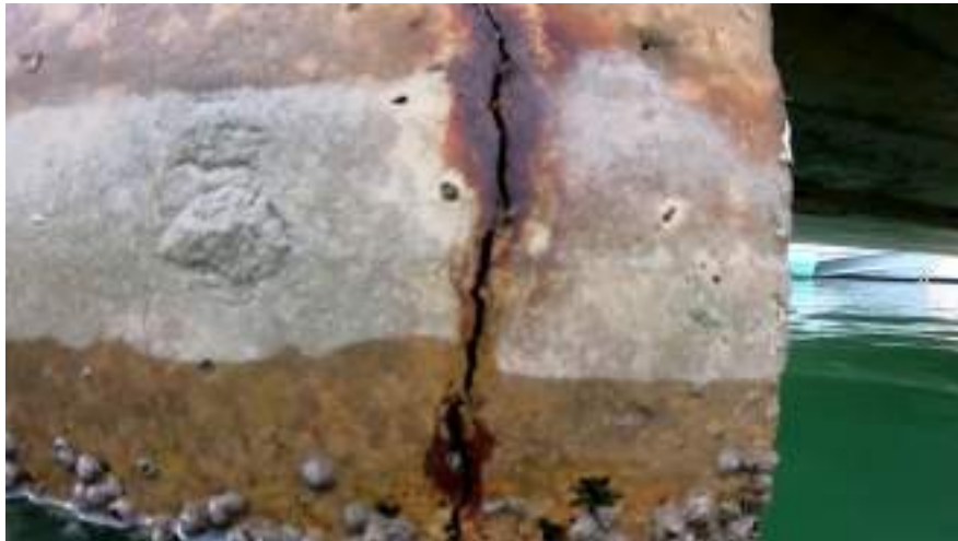
Patología en una de las vigas de encepado del pantalán 3
