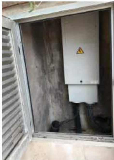
Figura 21.- Detalle de la caja general de protección.
