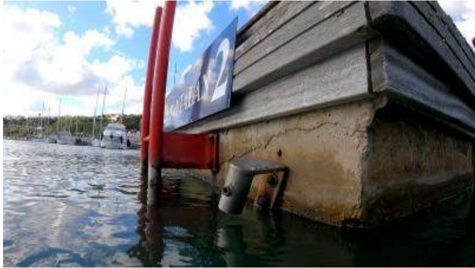
Detalle de la escalera adosada al pantalán 2.
