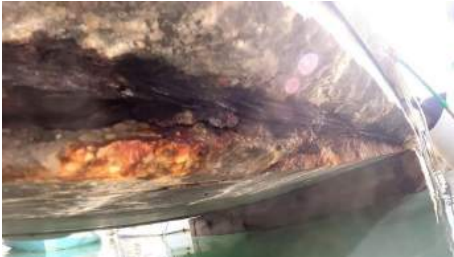
Figura 12.- Detalle de patología en una de las losas de hormigón del pantalán 4.
