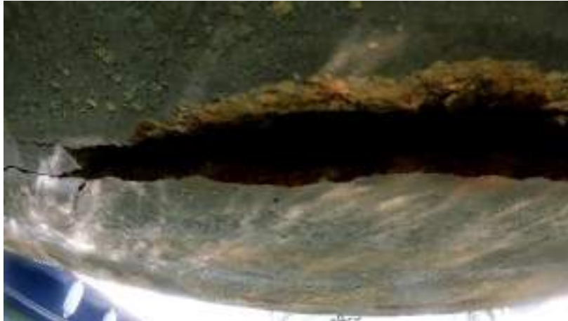
Patología en una de las losas de hormigón del pantalán 2.
