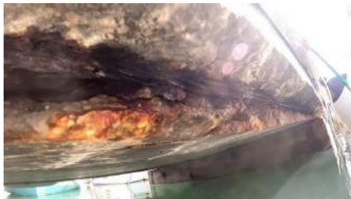
Patología en una de las losas de hormigón del pantalán 4
