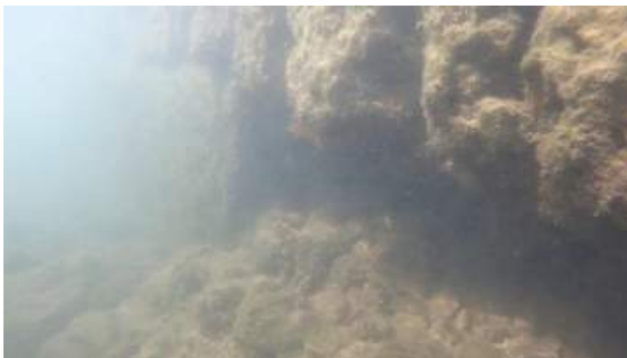
Figura 3.- Patología detectada en el tramo de muelle entre los pantalanes 2 y 3.
