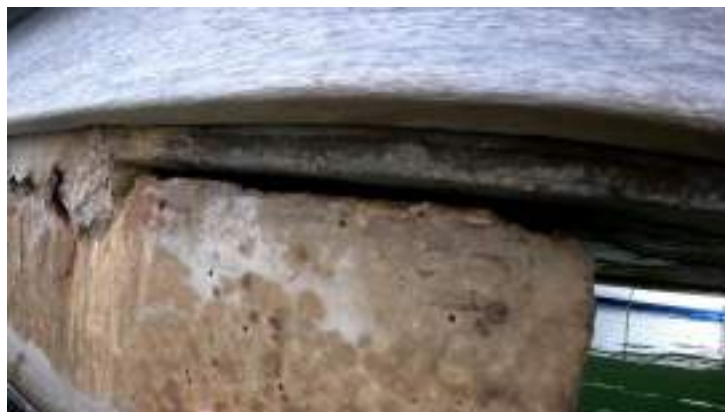
Patología entre una de las vigas de encepado y una losa de hormigón del pantalán 3
