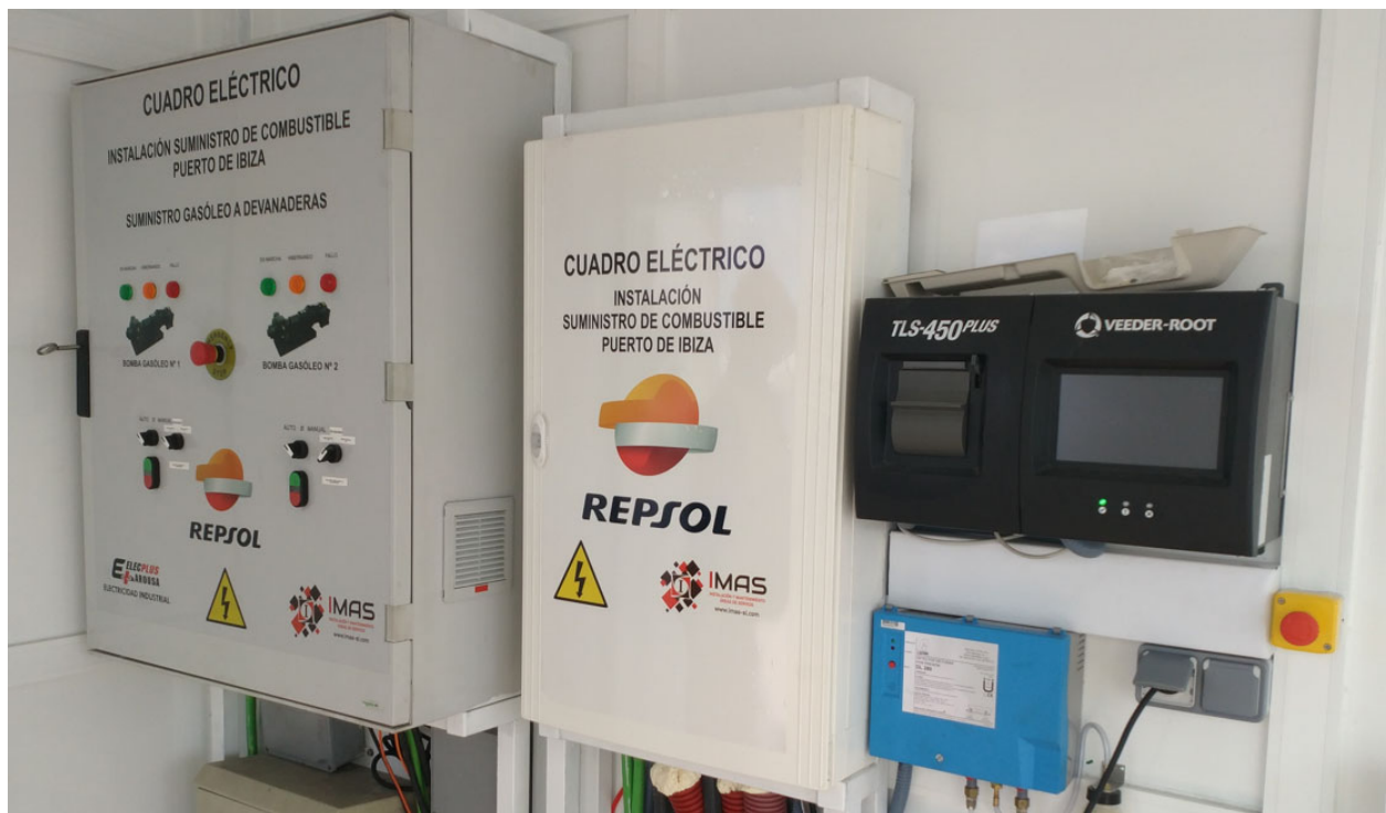
Cuadro general, cuadro secundario, Veeder Root, sistema de detección de fugas
