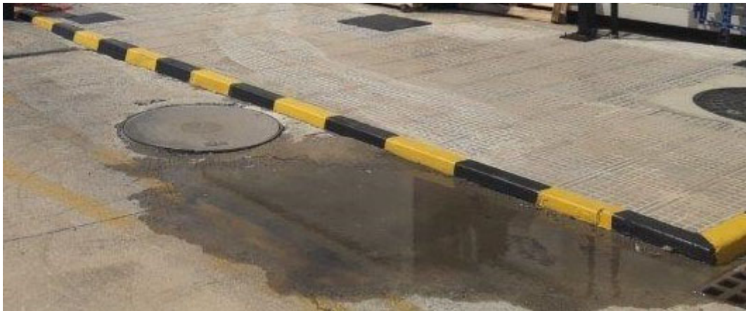
Zona de acumulación de agua e imbornal existente
