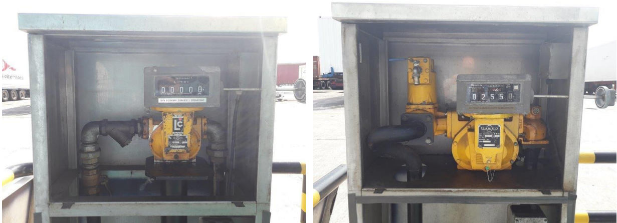
Equipos de medida en dispensadores
