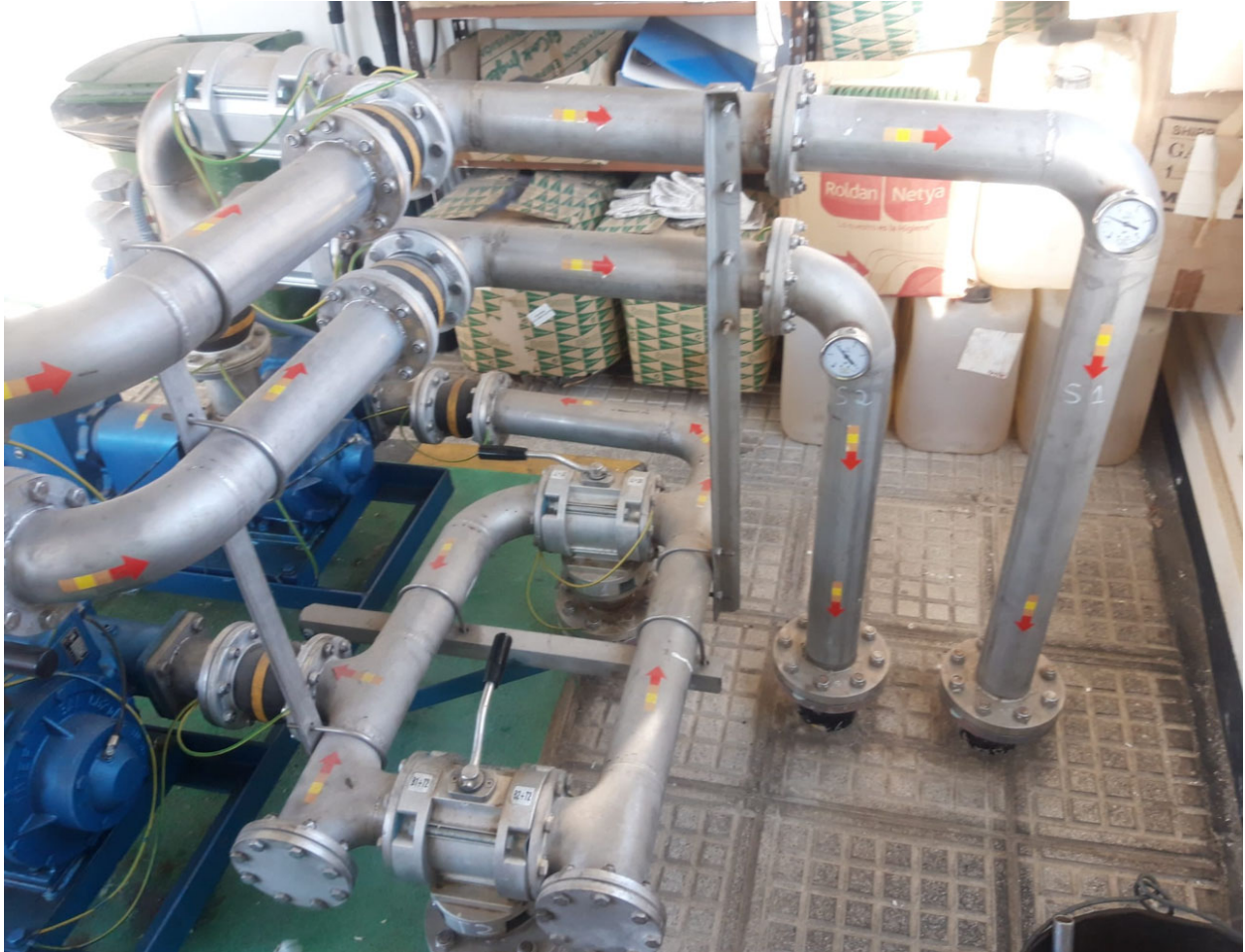
Colector y juego de válvulas en INOX dentro de caseta de bombas
