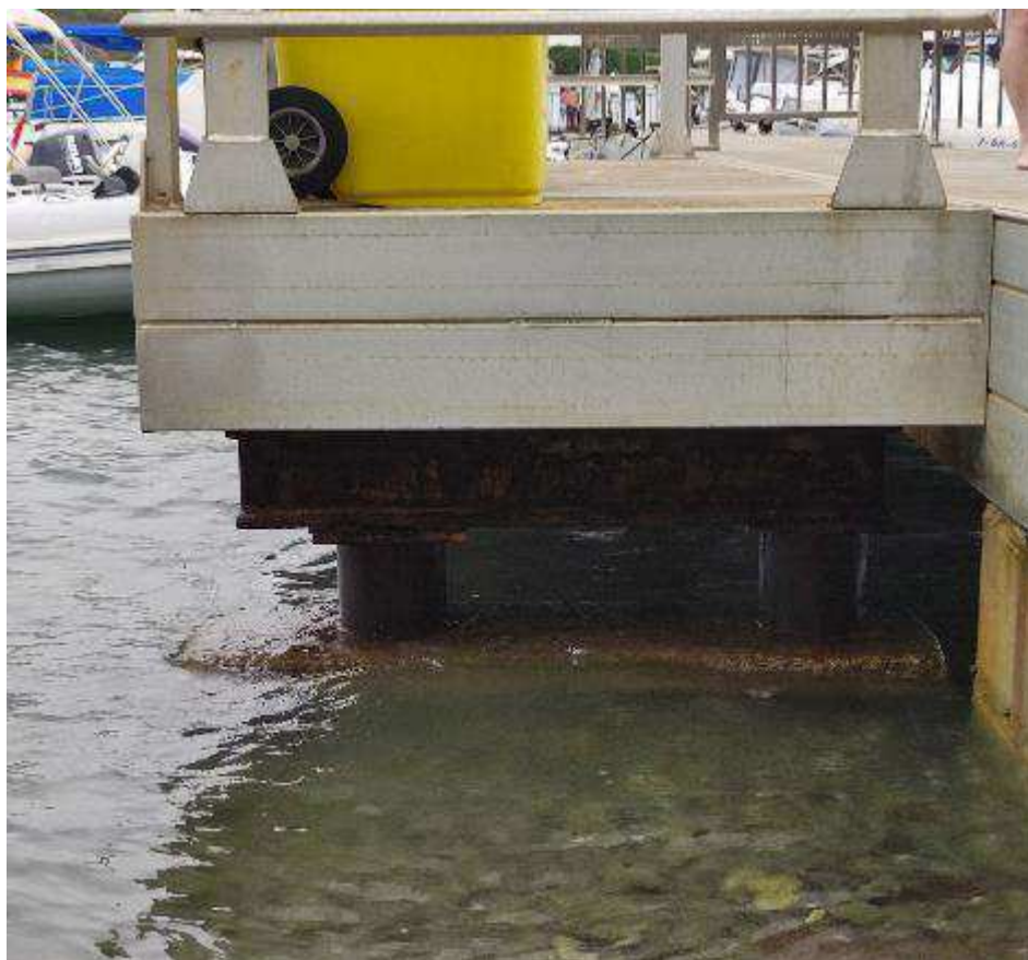
Figura 7. Viga cargadero y placas e apoyo dañadas en avanzado estado de corrosión, en P-B/P-C
