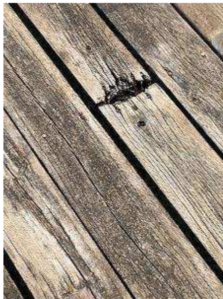
Figura 13. Estado pavimento plataformas
