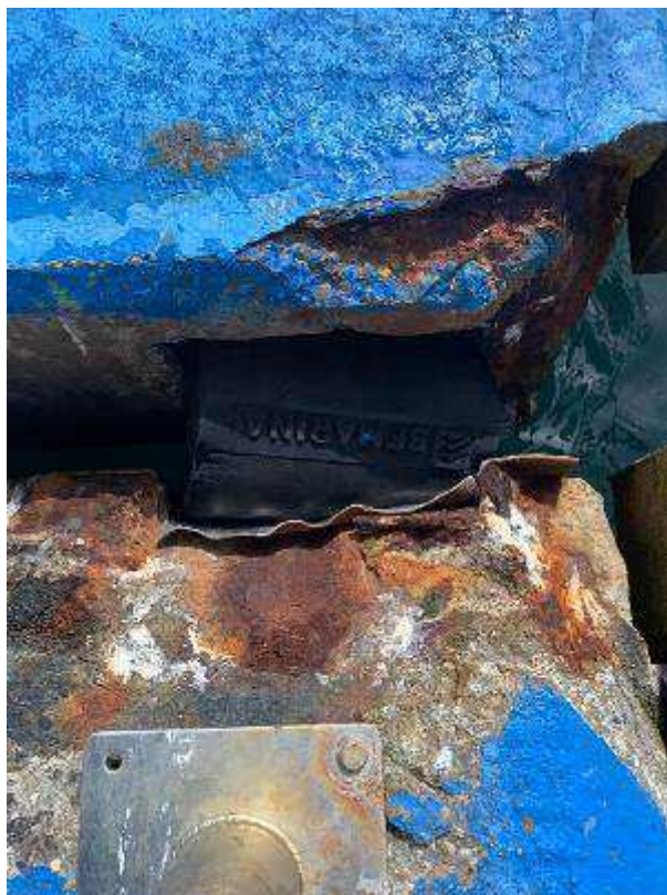
Figura 9. Daño en anclaje entre módulos de pantalán flotante en Isla del Rey
