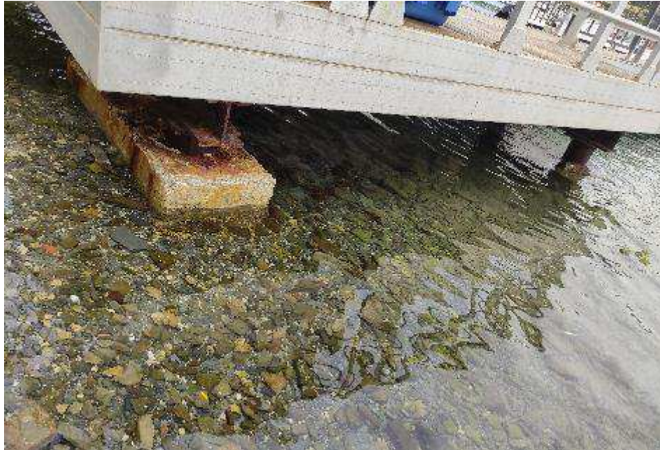
Figura 10. Viga cargadero dañada en avanzado estado de corrosión, en P-B/P-C
