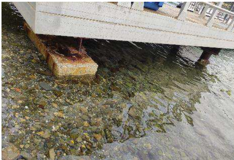
Figura 6. Viga cargadero dañada en avanzado estado de corrosión, en P-B/P-C
