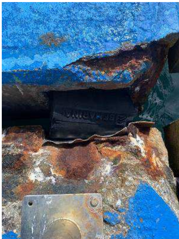
Figura 5. Daño en anclaje entre módulos de pantalán flotante en Isla del Rey
