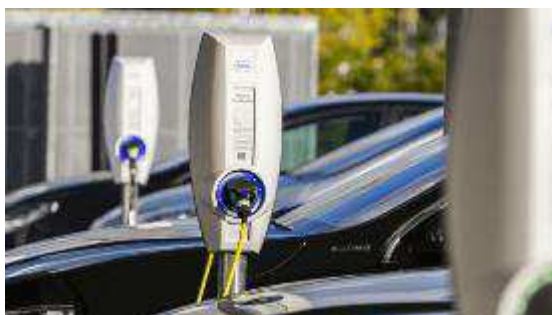
Figura 13. Ejemplo de punto de recarga de vehículos eléctricos
