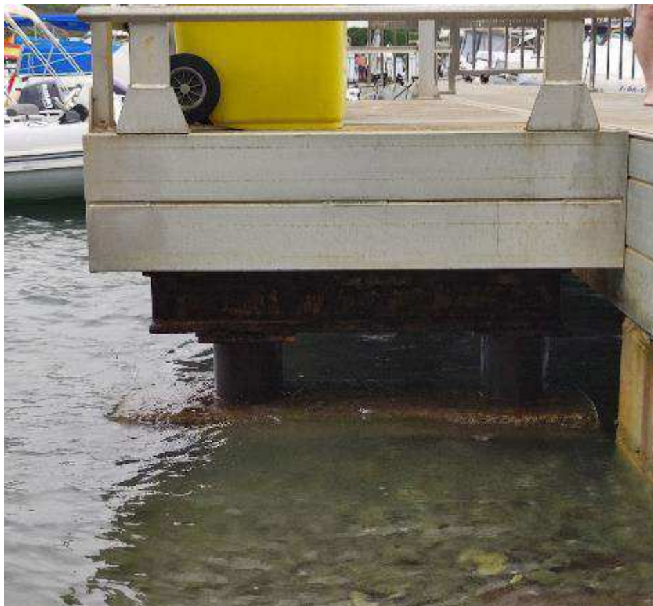
Figura 11. Viga cargadero y placas e apoyo dañadas en avanzado estado de corrosión, en P-B/P-C
