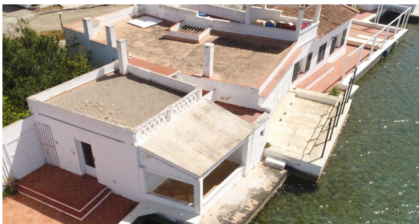
Figura 8.- Desperfectos presentes en fachadas y cubiertas edificios 6 y 7 en parcelas 5 y 6.
