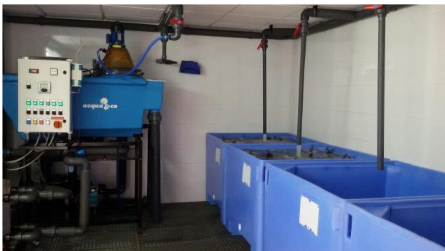
Figura 5.- Depuradora y sistema de depuración instalado.
