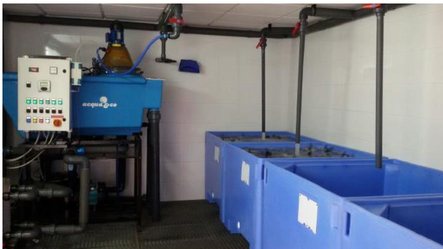
Figura 5.- Depuradora y sistema de depuración instalado.
