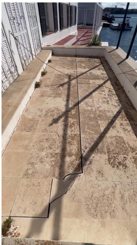
Figura 5.- Grieta en terraza del edificio 7.
