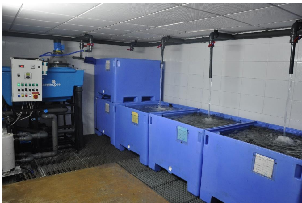
Figura 13.- Sala de depuración.
