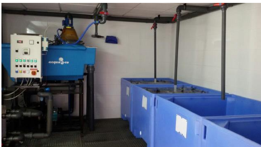
Figura 2.- Depuradora y sistema de depuración instalado.
