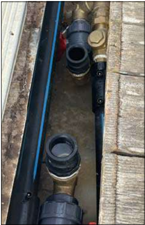
BOCA DE DESCARGA EN CANALETA DE PANTALÁN FLOTANTE
