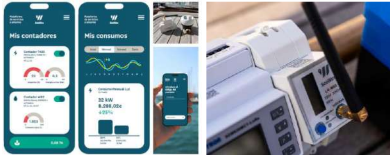
Figura 2. Innovador sistema inalámbrico de monitorización de consumos en torretas.
