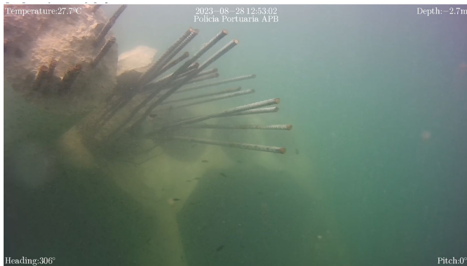
Figura 16. Bloque de la pila P-6. Rotura de pasadores.
