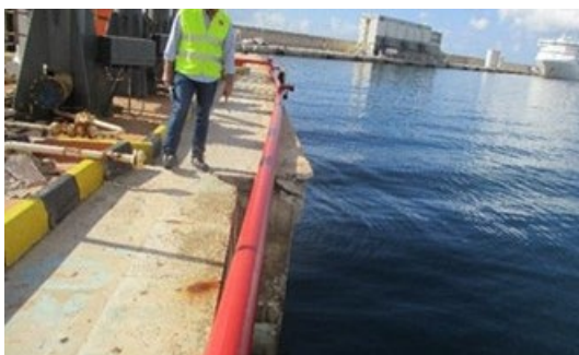
Figura 10. Desviación entre P-4 y el vano de vigas que la unen con la P-5 (~80cm)
