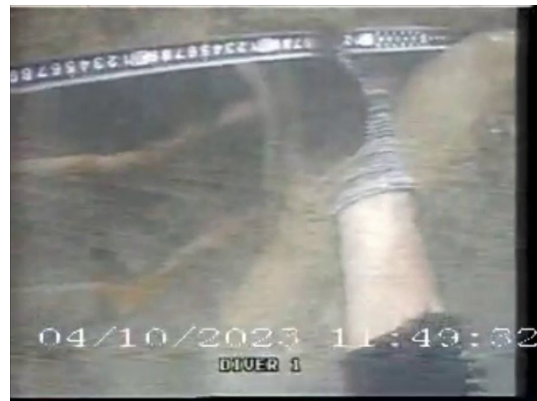
Figura 26. Daños en P-5, lado dique (bloque 2)
