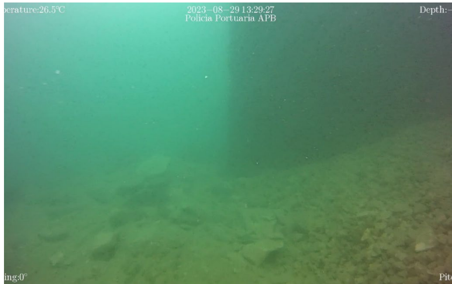
Figura 24. Escombros presentes en el lateral norte de la pila P-5
