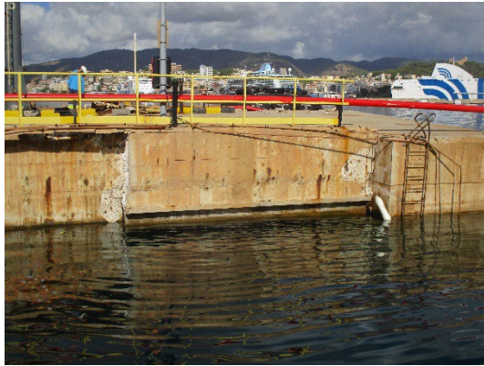
Figura 28. Desplazamiento vigas de apoyo entre pila P-4 y P-5
