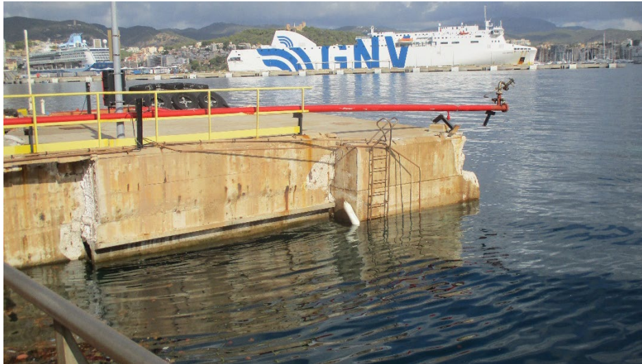
Figura 8. Pila P5 y vano P4-P5 desplazados.
