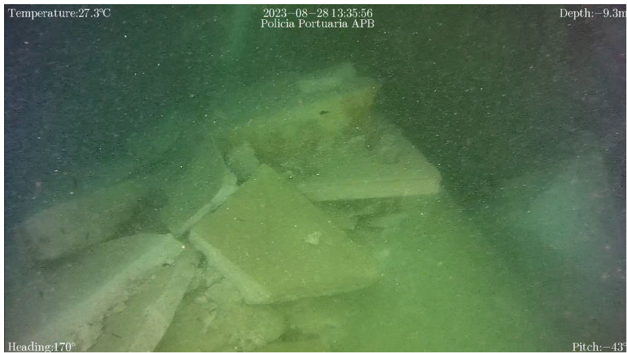
Figura 12. Captura del tablero de conexión entre pilas P-5 y P-6 con restos de la junta y superestructura
