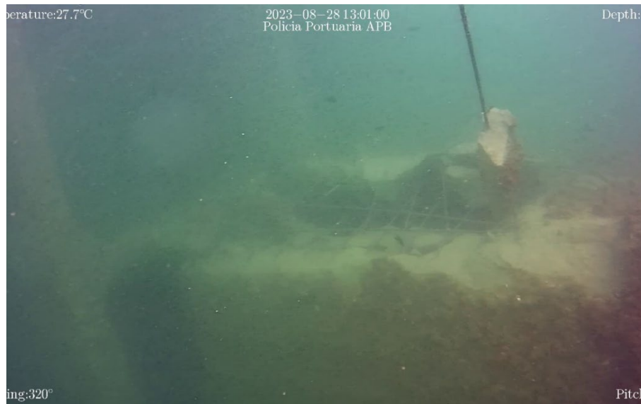
Figura 14. Daños en la estructura de la pila P-6
