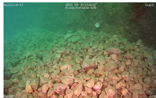
Figura 23. Restos de grava en apoyo en zona norte de la pila P-5
