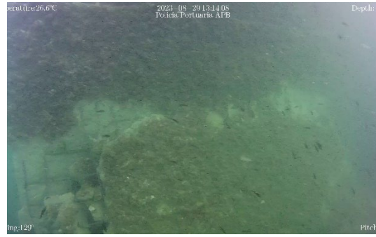
Figura 18. Daños en la estructura lateral de la pila P-5 (2)
