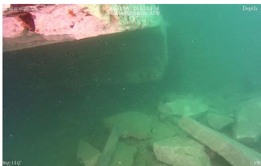
Figura 22. Restos y tablero vano P5-P6 esquina noroeste de la pila P-5
