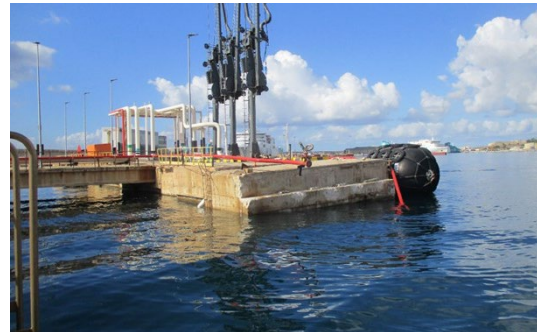
Figura 4. Vista general de la plataforma (lado norte) después del incidente
