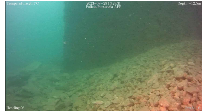
APOYO DE PILA P5 DESPLAZADO HACIA EL TALUD DE BANQUETA
