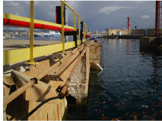
Figura 29. Desplazamiento vigas de apoyo entre pila P-4 y P-5 (2)
