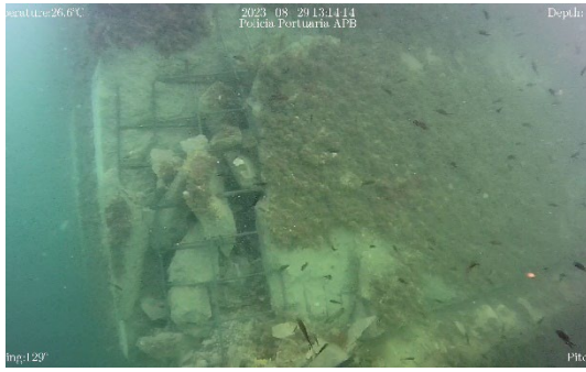
Figura 17. Daños en la estructura frontal de la pila P-5
