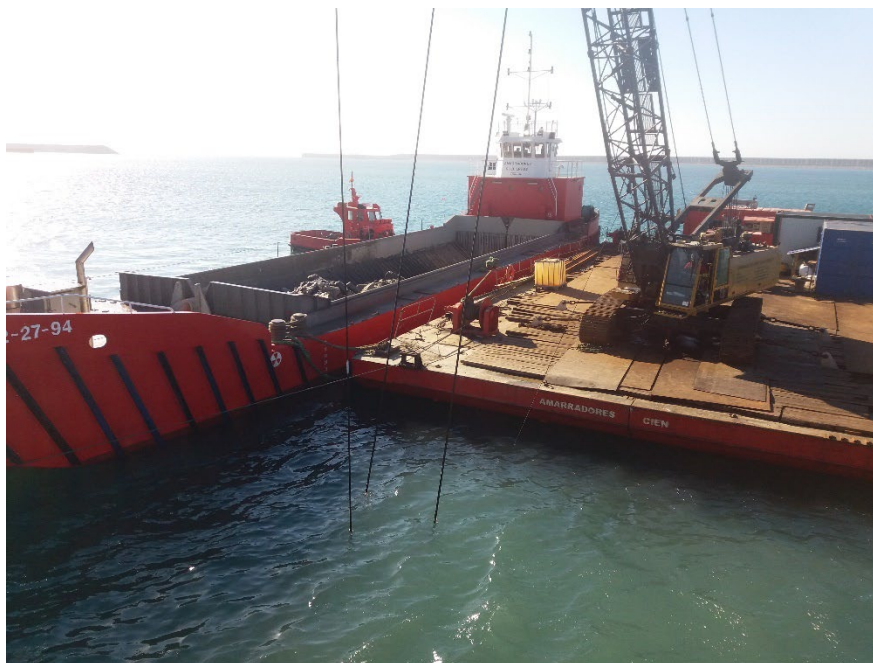
Figura 4. Grúa sobre pontona y gánguil para dragado o retirada de restos de demolición.
