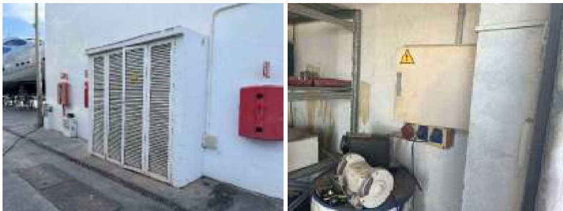
Figura 6. Red eléctrica nave industrial
