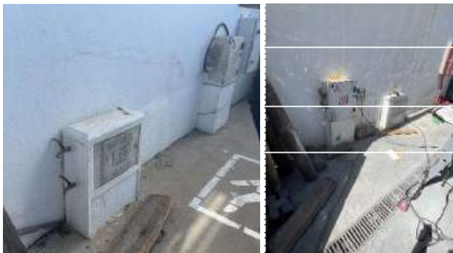
Figura 26. Estado de los armarios de suministro en la explanada
