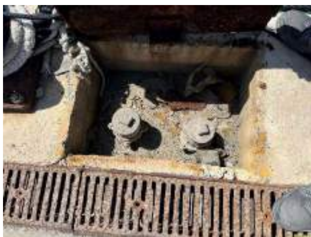
Figura 28. Bocas de descarga red de aguas negras y sucias barcos
