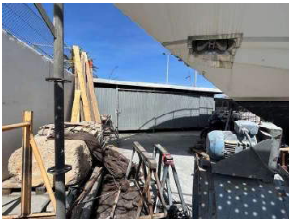
Figura 35. Almacén exterior desmontable
