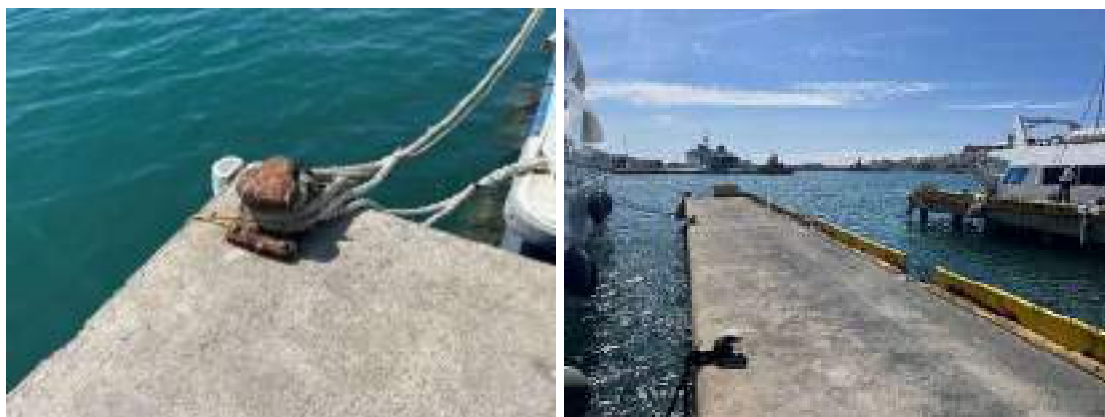
Figura 25. Elementos de amarre existentes
