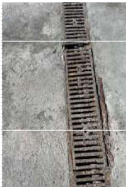
Figura 8. Estado de las canaletas de recogida de agua existentes en la explanada.
