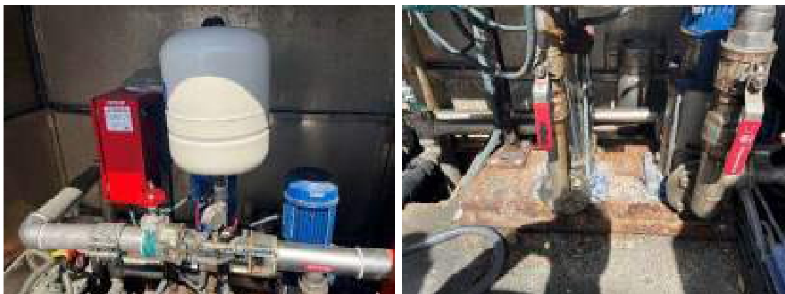
Figura 31. Equipo fijo de aspiración de agua salada
