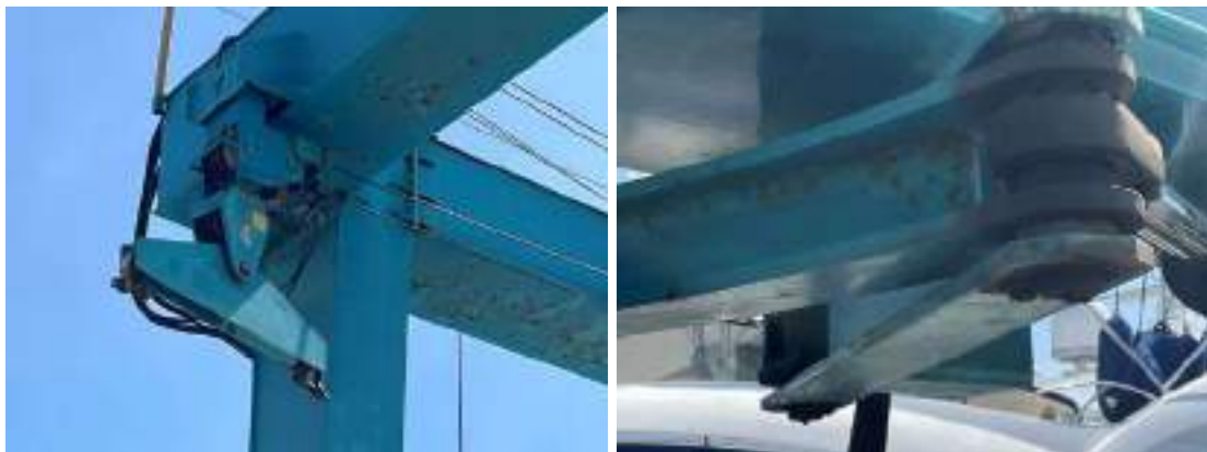
Figura 11. Estado actual del Travelift de 160Tn del Varadero de Eivissa
