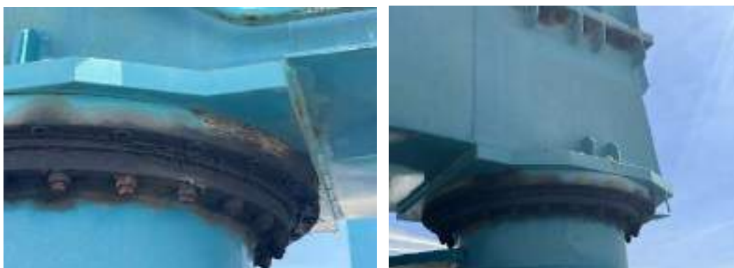
Figura 28. Muestras de oxidación en la estructura metálica del travelift.
