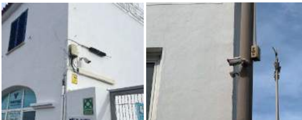
Figura 33. Sistema CCTV existente en la explanada de Varadero Eivissa
