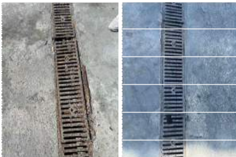
Figura 12. Estado actual de la red de recogida de agua superficial en la zona del varadero
