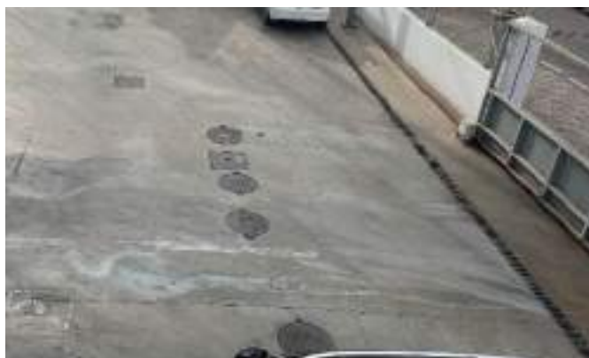
Figura 29. Tapas de registro equipos recogida de agua oleaginosas
