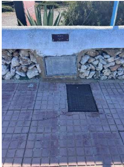
Figura 7. Acometida de agua en muro de vallado
