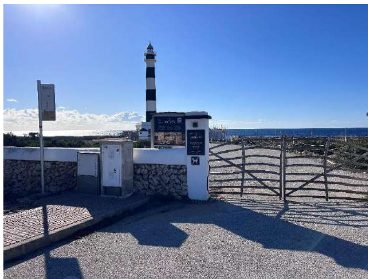
Figura 9. Entrada a parcela y CGP - suministro de electricidad
