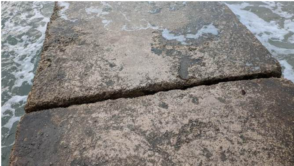
Ilustración 4: apertura de juntas entre losas
