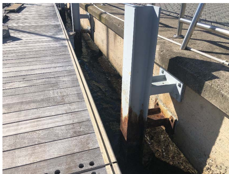
Imagen 3. Antes de la actuación. Viga sin rodillos y viga carril con un único rodillo
