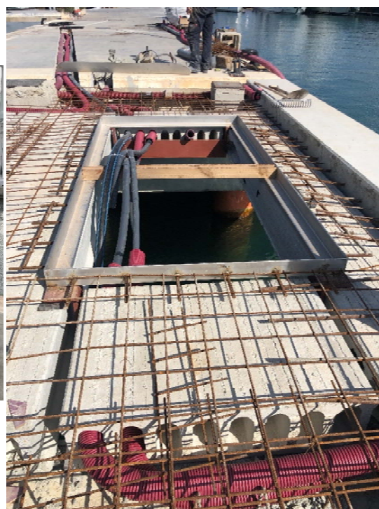
Imagen 13. Cubeto estanco instalado
