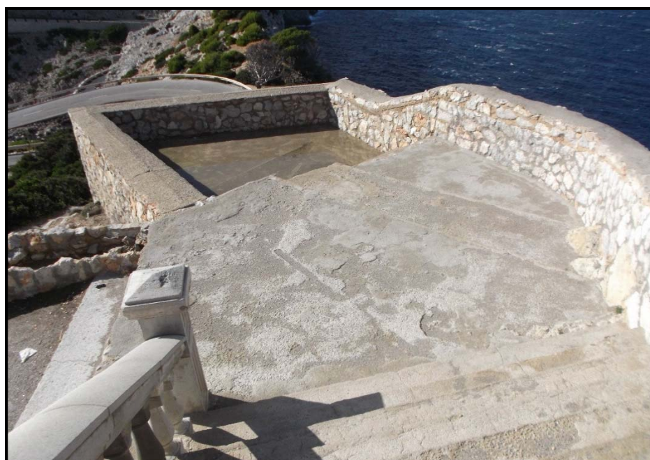
Imagen 10. Balcón con pavimento con acumulación de agua
