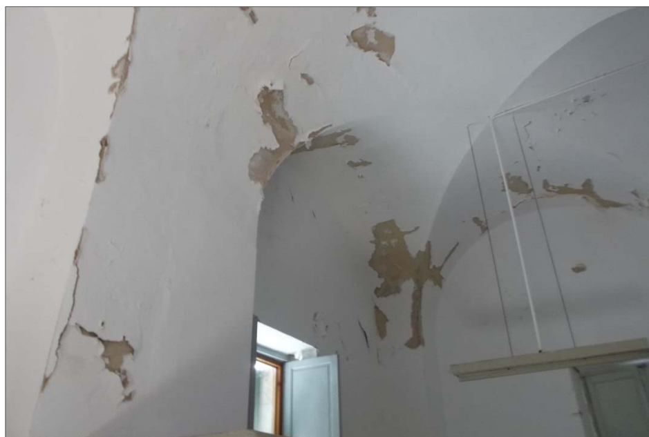
Imagen 8. Estado actual pintura sobre superficies interiores
