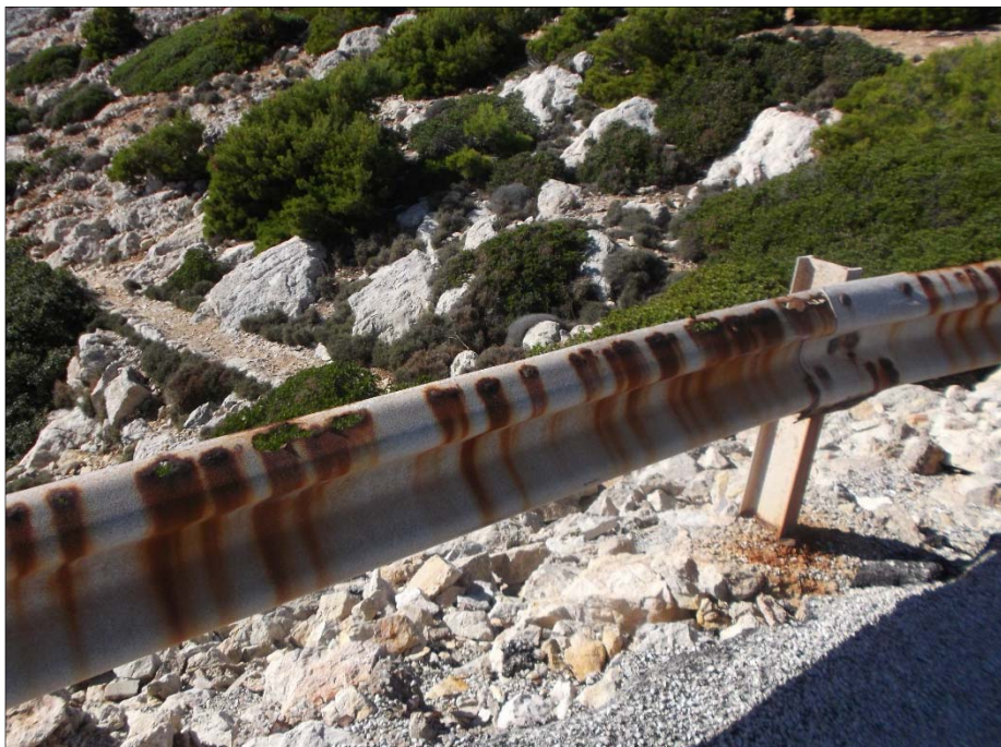
Imagen 1. Oxidación presente en guardarrailes de la carretera de acceso al faro
