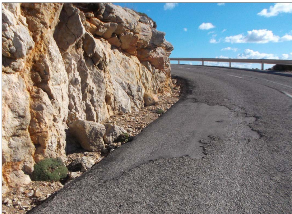
Imagen 5. Desgaste presente en el asfalto
