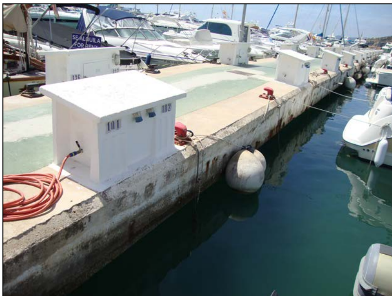
Figura 2. Armarios de Servicios
